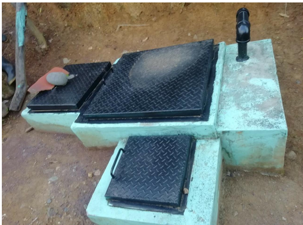
Ilustración 3: Vista de Rompe Presión Tipo VII
