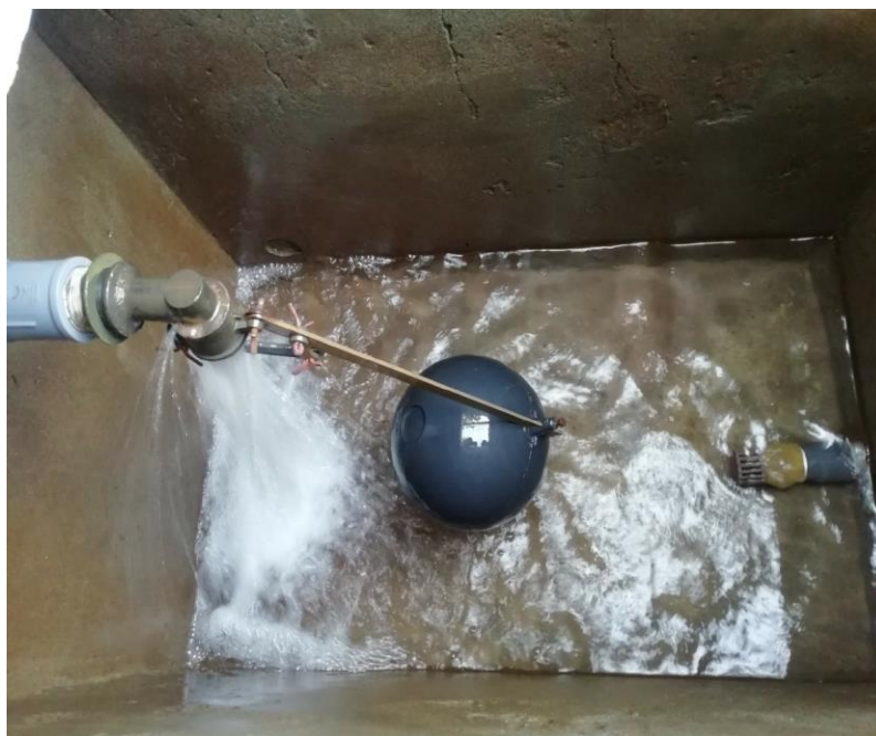
Ilustración 4: Vista de la Captación
