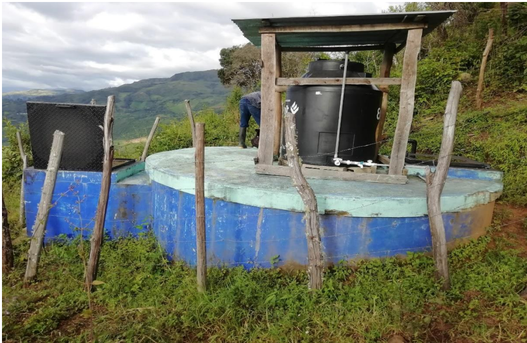
Ilustración 1: Vista de Reservorio
