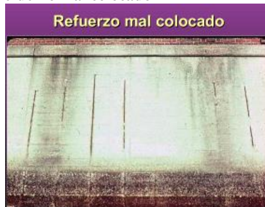
Gráfico N°27: Refuerzo mal colocado.
