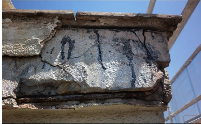
Gráfico N°24: Delaminación o Desprendimiento.
