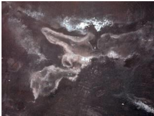
Gráfico N°18: Eflorescencia del concreto.
