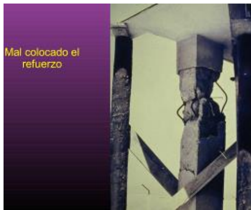
Gráfico N°25: Mal colocado el refuerzo.
