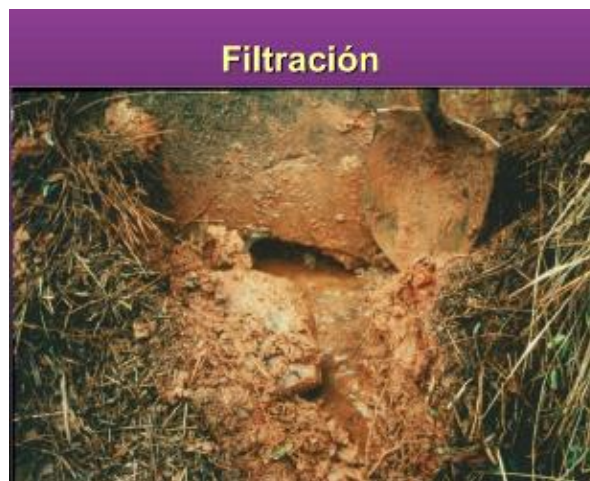
Gráfico N°21: Filtración en el concreto.
