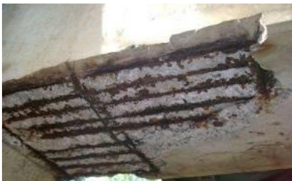
Gráfico N°12: Corrosión del acero.
