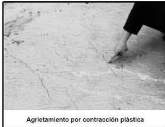
Gráfico N°02: Agrietamiento por retracción plástica
