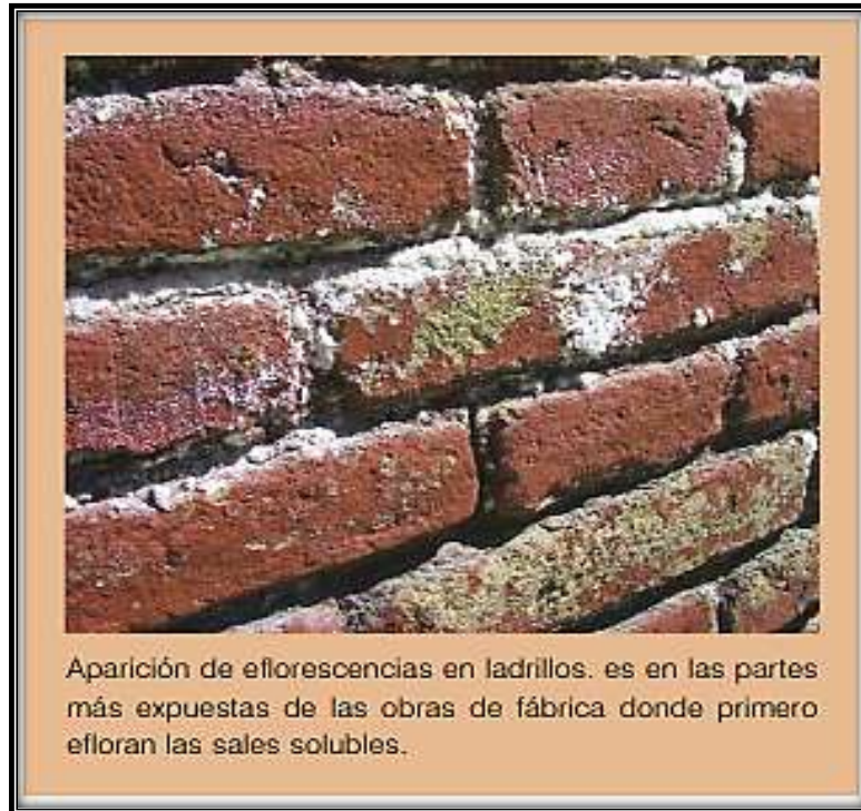
Imagen N° 20: Patología por Eflorescencia Fuente: Broto C. Carle (Enciclopedia Broto)
