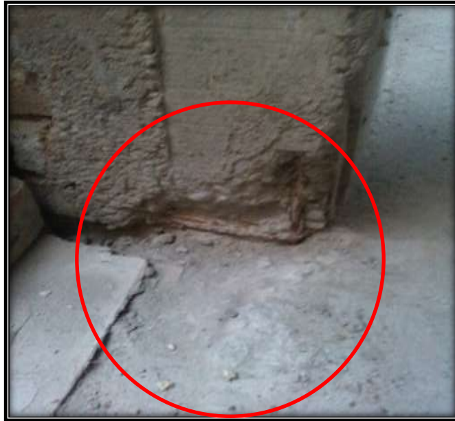
Imagen N° 30: vista de la columna con patología degradación y corrosión. Fuente: Elaboración propia.
