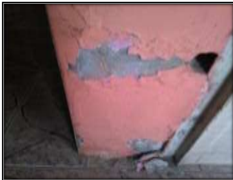
Imagen N° 27: vista de la columna con patología eflorescencia. Fuente: Elaboración propia.
