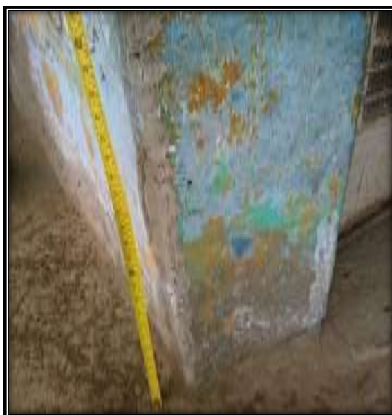
Imagen N° 34: vista de la columna con patología picadura y eflorescencia. Fuente: Elaboración propia.
