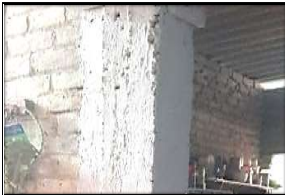
Imagen N° 36: vista de la columna con patología picadura y corrosión. Fuente: Elaboración propia.
