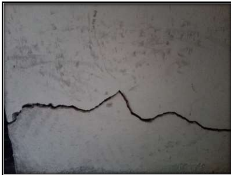
Imagen N° 17: Patología por Grieta. Fuente: Elaboración propia.
