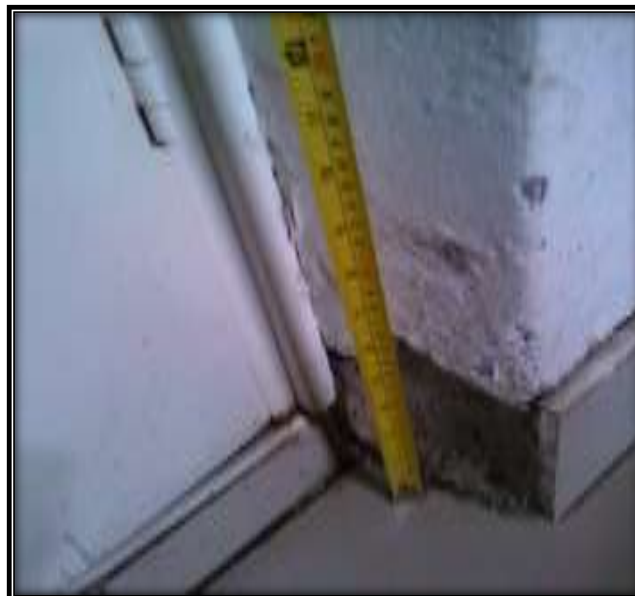
Imagen N°32: vista de la columna con patología eflorescencia. Fuente: Elaboración propia.
