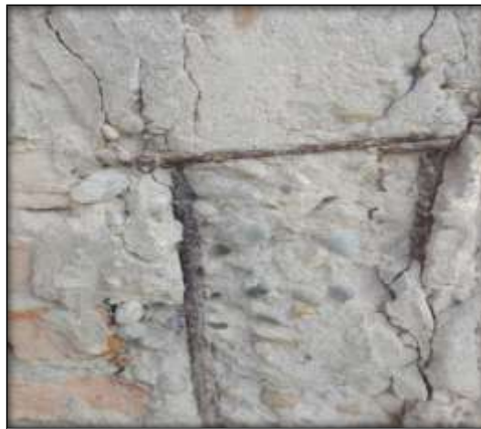
Imagen N° 21: Patología Picadura y Corrosión en las viviendas Mz. "A" Lt. 01. Fuente: Elaboración propia.
