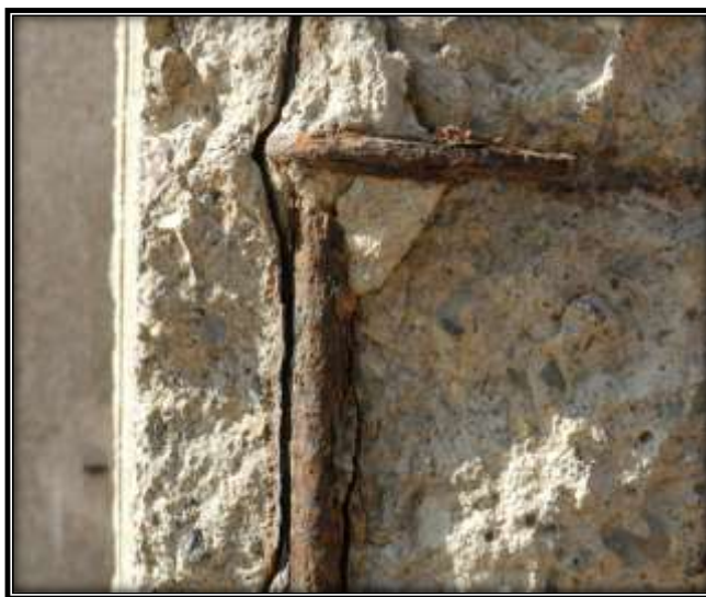
Imagen N° 19: Patología por Oxidación. Fuente: Alario C. Enrique.
