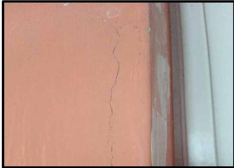
Imagen N° 16: Patología por Fisura. Fuente: Elaboración propia.
