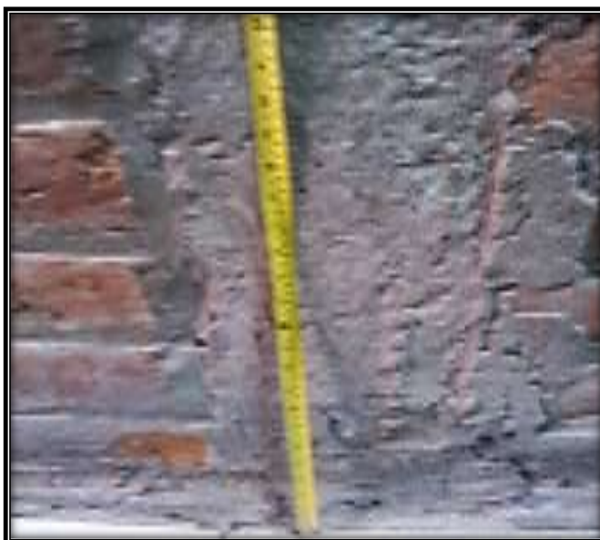
Imagen N° 25: vista de la columna con patología picadura o cavitación. Fuente: Elaboración propia.
