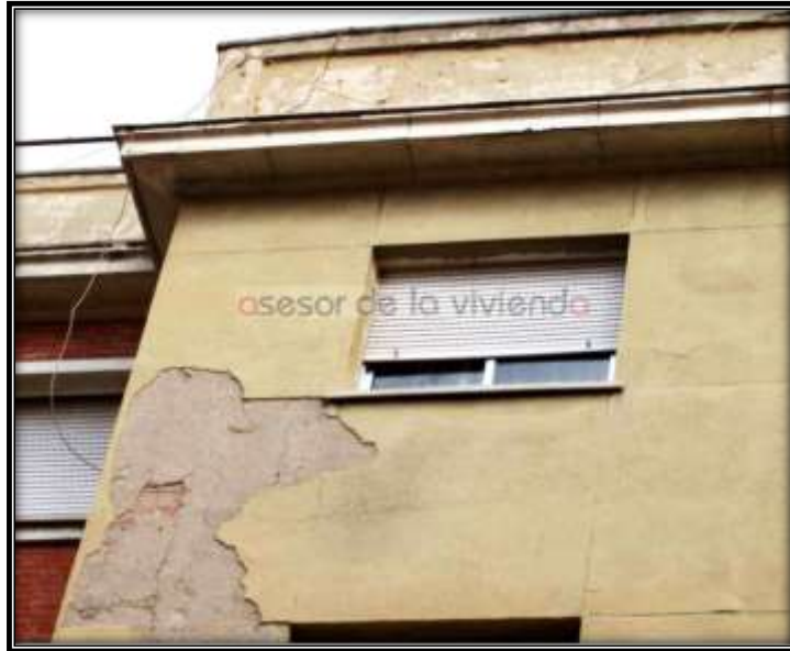
Imagen N° 18: Patología por Descascaramiento. Fuente: Palmeiro Ada (Asesor de la vivienda).
