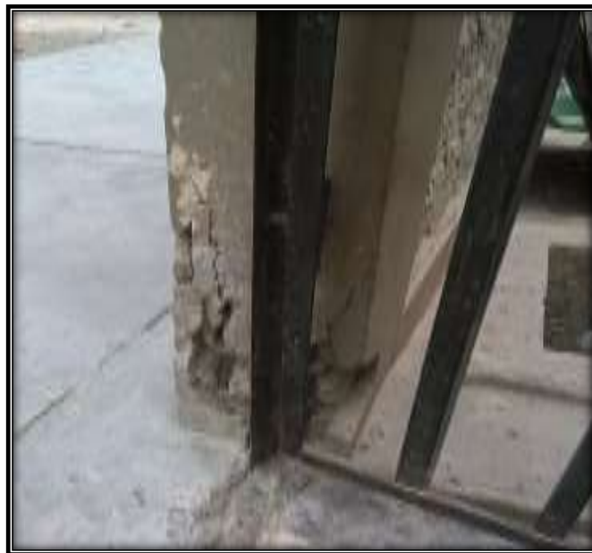
Imagen N° 29: Columna exterior con patología de degradación y corrosión. Fuente: Elaboración propia.
