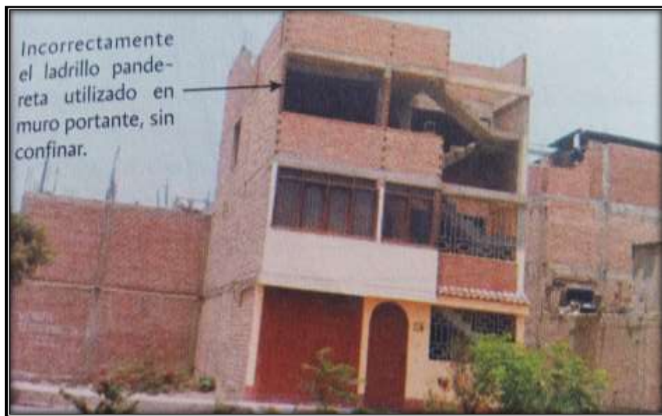
Imagen N° 4: Utilización incorrecta del ladrillo pandereta. Fuente: Abanto C. Tomas.
