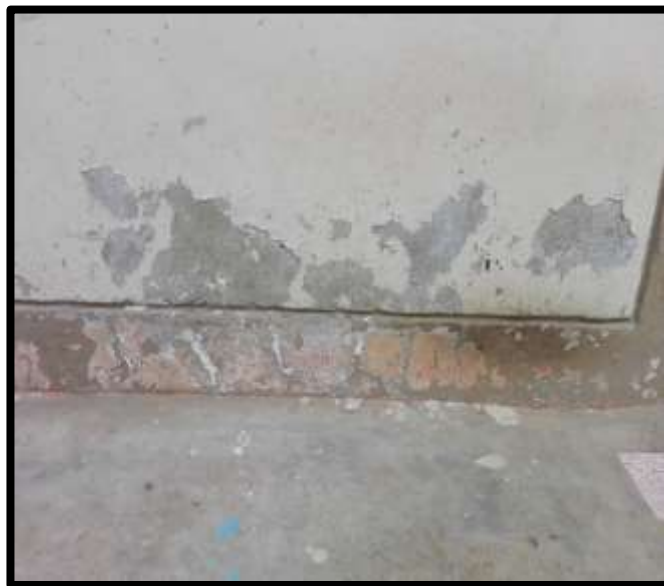
Imagen N° 14: Patología por Humedad. Fuente: Elaboracion Propia.
