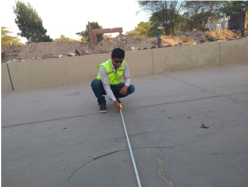
Gráfico 183. Medición de la longitud de una grieta en la losa de fondo.
