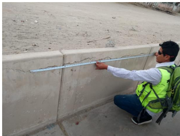
Gráfico 12. Grieta en estructura de concreto.
