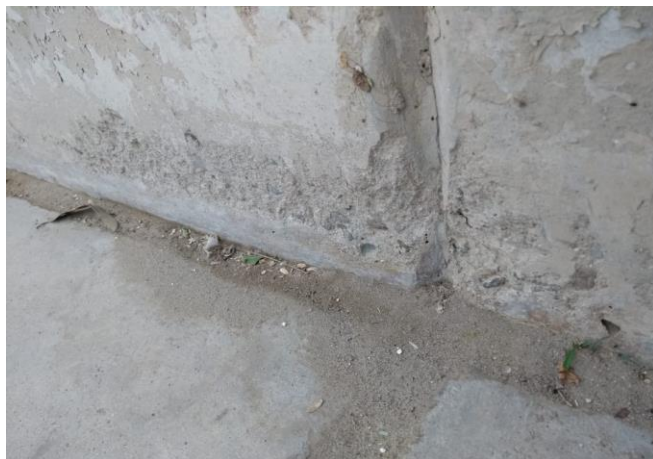
Gráfico 8. Erosión en pared de dren.
