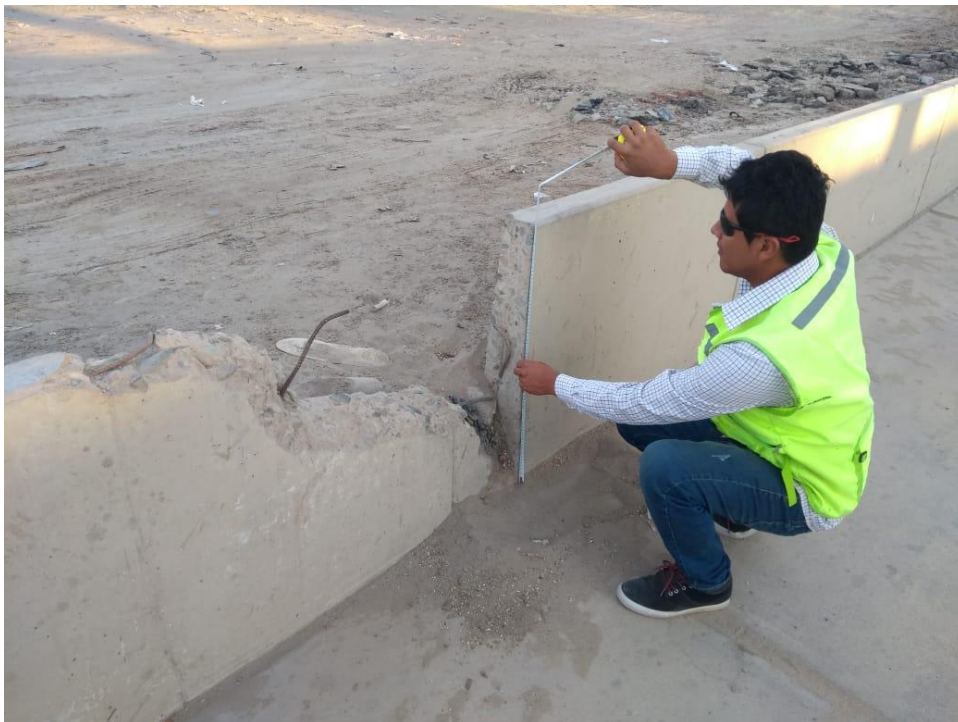
Gráfico 188. Desprendimiento del concreto en el muro del dren.
