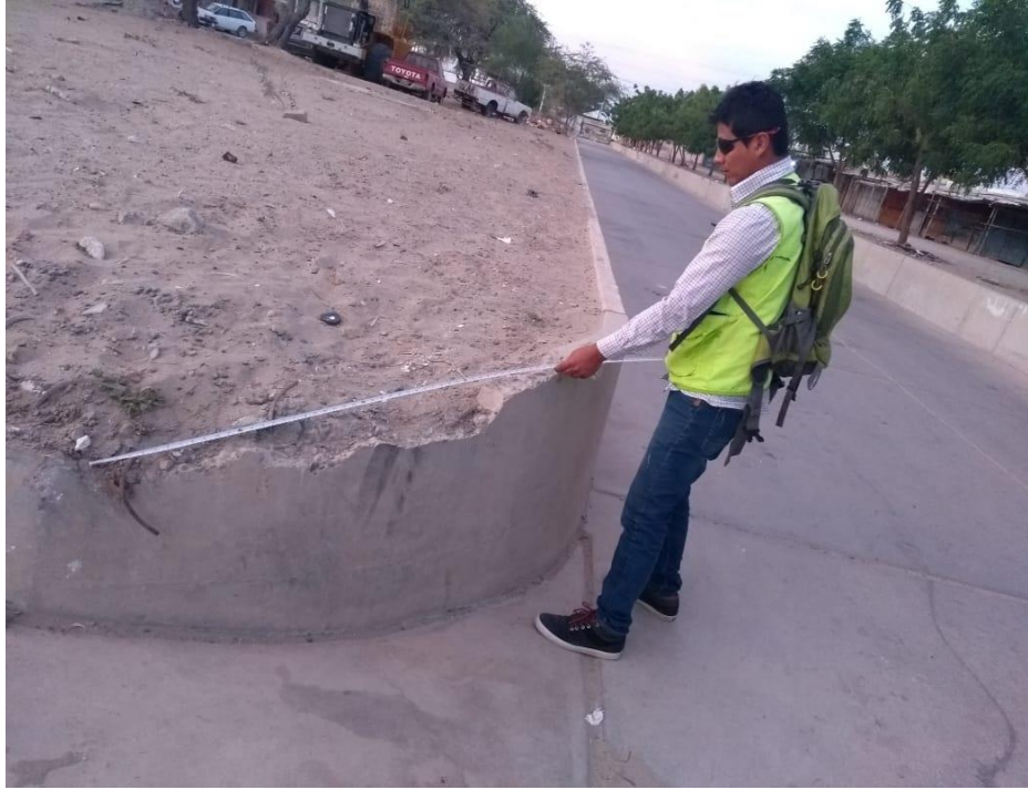
Gráfico 185. Desprendimiento en la parte superior del muro del dren.
