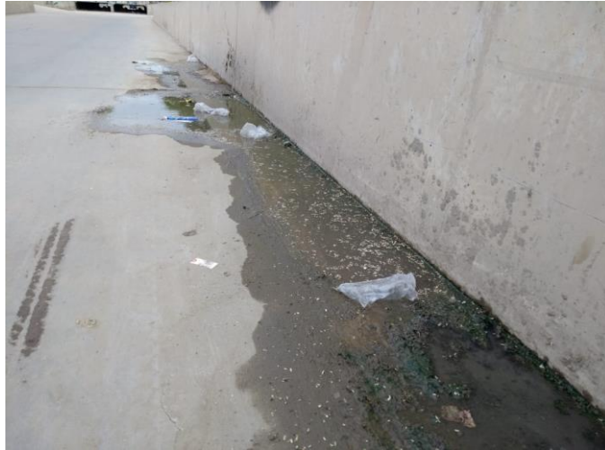
Gráfico 7. Humedad en losa de dren.
