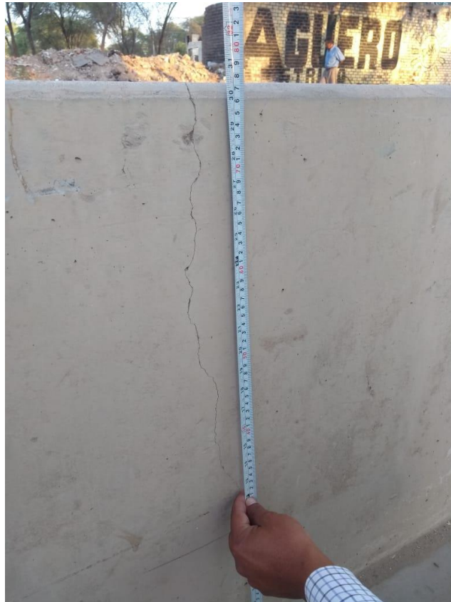
Gráfico 11. Fisuración en losa lateral de dren.
