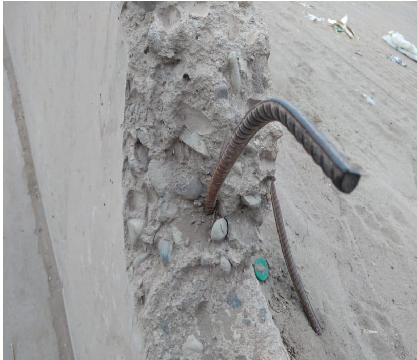
Gráfico 14. Oxidación del acero de refuerzo.
