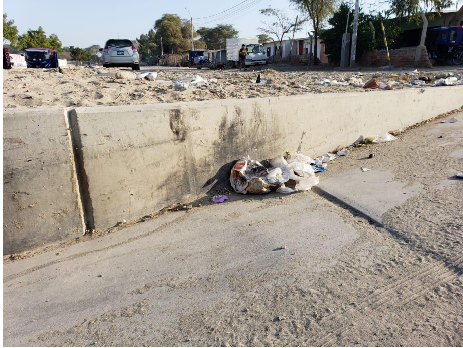
Gráfico 189. Suciedad en el muro del dren de concreto.
