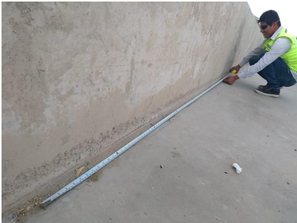
Gráfico 182. Presencia de erosión en la parte inferior de la pared del dren.
