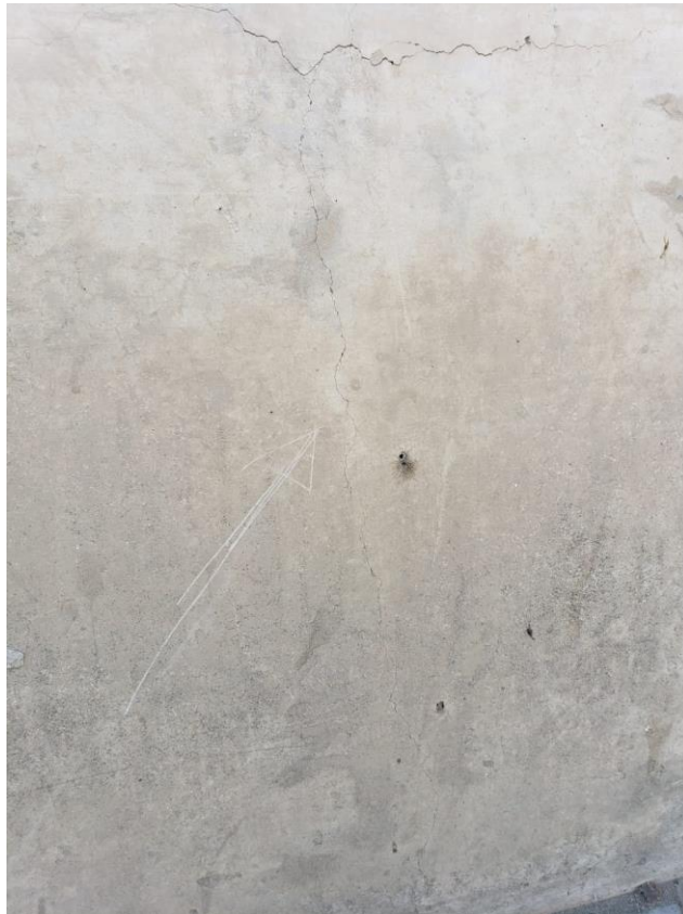
Gráfico 184. Fisura en la pared o muro lateral del dren.
