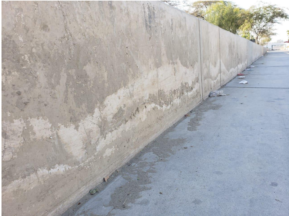
Gráfico 186. Presencia de eflorescencia en la parte inferior del muro.
