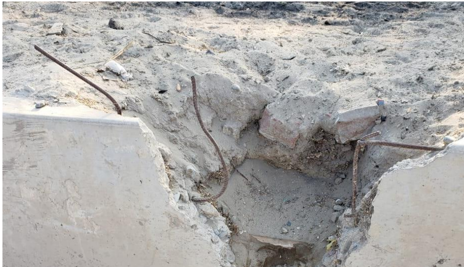
Gráfico 190. Oxidación del acero de refuerzo en el muro del dren.
