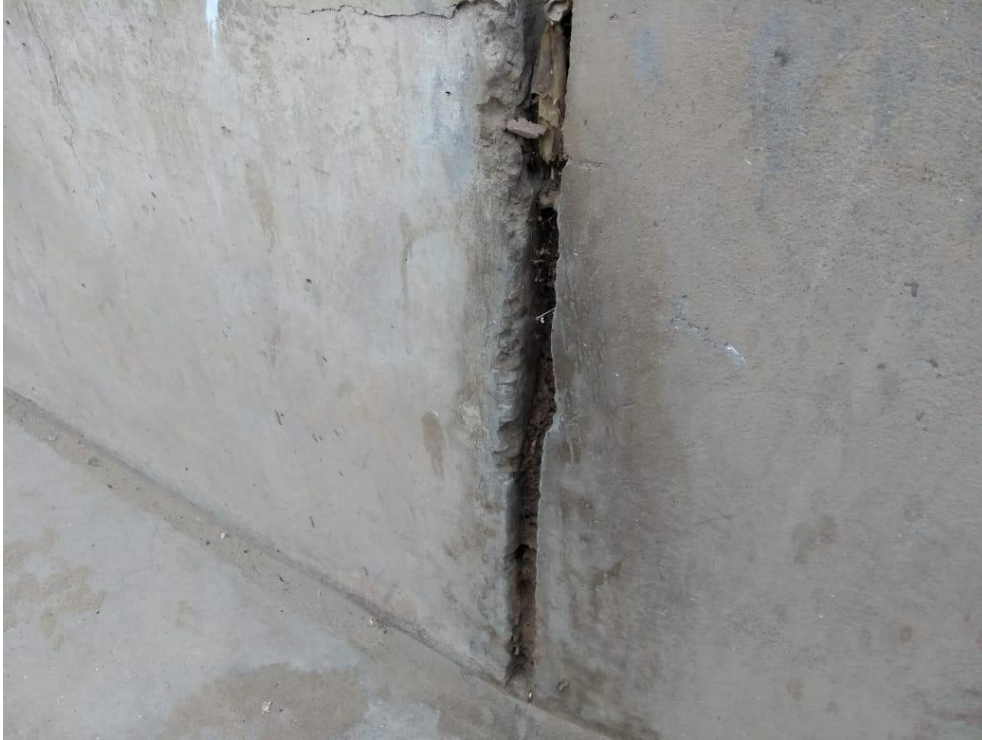
Gráfico 187. Presencia de humedad en el muro del dren.
