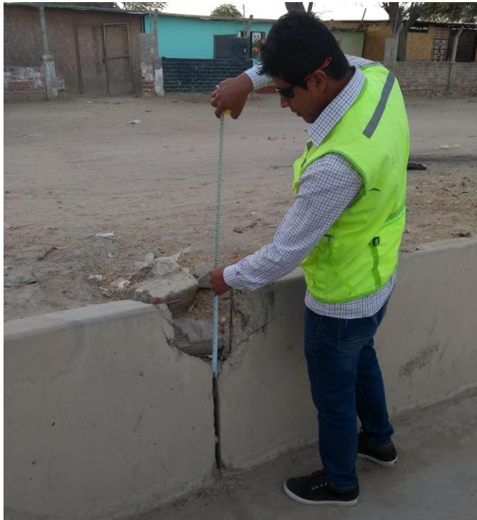
Gráfico 10. Desprendimiento de concreto.
