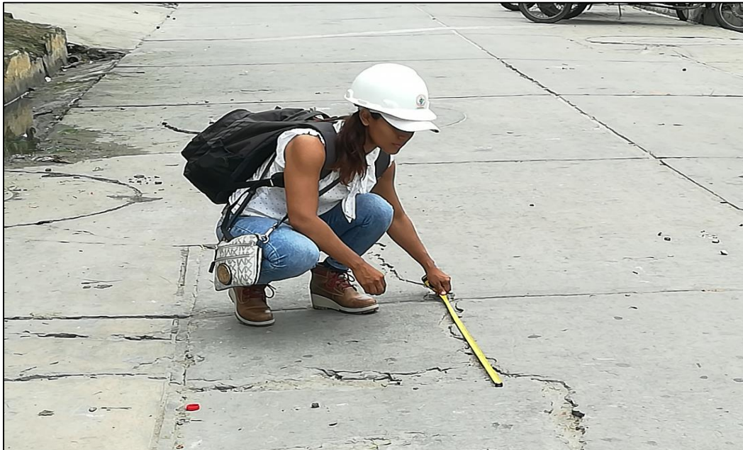
Figura 135 Calle buenos Aires entre (Ca. Chuquipiondo con Av. 28 de julio) cuadra 5. Se observa el daño de Grieta Lineal de severidad Medio Bajo.
