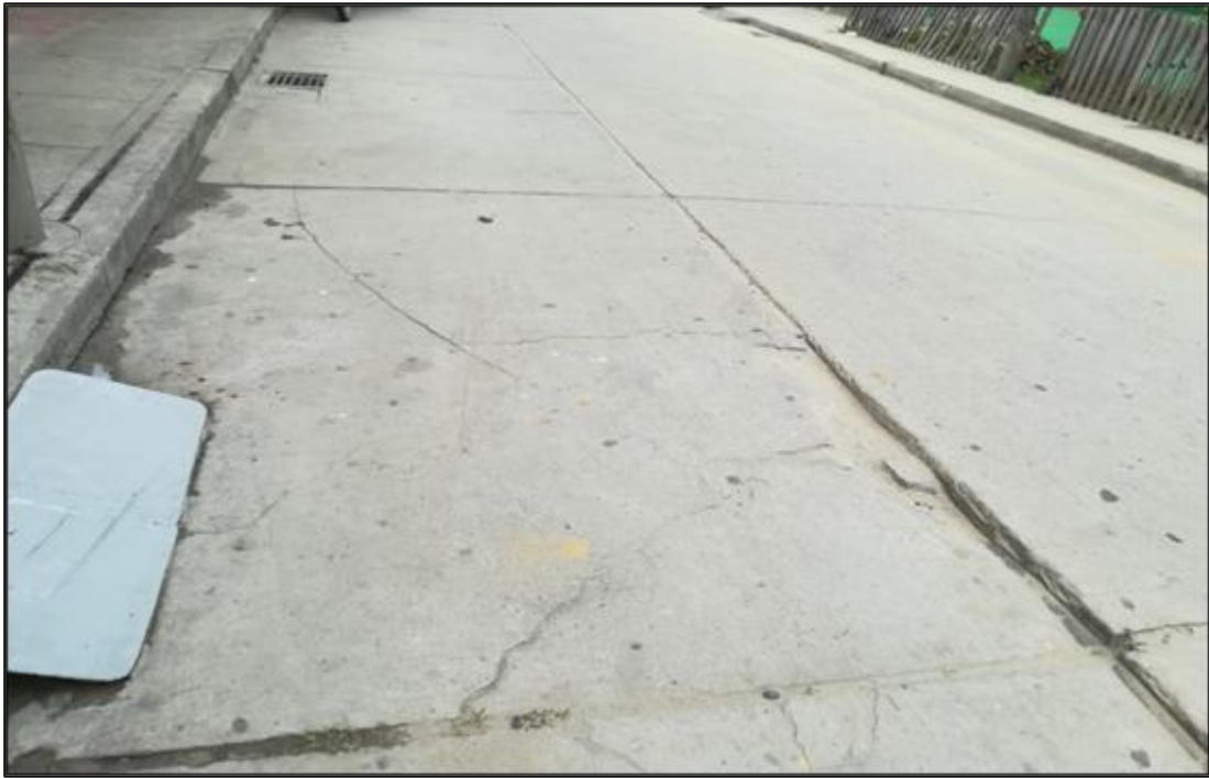
Figura 116 Calle buenos Aires entre (Ca. 03 de junio y Ca. Conquistadores) cuadra 1. Se observa el daño de la Losa Dividida de severidad Media.
