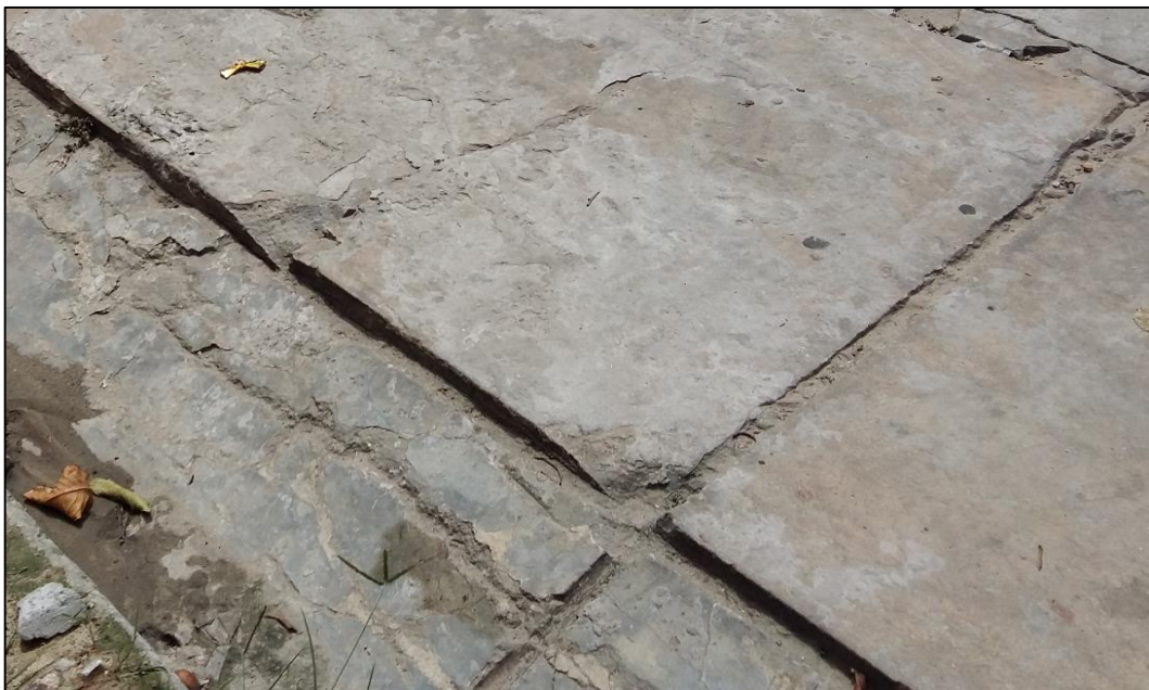
Figura 136 Calle buenos Aires entre (Ca. Chuquipiondo con Av. 28 de julio) cuadra 5. Se observa el daño de descascaramiento de esquina de severidad Medio.
