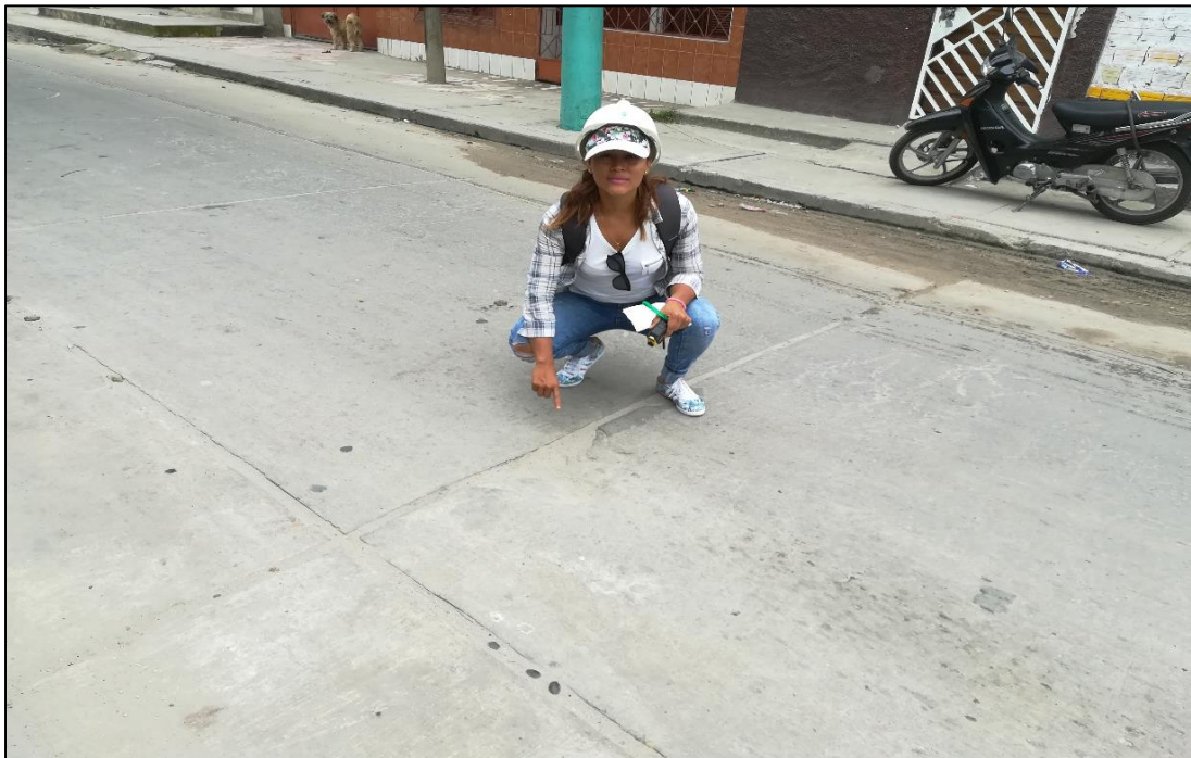
Figura 121 Calle buenos Aires entre (Ca. Conquistadores con Ca. Rosa Merino) cuadra 2. Se observa el daño de descascaramiento de junta de severidad Bajo.
