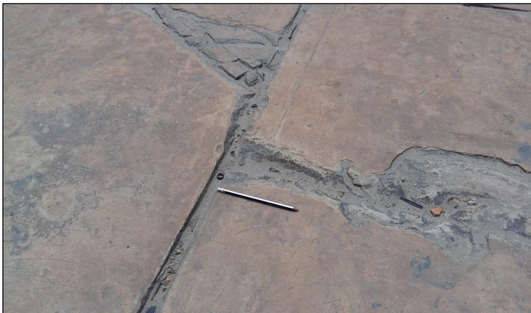
Figura 126 Calle buenos Aires entre (Ca. Conquistadores con Ca. Rosa Merino) cuadra 2. Se observa el daño de descascaramiento de esquina de severidad Medio.
