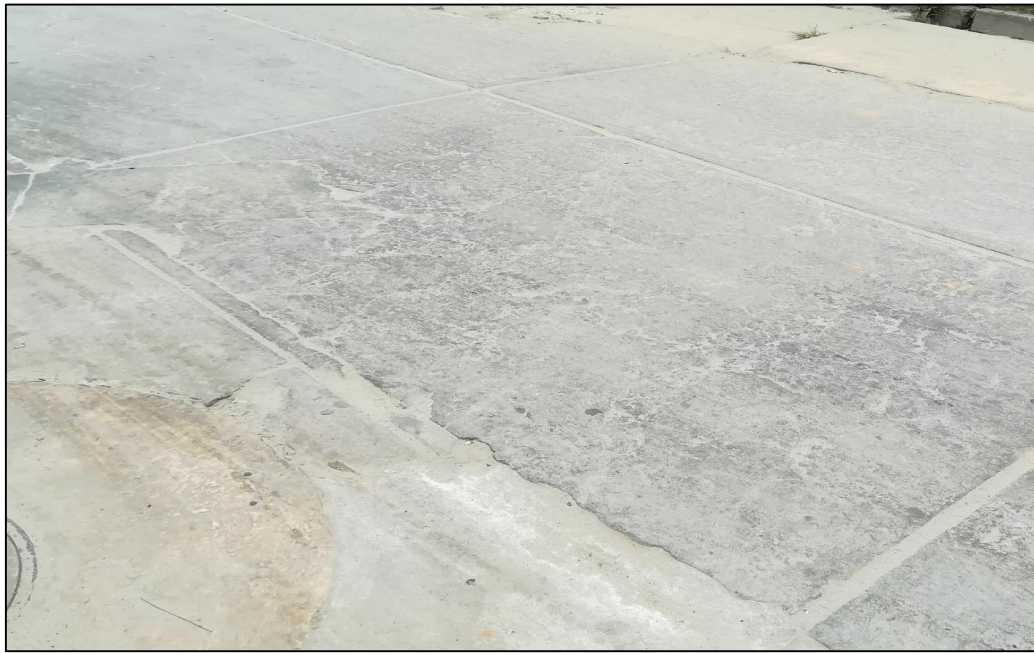
Figura 133 Calle buenos Aires entre (Ca. Chuquipiondo con Av. 28 de Julio) cuadra 5. Se observa el daño de descascaramiento de junta de severidad Alto.
