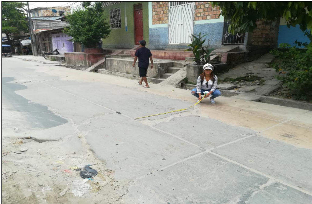
Figura 119 Calle buenos Aires entre (Ca. Conquistadores con Ca. Rosa Merino) cuadra 2. Se observa el daño de Losa Dividida de severidad Alto.
