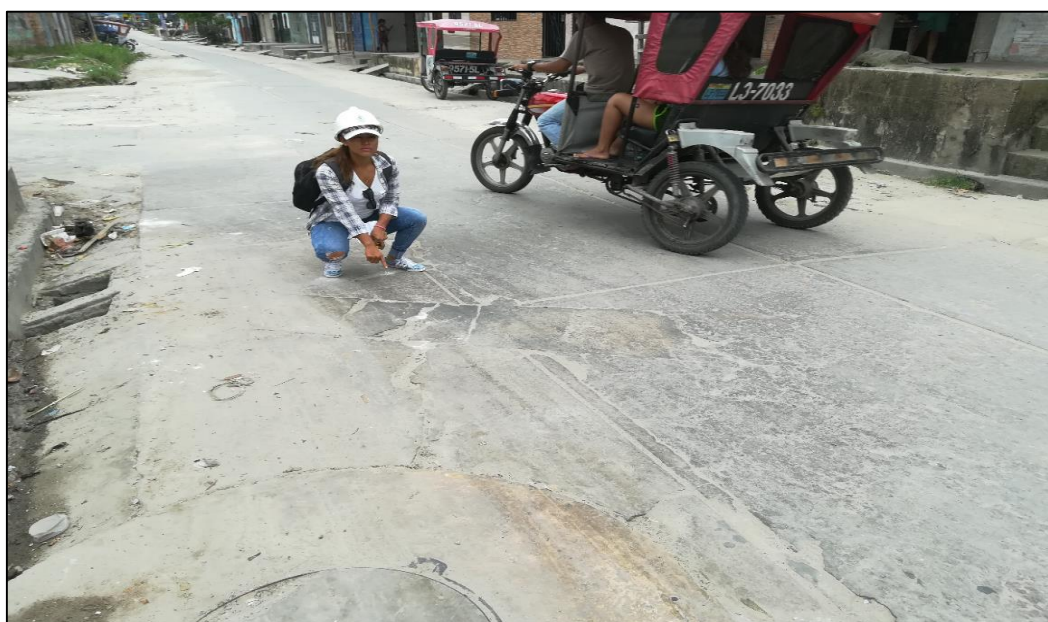
Figura 129 Calle buenos Aires entre (Ca. Conquistadores con Ca. Chuquipiondo) cuadra 4. Se observa el daño de Parcheo de severidad Bajo.
