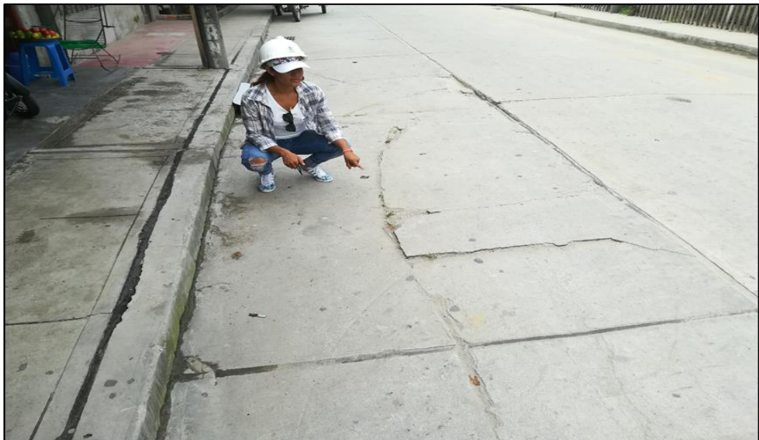
Figura 117 Calle buenos Aires entre (Ca. 03 de junio y Ca. Conquistadores) cuadra 1. Se observa el daño de la losa dividida de severidad Alta.
