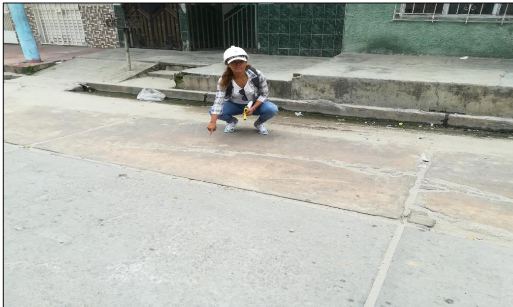
Figura 128 Calle buenos Aires entre (Ca. Conquistadores con Ca. Chuquipiondo) cuadra 4. Se observa el daño de Grieta Lineal de severidad Medio.
