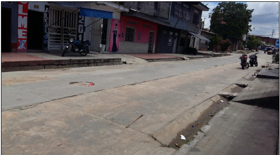
Figura 124 Calle buenos Aires entre (Ca. Rosa Merino con Ca. Pantoja) cuadra 3. Se observa el daño de Grieta Lineal de severidad Bajo.
