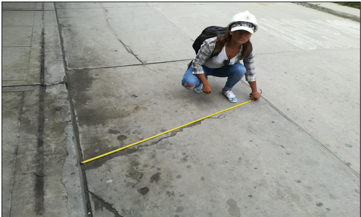
Figura 113. Calle buenos Aires entre (Ca. 03 de junio y Ca. Conquistadores) cuadra 1. Se observa el daño de la grieta lineal de severidad media.
