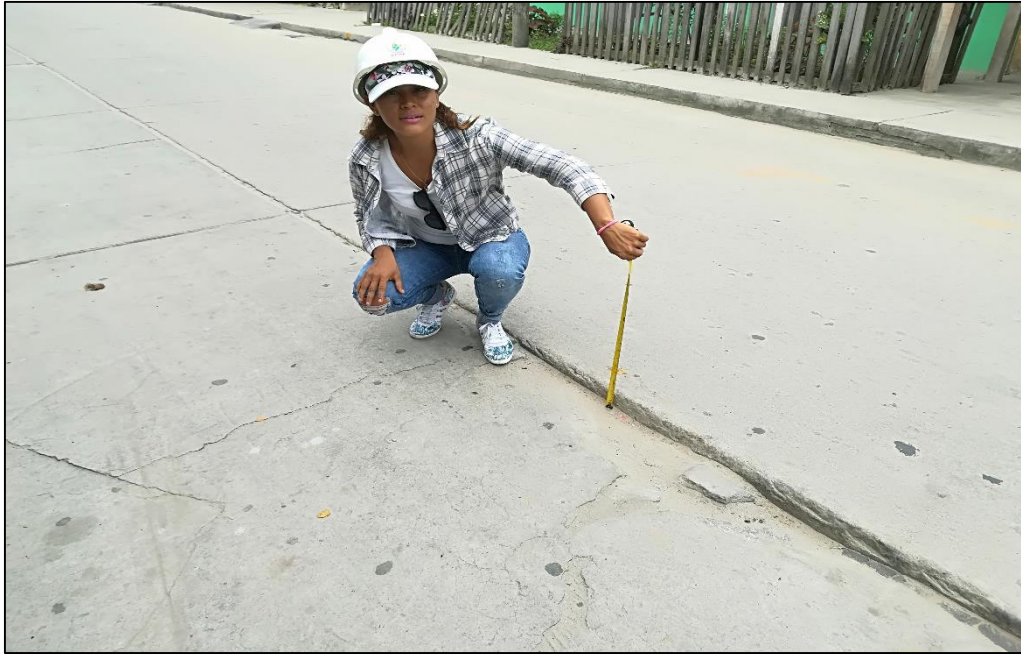
Figura 118. Calle buenos Aires entre (Ca. Conquistadores con Ca. Rosa Merino) cuadra 2. Se observa el daño de Escala de severidad Medio de 12 mm.
