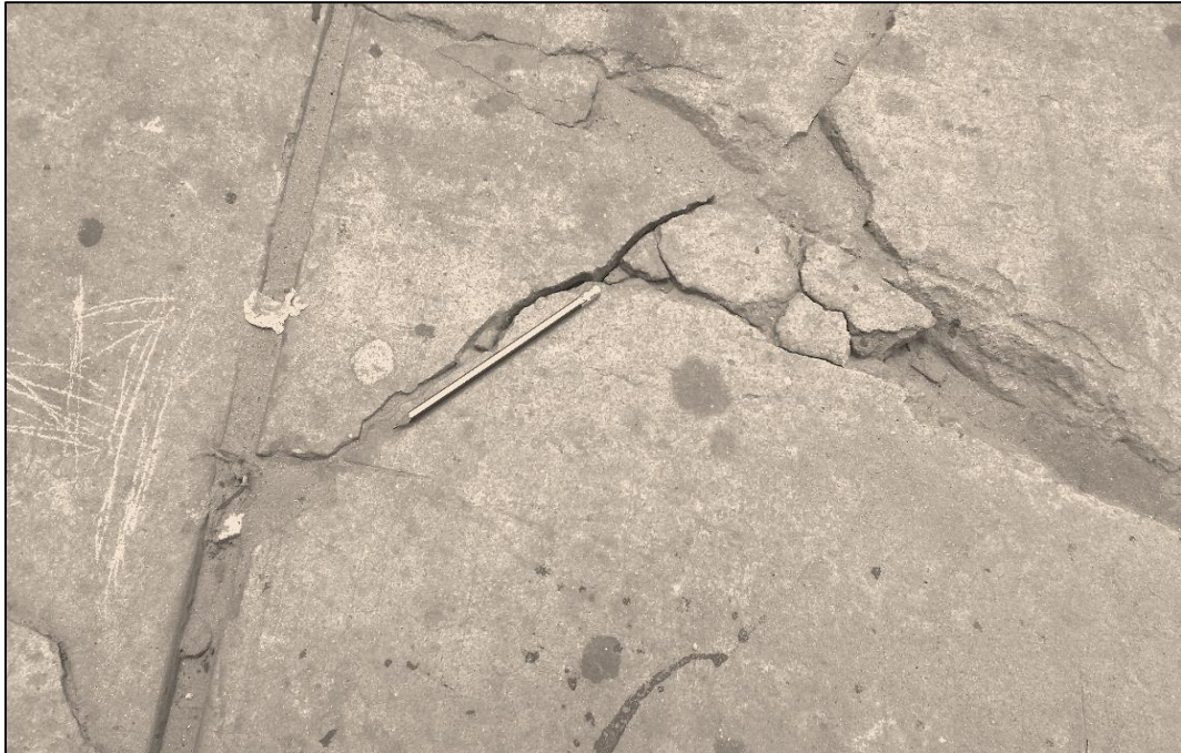
Figura 137 Calle buenos Aires entre (Ca. Chuquipiondo con Av. 28 de julio) cuadra 5. Se observa el daño de Grieta de Esquina de severidad Medio.
