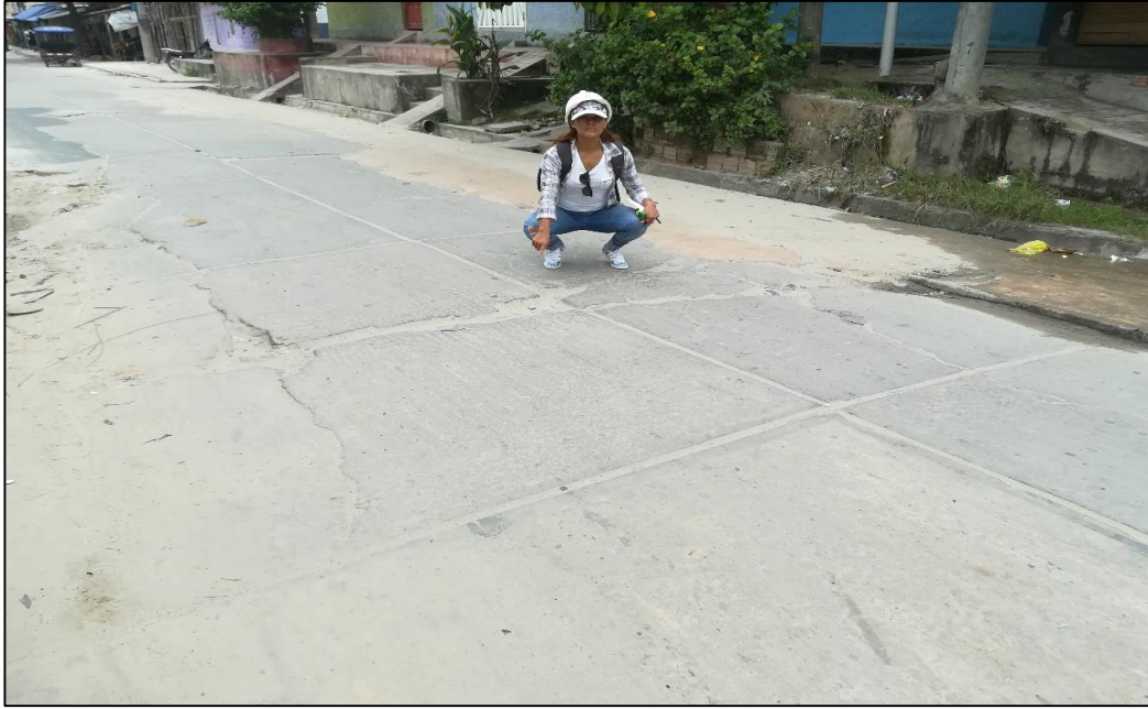
Figura 132 Calle buenos Aires entre (Ca. Rosa Merino con Ca. Chuquipiondo) cuadra 4. Se observa el daño de losa Dividida de severidad Alto.
