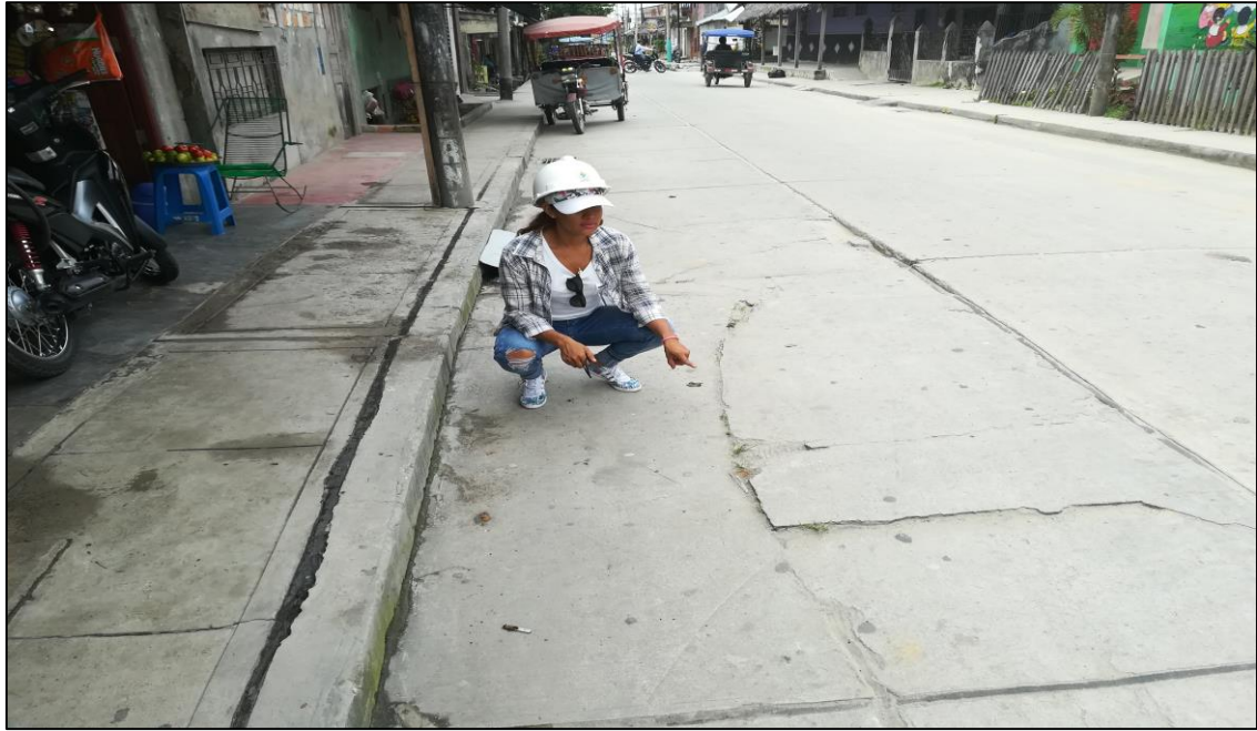
Figura 114. Calle buenos Aires entre (Ca. 03 de junio y Ca. Conquistadores) cuadra 1. Se observa el daño de la grieta lineal de severidad Alta.
