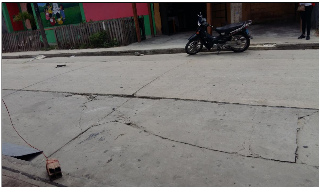
Figura 130 Calle buenos Aires entre (Ca. Conquistadores con Ca. Chuquipiondo) cuadra 4. Se observa el daño de Grieta Lineal severidad Medio.
