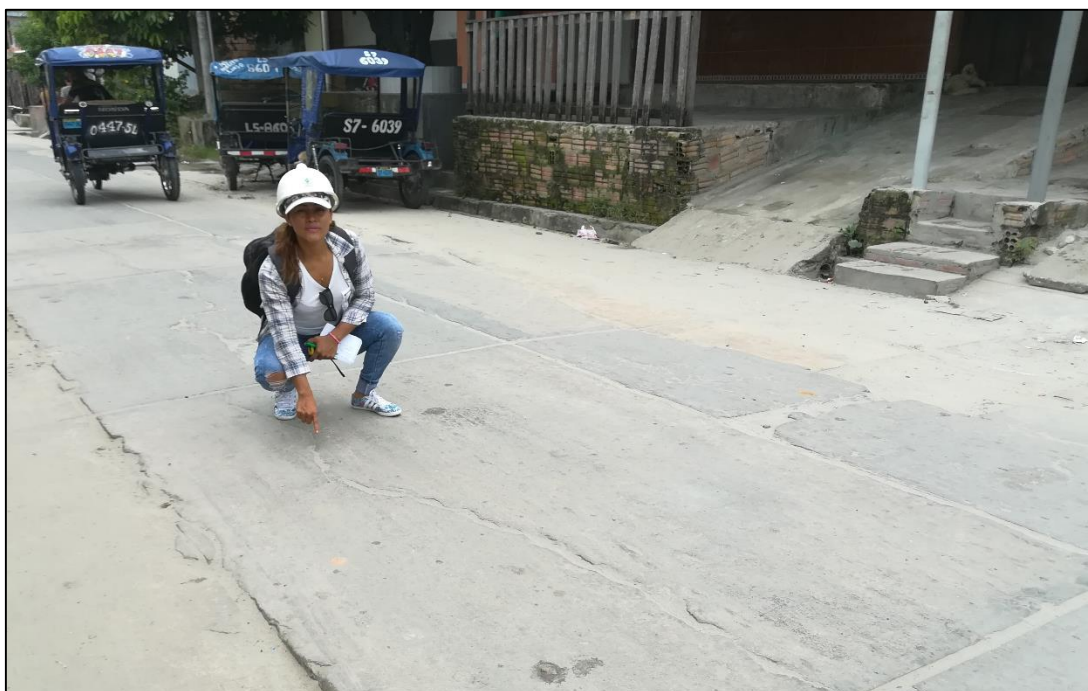
Figura 125 Calle buenos Aires entre (Ca. Rosa Merino con Ca. Pantoja) cuadra 3. Se observa el daño de Grieta Lineal de severidad Medio.
