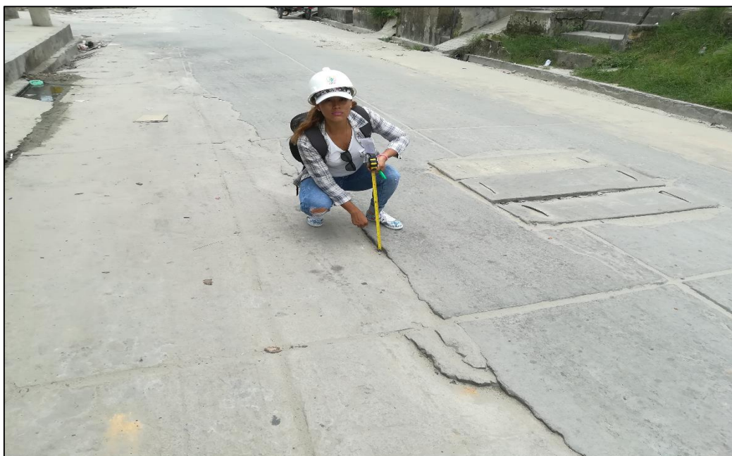
Figura 131 Calle buenos Aires entre (Ca. Rosa Merino con Ca. Chuquipiondo) cuadra 4. Se observa el daño de Escala de severidad Medio de 10 mm.
