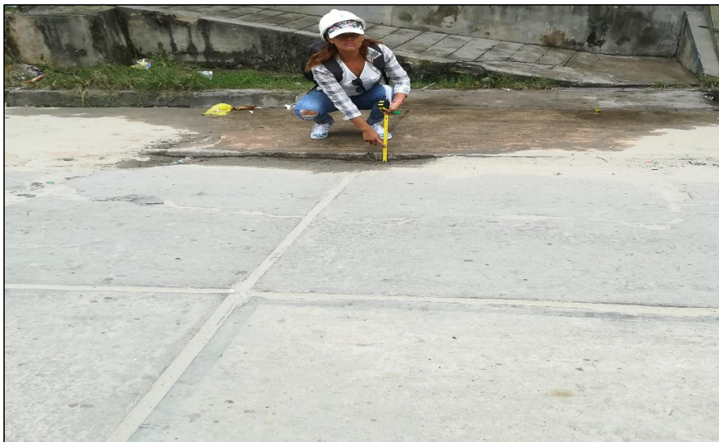
Figura 134 Calle buenos Aires entre (Ca. Chuquipiondo con Av. 28 de julio) cuadra 5. Se observa el daño de Escala de severidad Medio de 12 mm.
