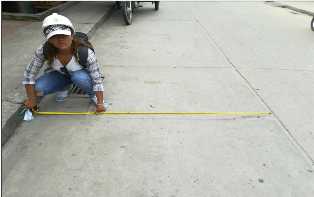
Figura 120 Calle buenos Aires entre (Ca. Conquistadores con Ca. Rosa Merino) cuadra 2. Se observa el daño de Grieta Lineal de severidad Medio.
