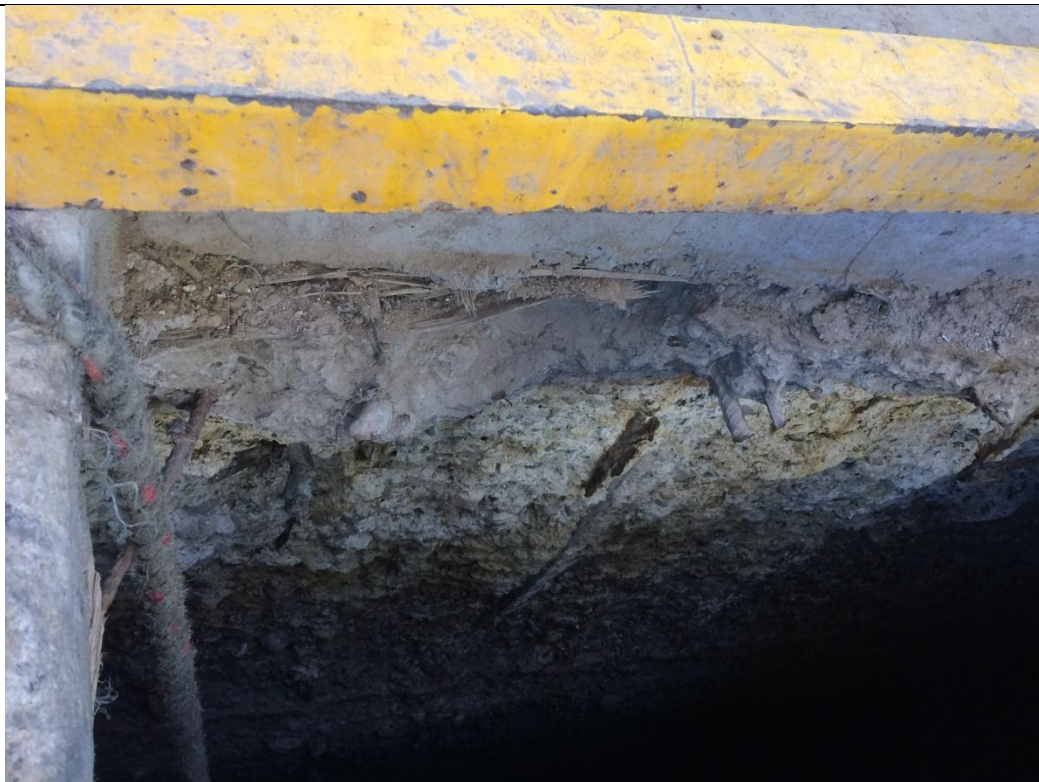
Verificación del Grado de Corrosión del Concreto interior de la Cámara de Bombeo N°2 - Mancora
