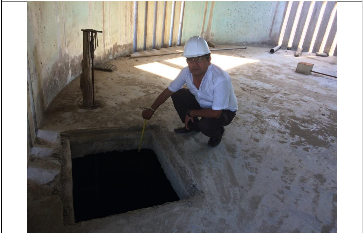
Verificación del espesor de la Losa de Concreto de la Cámara de Bombeo N°1 de Negritos
