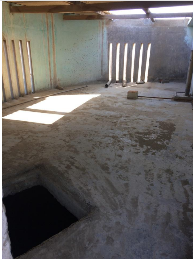
Vista de la losa de concreto de la Cámara de Bombeo de Aguas servidas N°2 de Negritos
