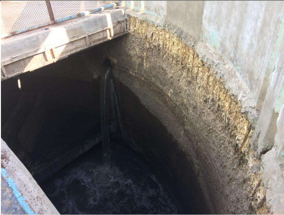
Verificación del grado de corrosión del Concreto en la Cámara de Bombeo N°3 de Negritos
