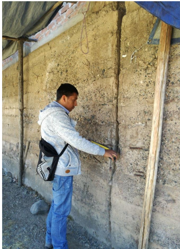
Imagen N° 13: patología de erosión en Sobrecimiento.
