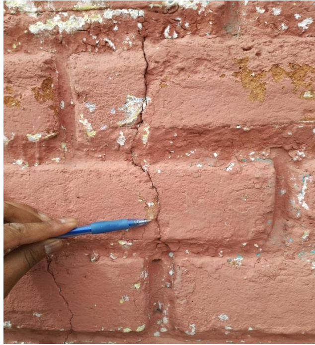
Imagen N° 14: patología de grieta en muro.
