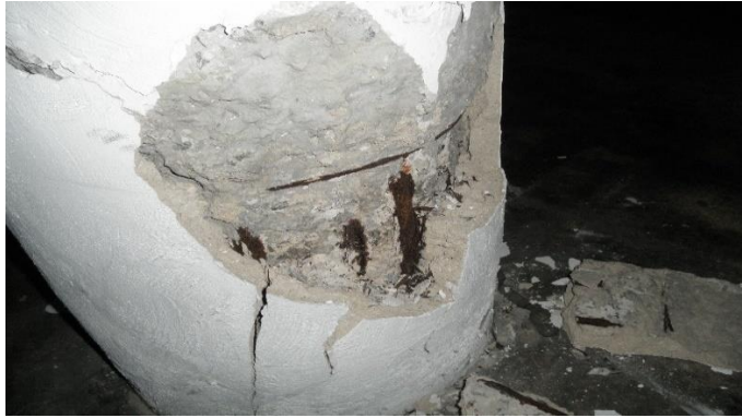
Imagen 01. Oxidación y Corrosión
