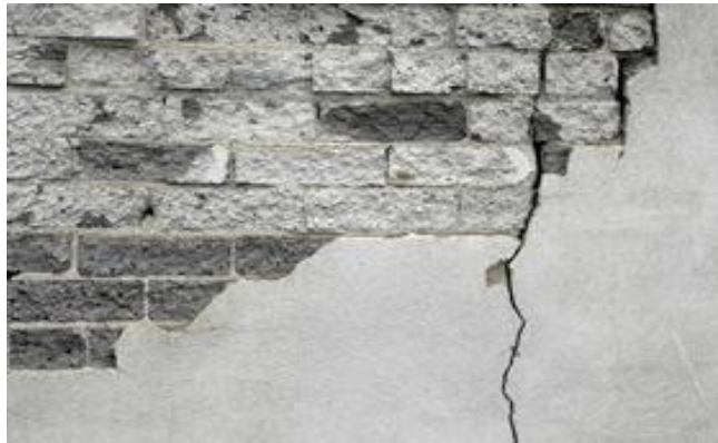
Imagen 08. Grieta de muros
