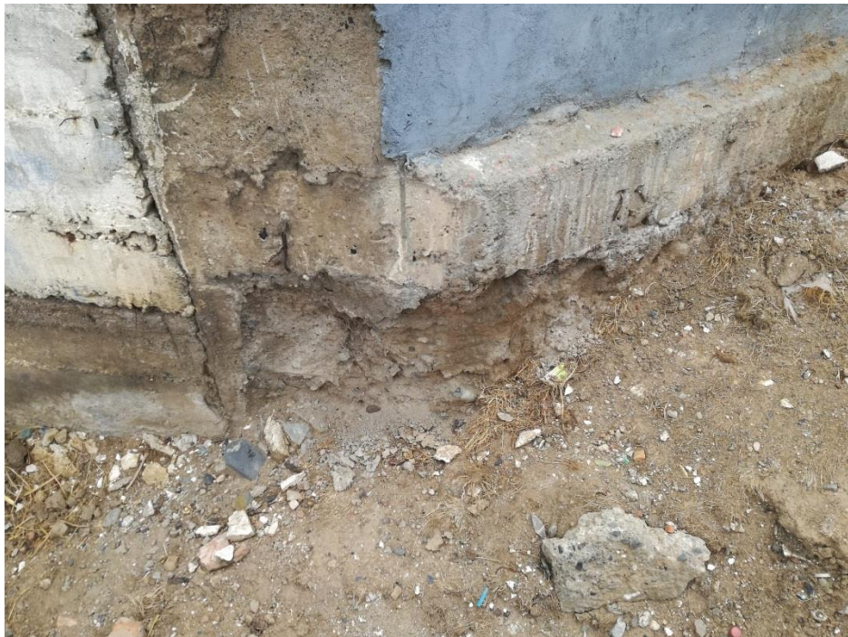
Imagen N° 15: patología de erosión en Sobrecimiento.
