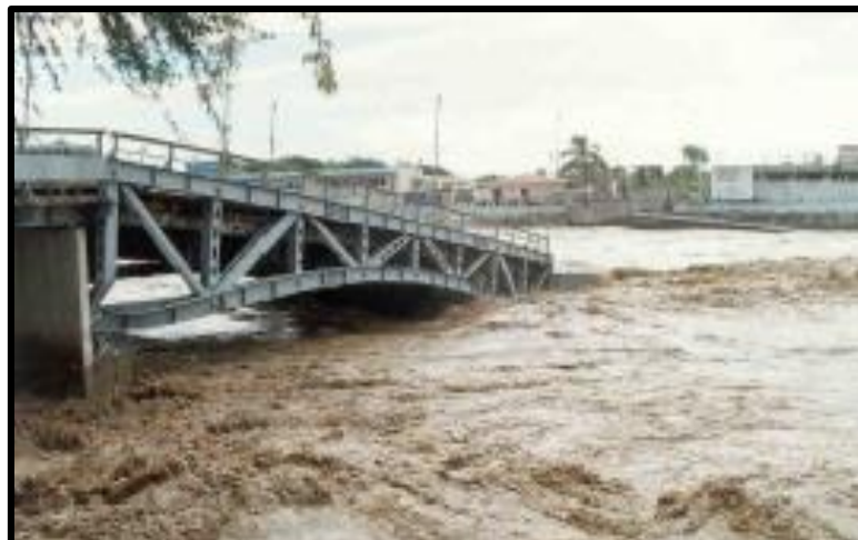
Fig. 02 Vista del Puente Viejo colapsado
