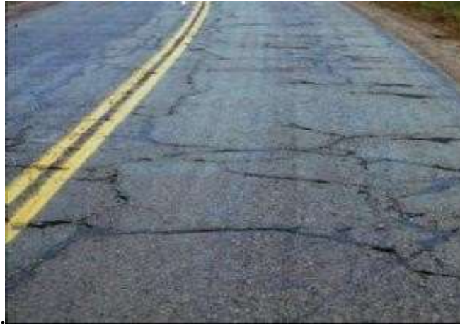
Figura 11: Fisuras en bloque
