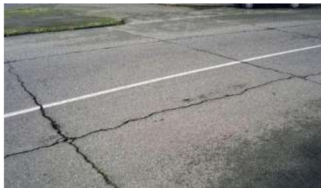
Figura 16: Fisura de reflexión de junta.
