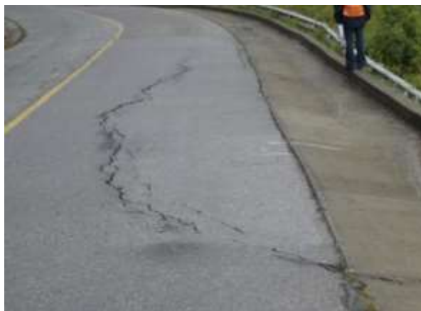
Figura 15: Fisuras de borde.
