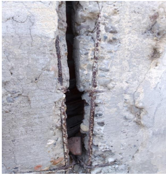
Gráfico 2: Oxidación de armaduras
