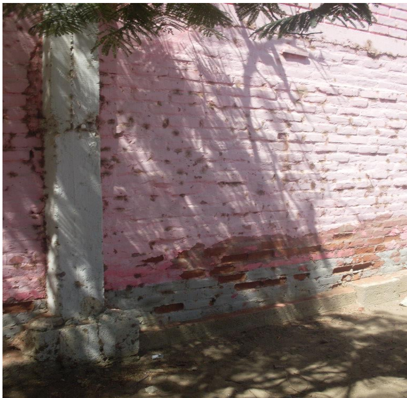
Gráfico 15: Erosión en muro
