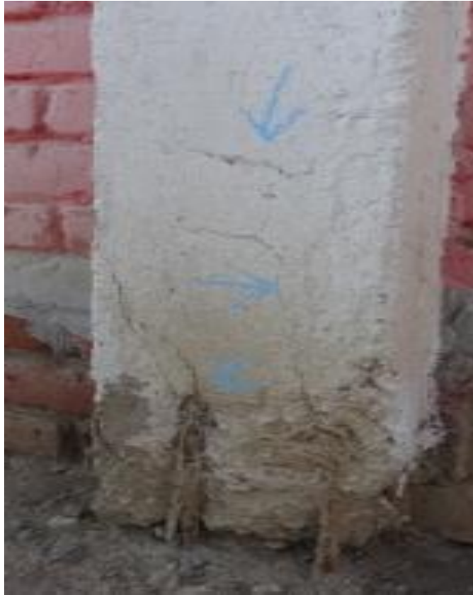
Gráfico 14: Corrosión en el acero de refuerzo
