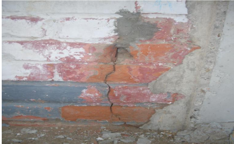
Gráfico 12: Grieta en muro de albañilería
