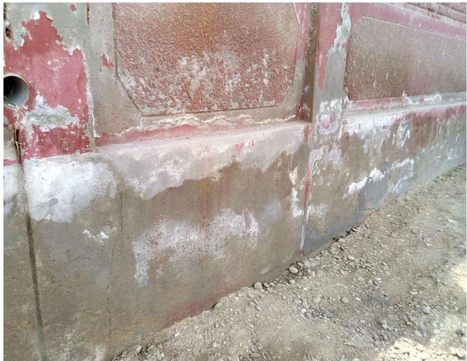
Gráfico 11: patología por eflorescencia en muro
