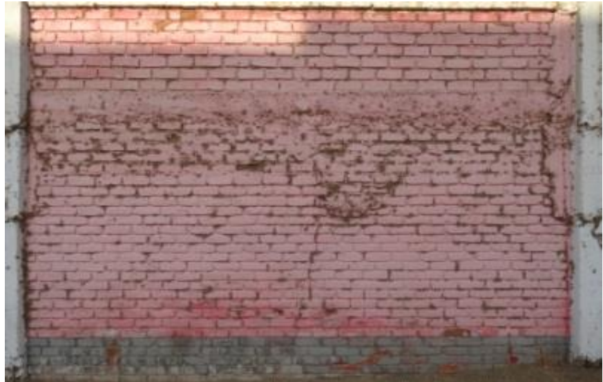
Gráfico 13: Fisura en muro de albañilería confinada
