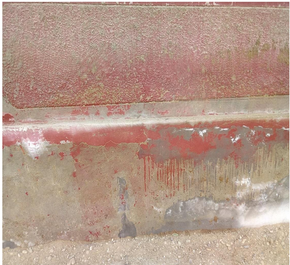
Gráfico 10: Humedad presente en muro
