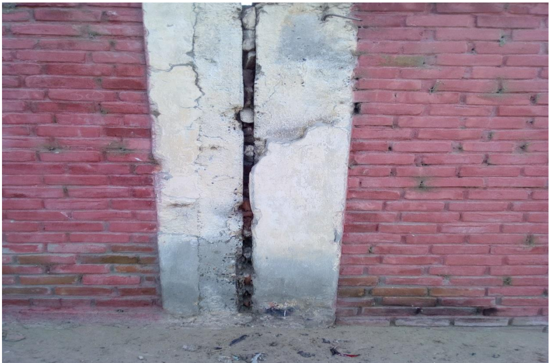
Gráfico 3: Desprendimientos en estructura
