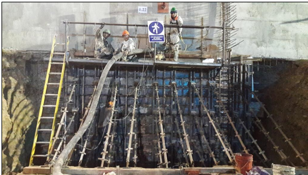
Imagen 25: Mal vibrado del concreto, durante el vaciado.
