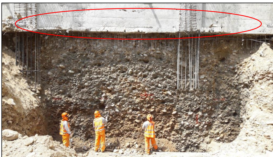
Imagen 21: Junta fría halladas después del desencofrado del muro.
