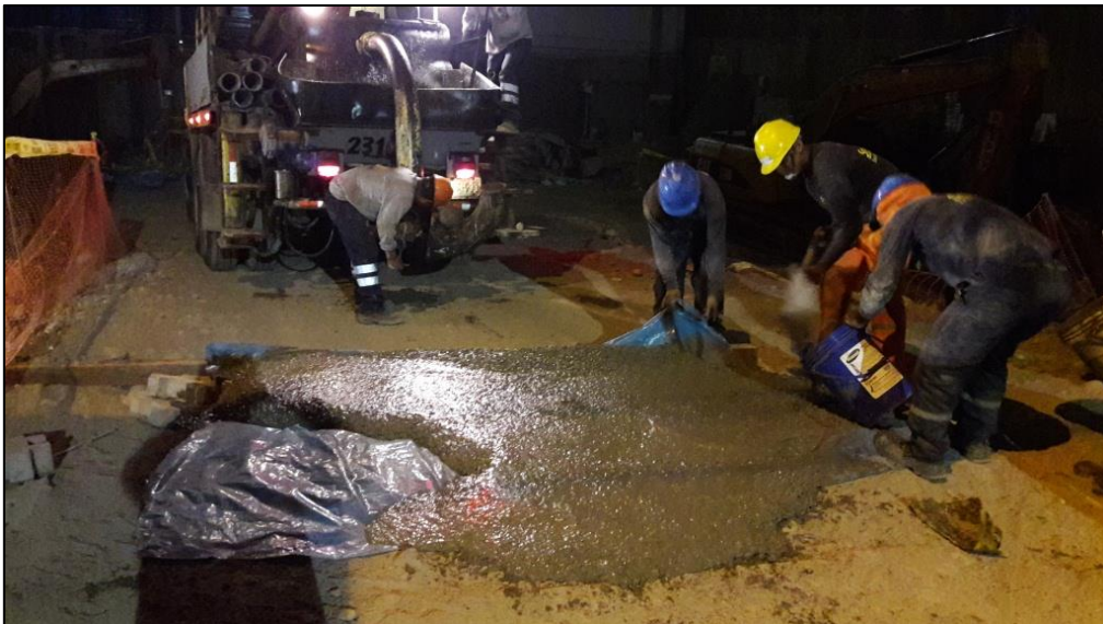
Imagen 23: Perdida de homogeneidad del concreto.
