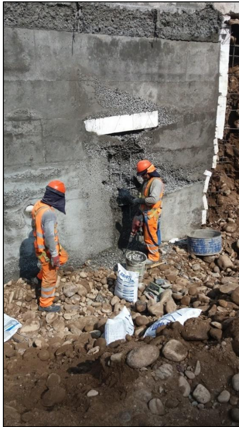
Imagen 18: Cangrejera hallado después del desencofrado del muro.
