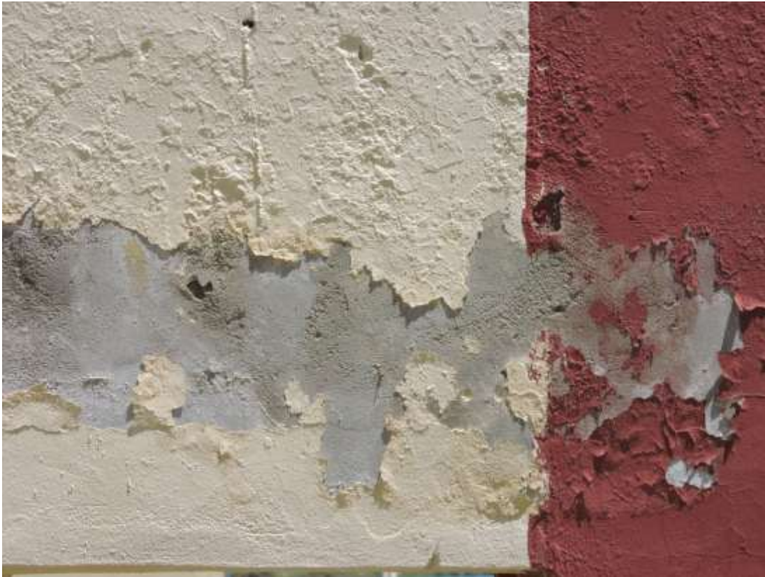
Fotografía 07- Vista del muro con presencia de descascaramiento ubicado en el lado lateral izquierda externo del Instituto de Educación Superior Tecnológico Vicente Ferrer – Tumpa
