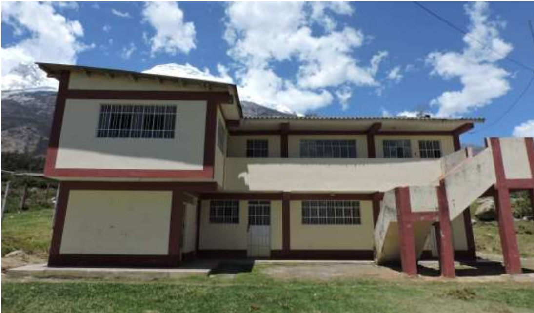
Fotografía 03- Vista panorámica del Tramo Frontal externo del Instituto de Educación Superior Tecnológico Vicente Ferrer – Tumpa
