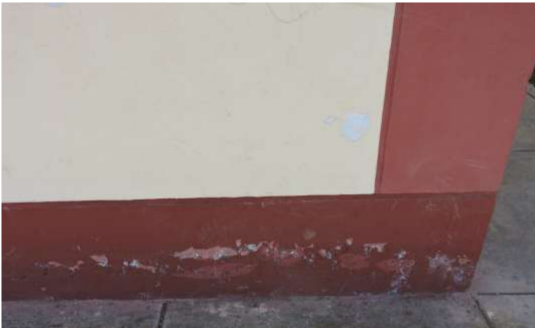
Fotografía 08- Vista del sobre cimienta - muro con presencia de eflorescencia ubicado en el lado lateral frontal externo del Instituto de Educación Superior Tecnológico Vicente Ferrer – Tumpa.
