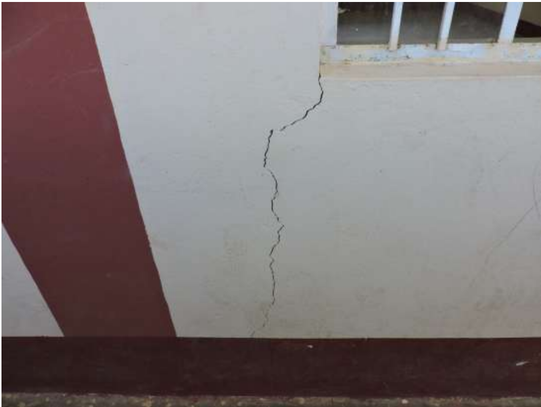
Fotografía 06- Vista del muro con presencia de fisura ubicado en el lado frontal externo del Instituto de Educación Superior Tecnológico Vicente Ferrer – Tumpa.
