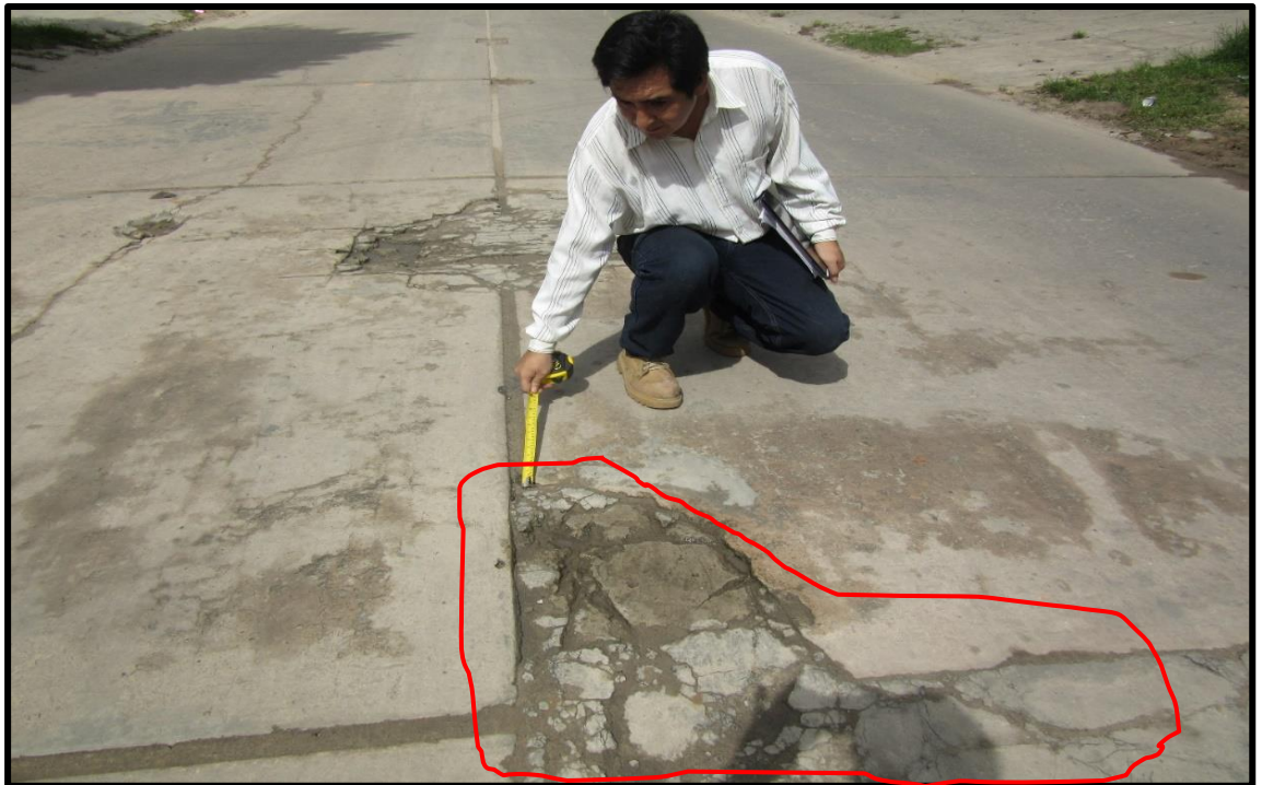
Figura 134: En la vista se observa Fisuras de Losa Dividida en Bloque del pavimento de Media Severidad en el Jirón Trujillo 15va. Cuadra
