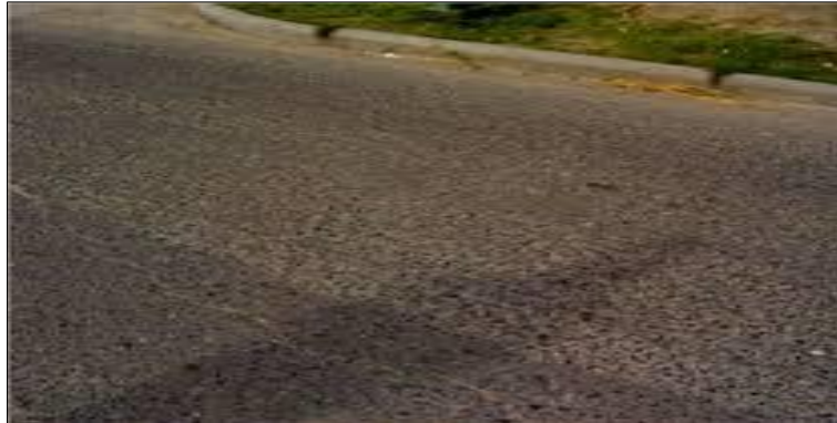
Figura 24: Desintegración en forma de “Peladura”
