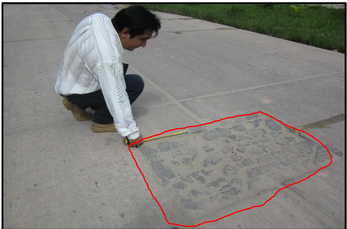
Figura 131: En la vista se observa Fisuras de Losa dividida del pavimento de Media Severidad en el Jirón Trujillo 14va. Cuadra
