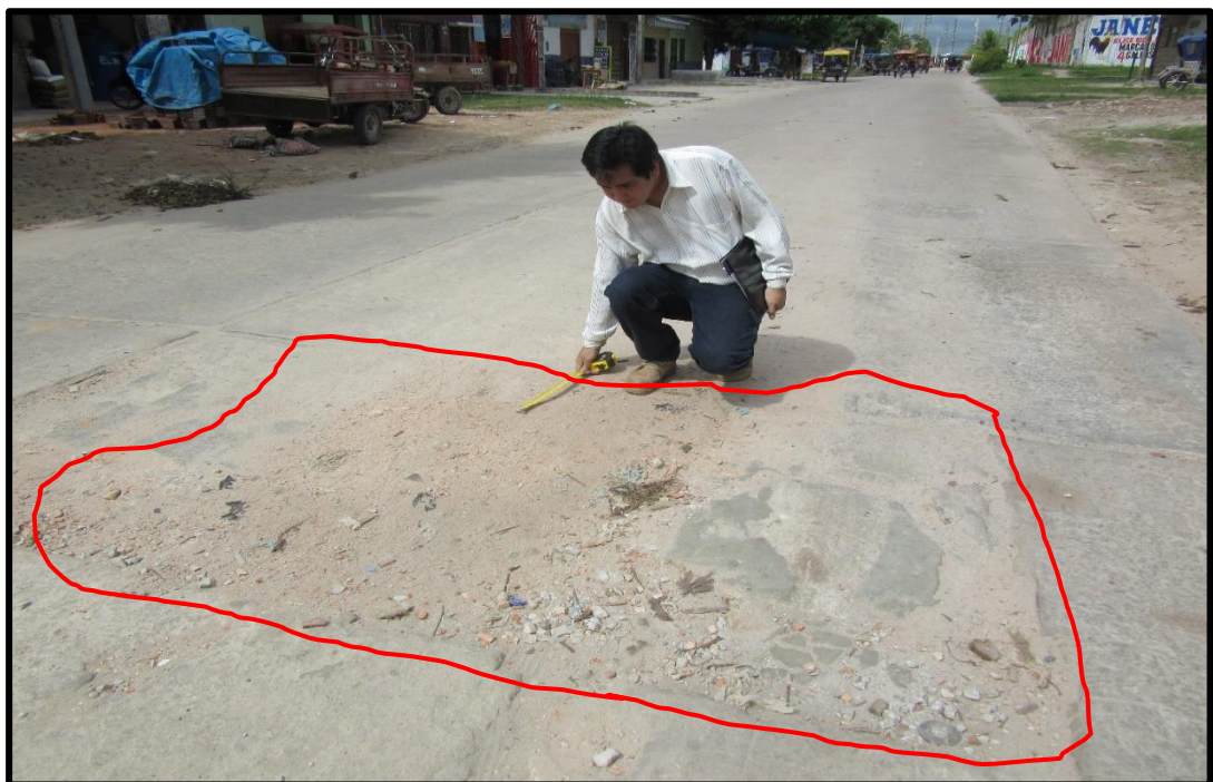
Figura 136: En la vista se observa Fisuras de desconchamiento y Mapeo del pavimento de Media Severidad en el Jirón Trujillo 15va. Cuadra
