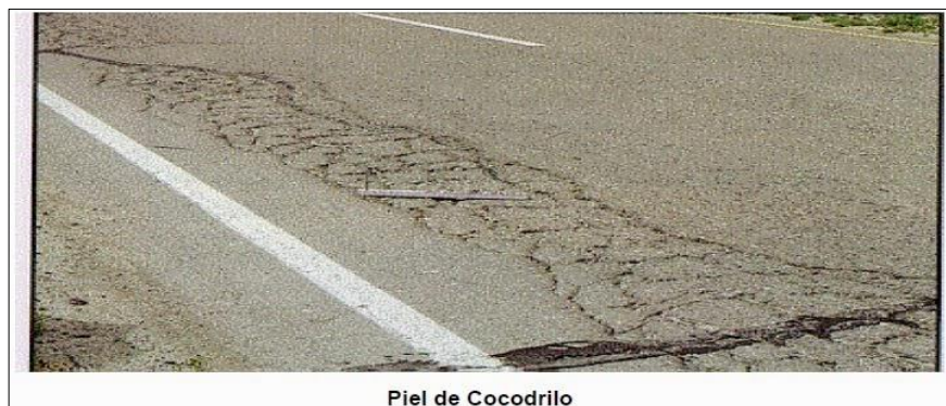
Figura 12: Fisura de tipo “Piel de Cocodrilo”
