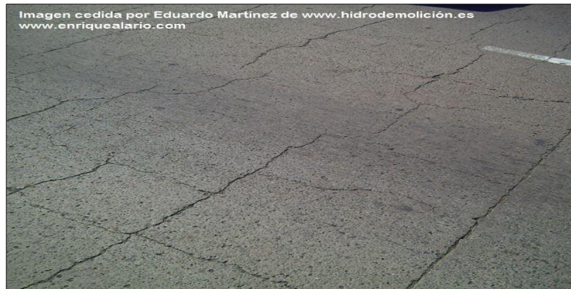
Figura 13: Fisuras en calles de Tipo “Bloque”
