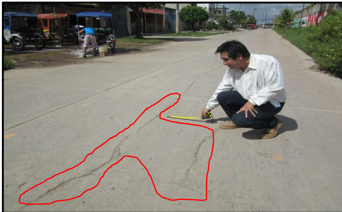
Figura 129: En la vista se observa Grieta Transversal del pavimento de media Severidad en el Jirón Trujillo 14va. Cuadra
