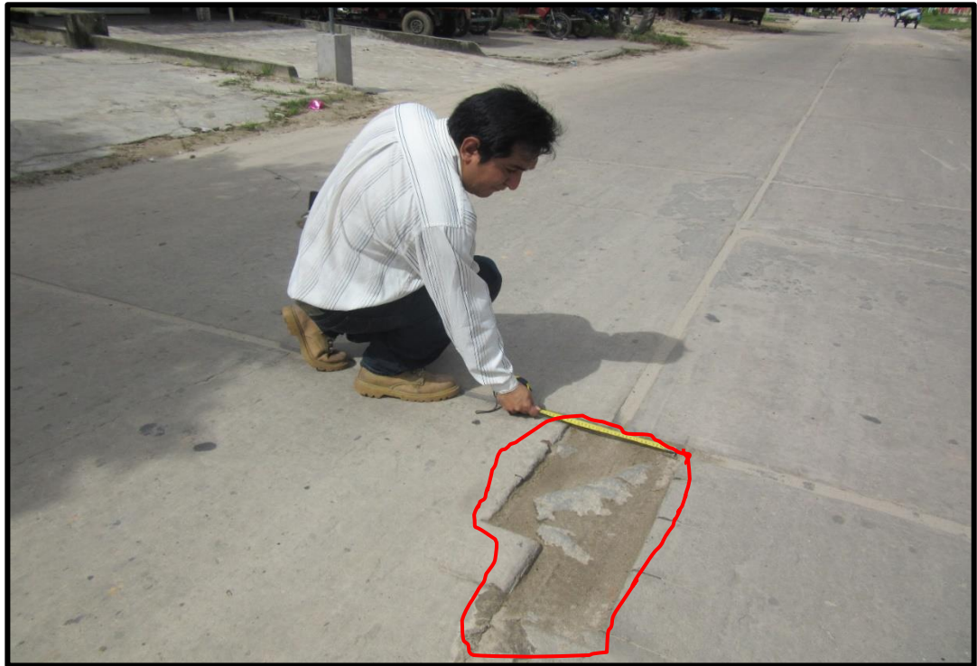
Figura 135: En la vista se observa Fisuras de Grieta de Esquina del pavimento de Alta Severidad en el Jirón Trujillo 15va. Cuadra
