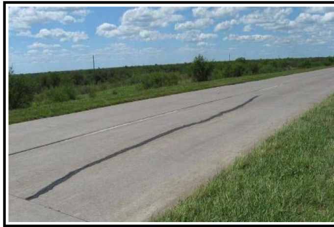
Figura 03: Fisura Longitudinal del pavimento carretera Marginal–Cuñumbuque–sisá (60 km)
