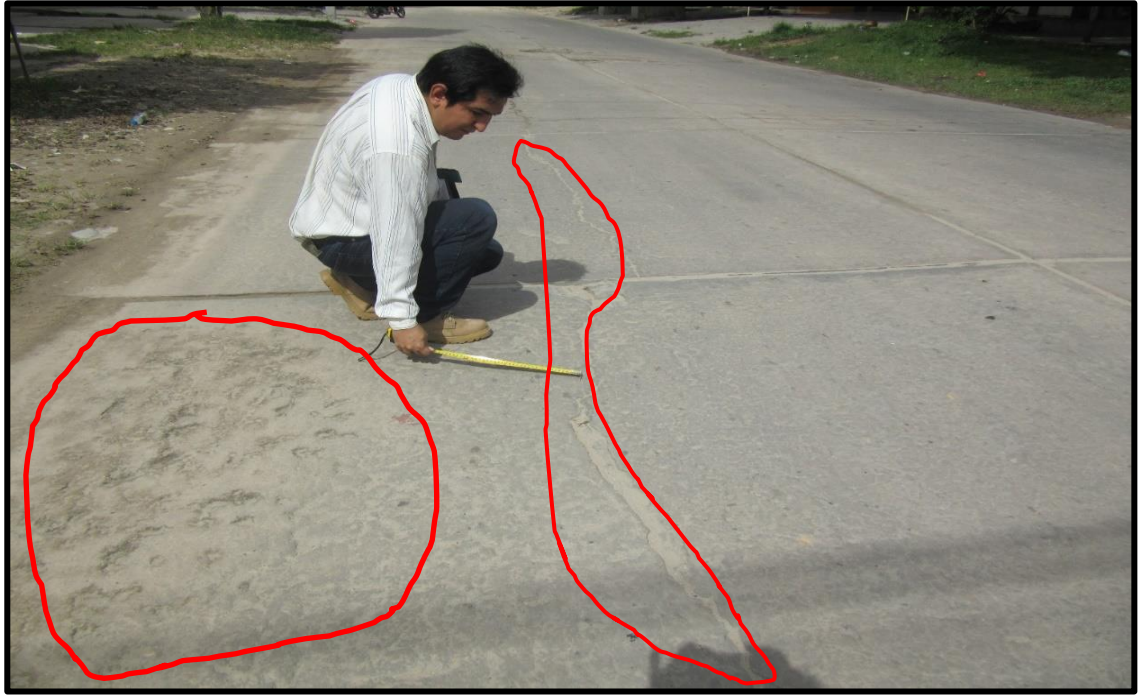
Figura 133: En la vista se observa Fisuras de Grietas Lineal Longitudinal del pavimento de Baja y Media severidad en el Jirón Trujillo 15va. cuadra
