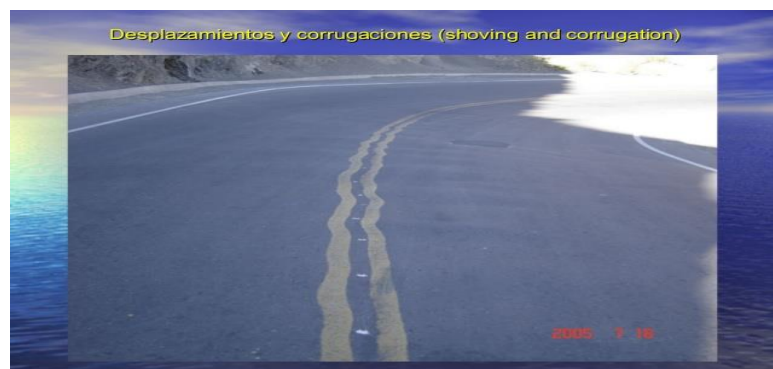
Figura 20: Deformación por Corrugación
