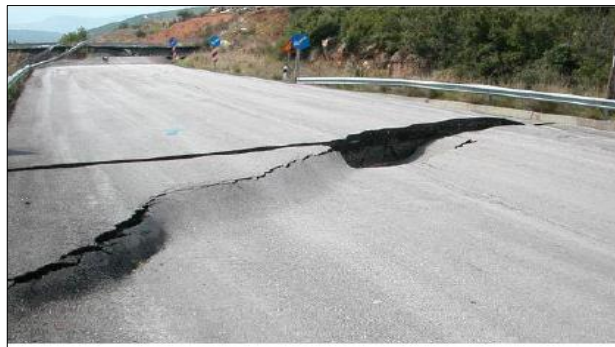
Figura 18: Deformación Superficial de Tipo Ahuellamiento
