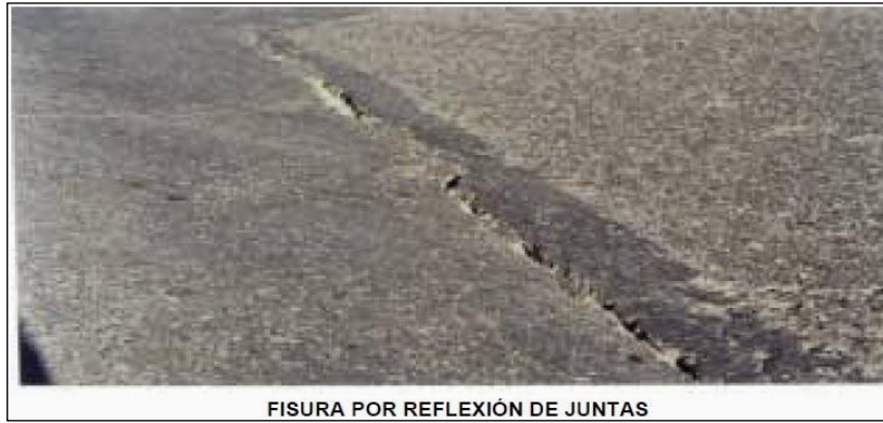
Figura 17: Fisuras Por “Reflexión de Juntas”
