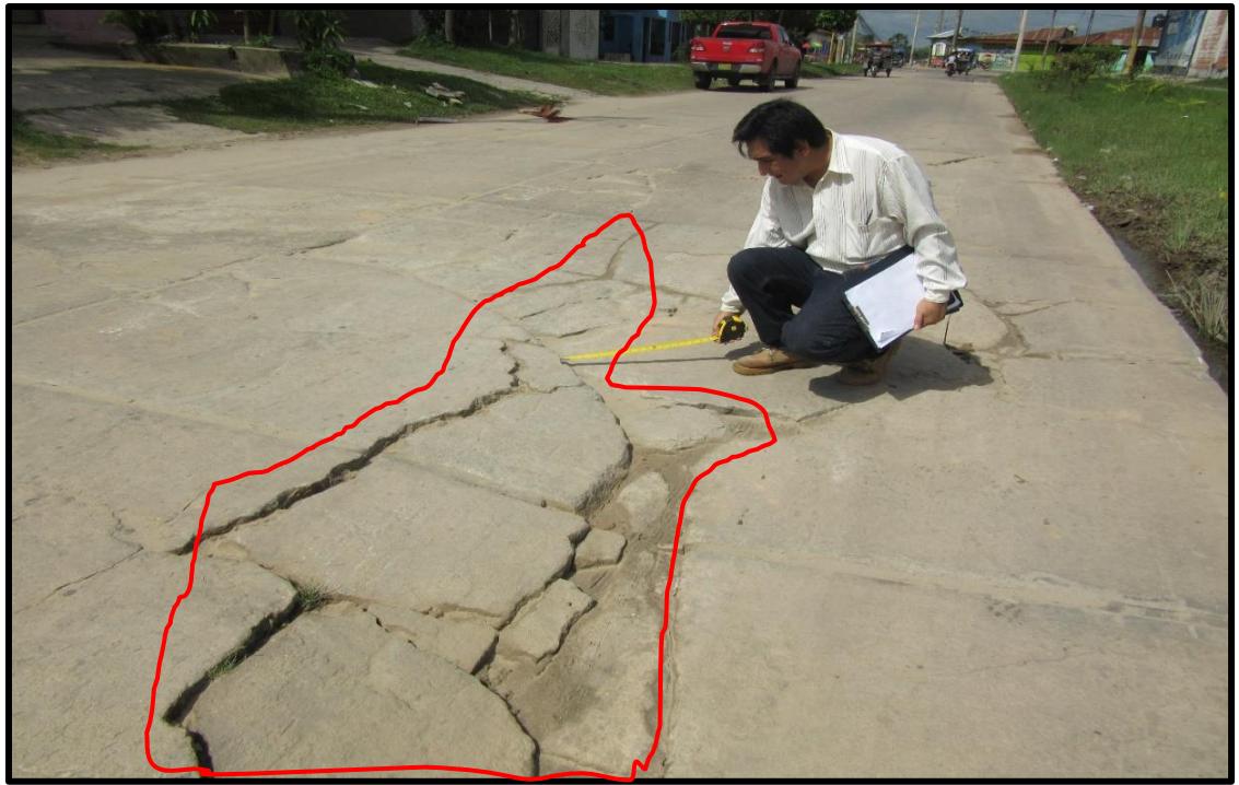
Figura 130: En la vista se observa Fisura de Grieta de Esquina del pavimento de Media Severidad en el Jirón Trujillo 14va. Cuadra
