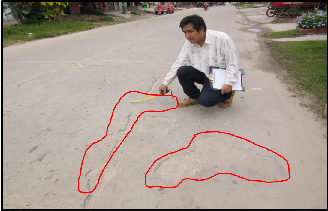
Figura 115: En la vista se observa desnivel de carril de alta severidad del Jirón Trujillo 11va. Cuadra
