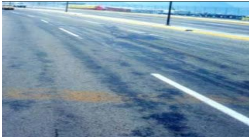
Figura 26: Deterioro denominado “Exudación de Asfalto”
