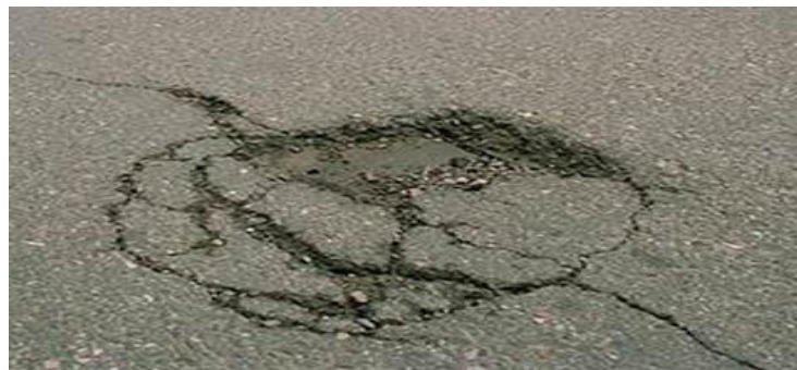
Figura 22: Deformación por Hundimiento
