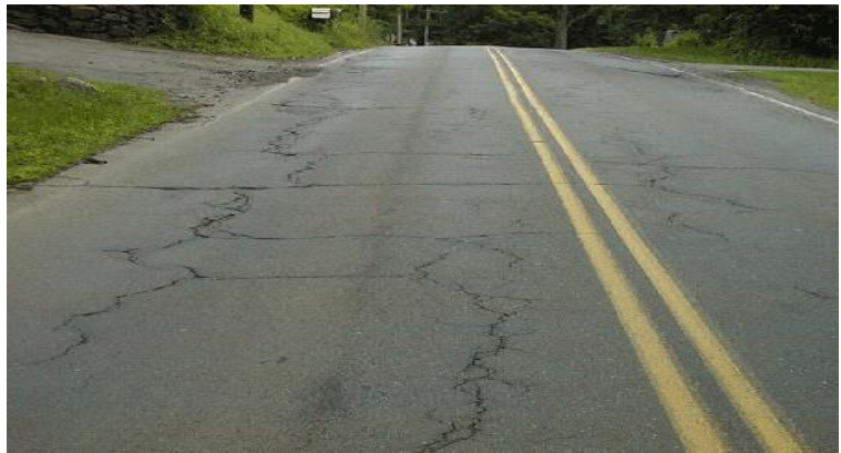
Figura 16: Fisuras en forma “Longitudinal”
