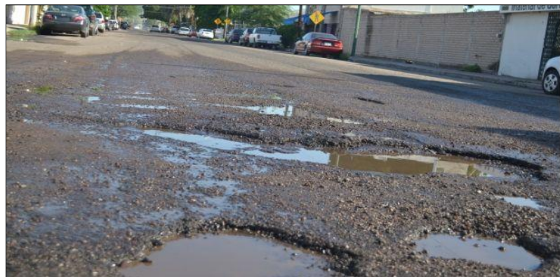
Figura 23: Desintegración denominado “Bache”
