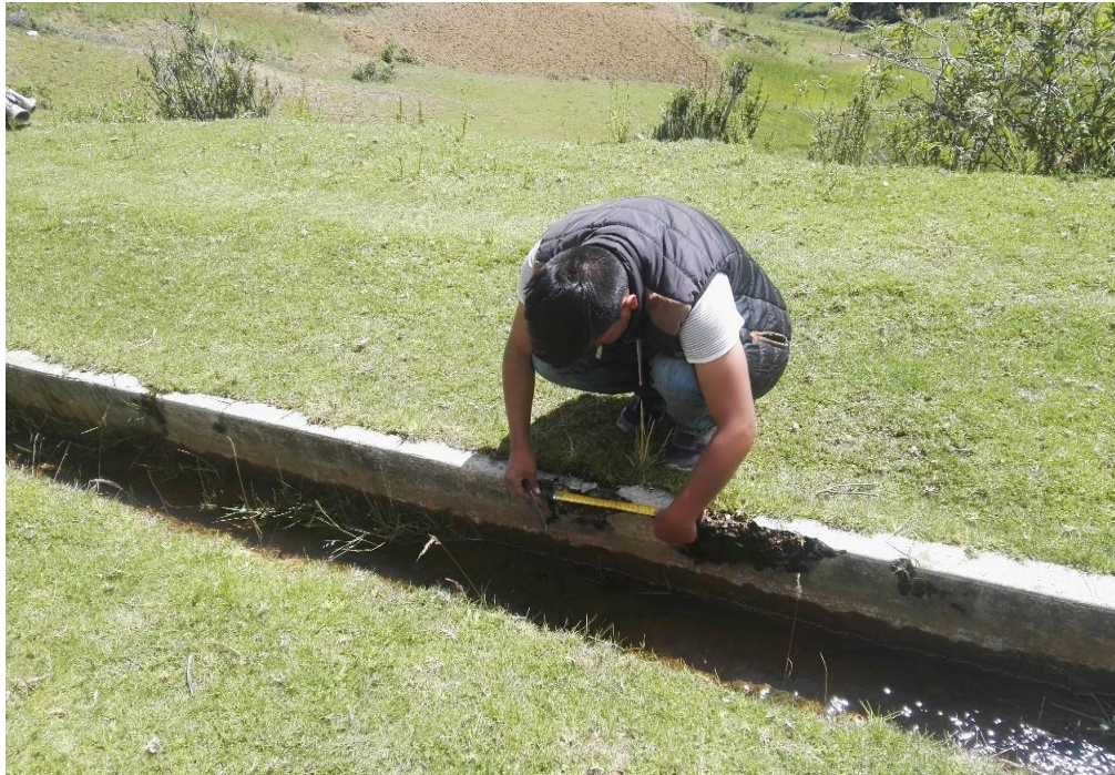
Fotografía 03- vista muro derecho midiendo la degradación en el canal de irrigación Mesacucho caserío de Chuspin distrito de Casca provincia de Mariscal Luzuriaga.
