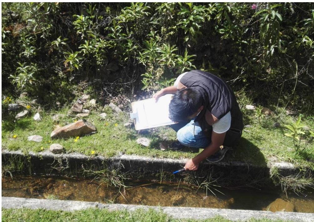
Fotografía 04- vista muro izquierdo vegetación y musgo en el canal de irrigación Mesacucho caserío de Chuspin distrito de Casca provincia de Mariscal Luzuriaga.
