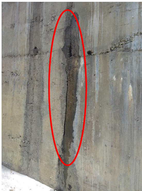
Fotografía 2: se puede visualizar la humedad en la pantalla del muro de contención.
