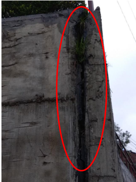
Fotografía 3: existe erosión en las juntas del muro de contención.
