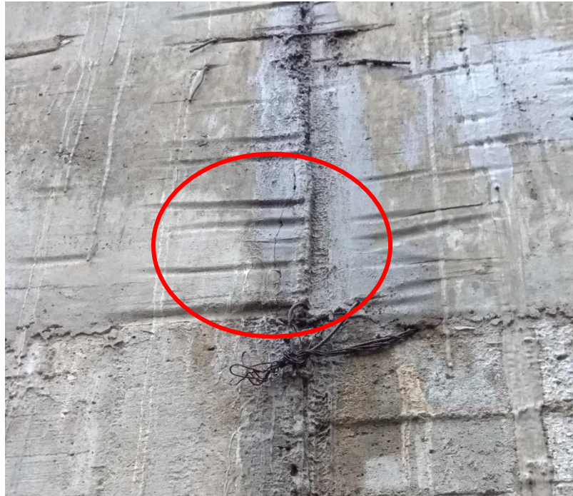
Fotografía 5: presencia de fisura y grieta en el muro de contención.
