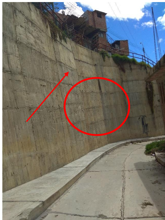
Fotografía 4: Existe deformación como pandeo producto del proceso constructivo y el empuje de pasivo.
