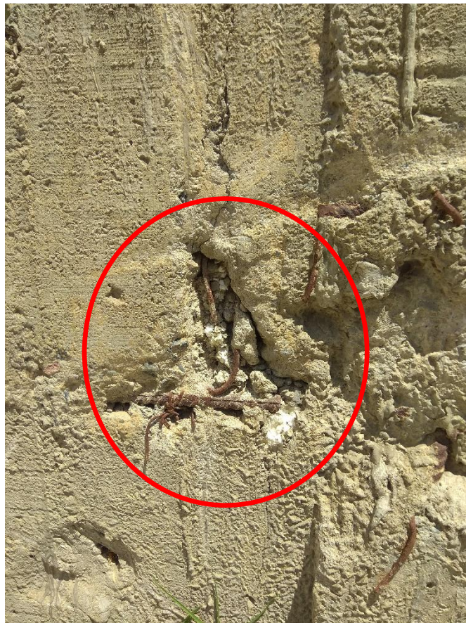
Fotografía 6: evidencia de grietas, corrosión y oxidación.
