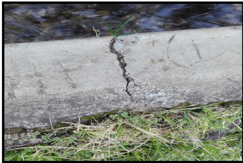
Imagen 17: Grieta en la estructura del canal.
