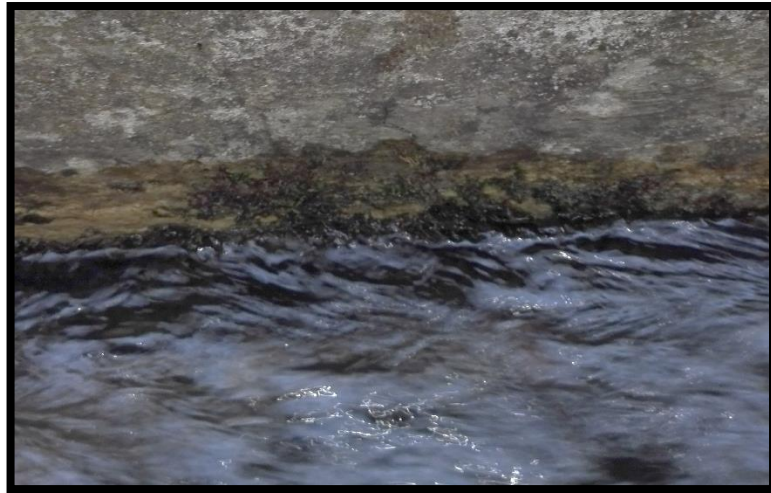
Imagen 18: Erosión en el lateral del canal.
