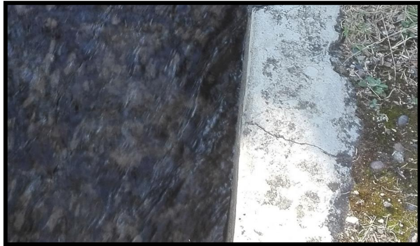
Imagen 16: Fisura en la estructura del canal
