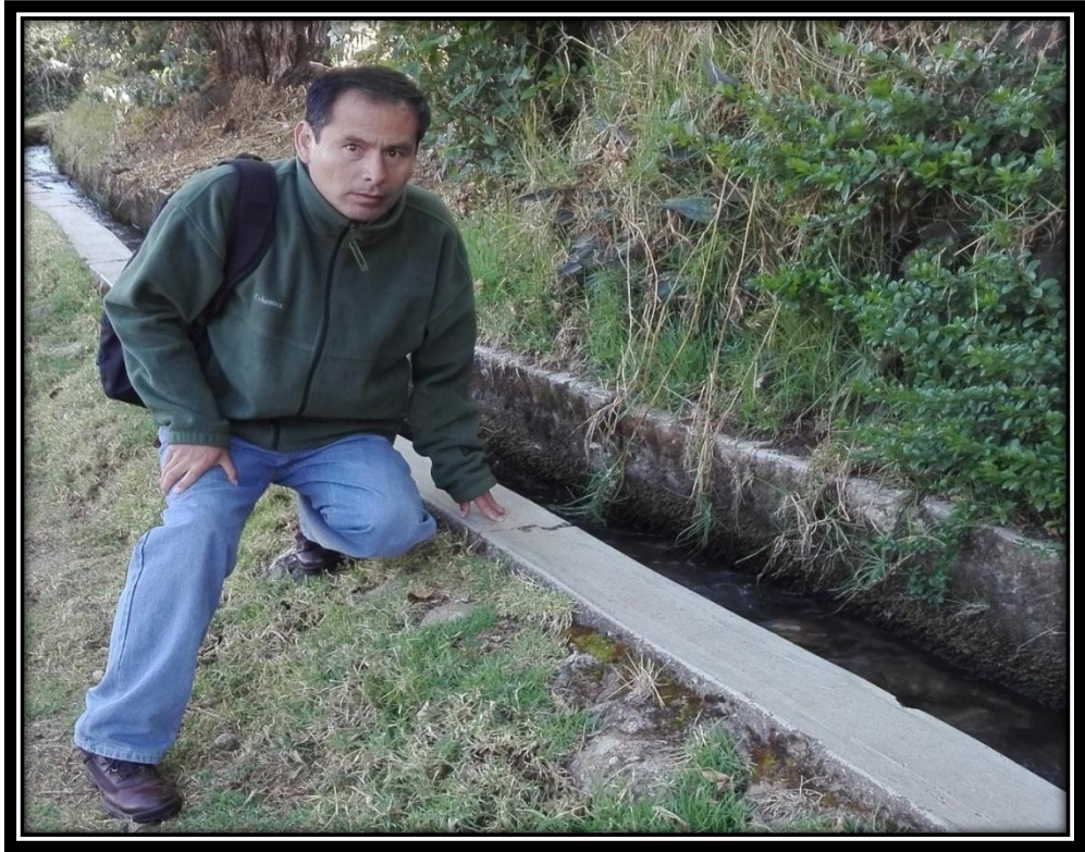
Imagen 26: Identificando las patologías en el canal Antapluy.
