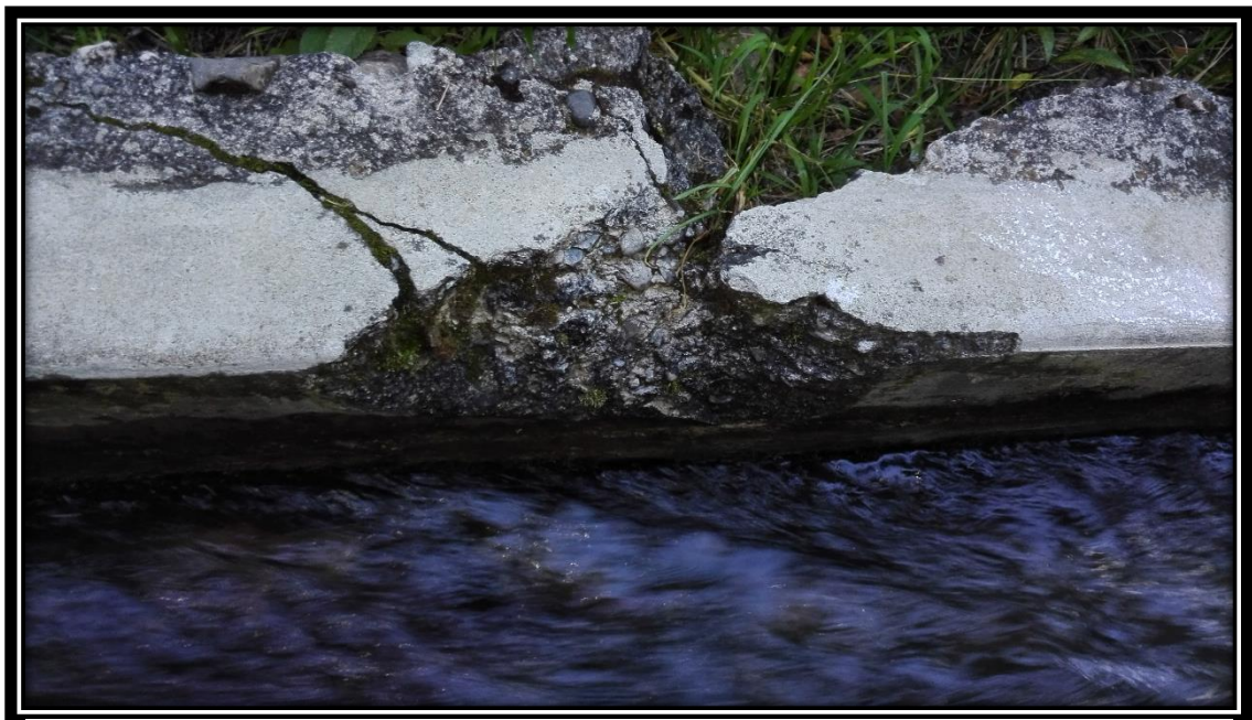
Imagen 25: Patología fracturamiento en el canal en estudio.
