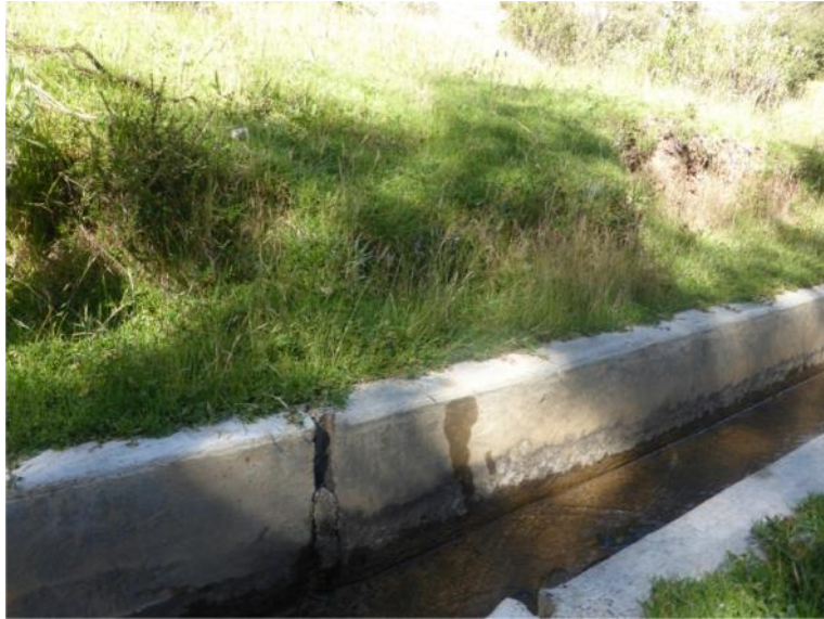
Foto03: se observa eflorescencia en el canal de regadío.
