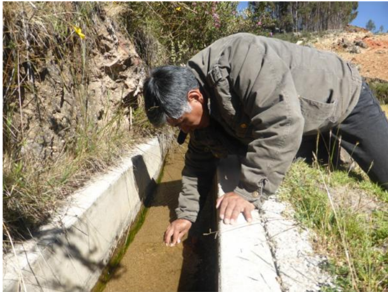
Foto4: se observa erosión en el fondo del canal de regadío.
