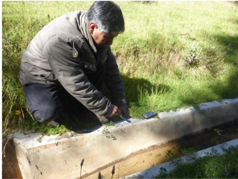
Foto01: se observa la presencia de fisuras en el canal de regadío
