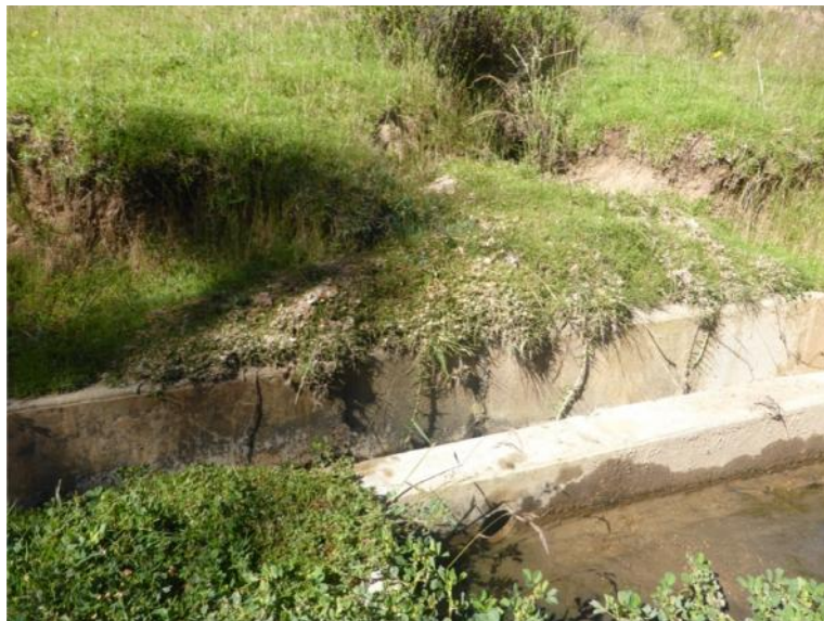
Foto02: se observa vegetación en el canal de regadío
