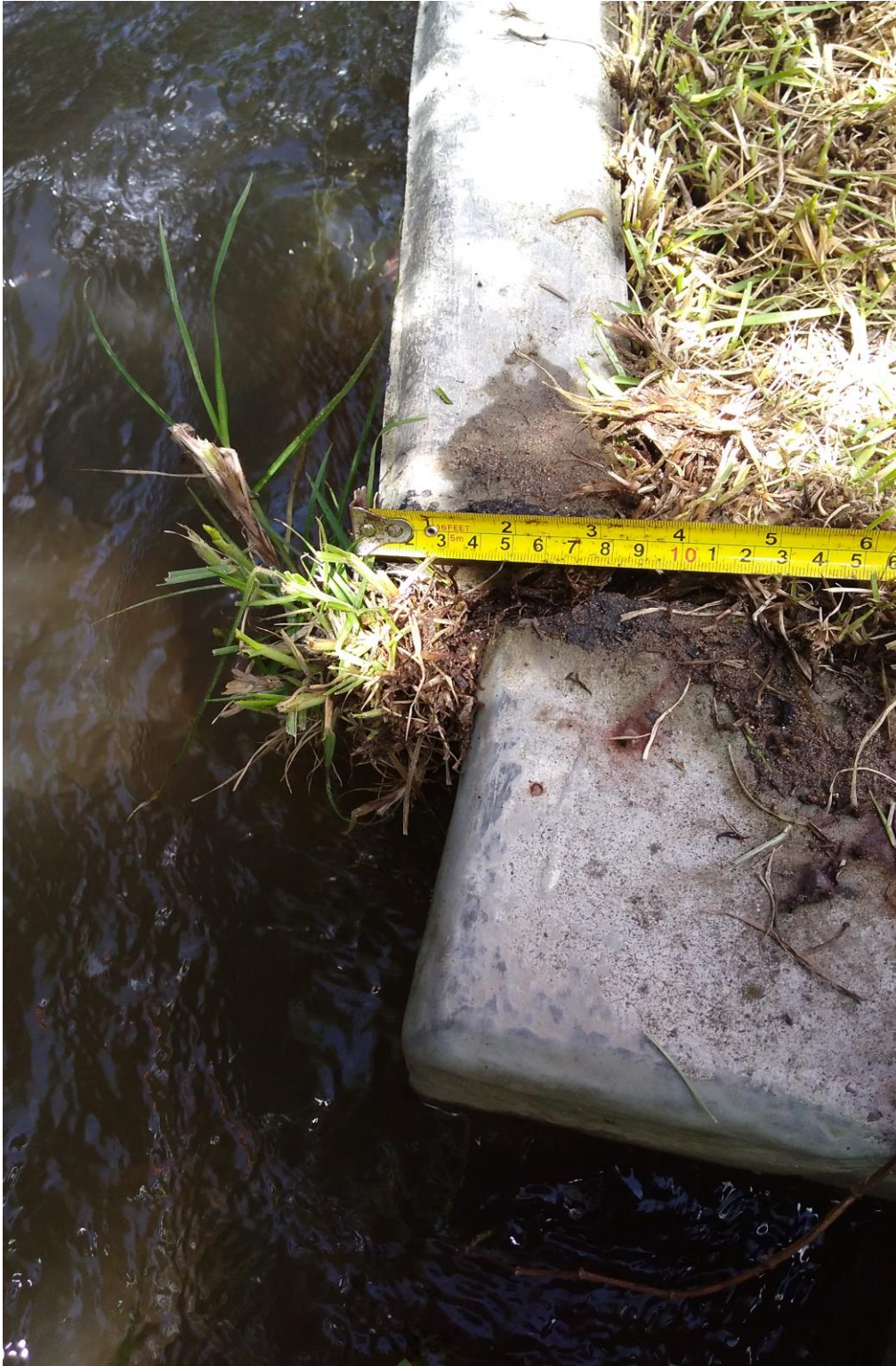
Figura 6: desplazamiento de la estructura(entrega).
