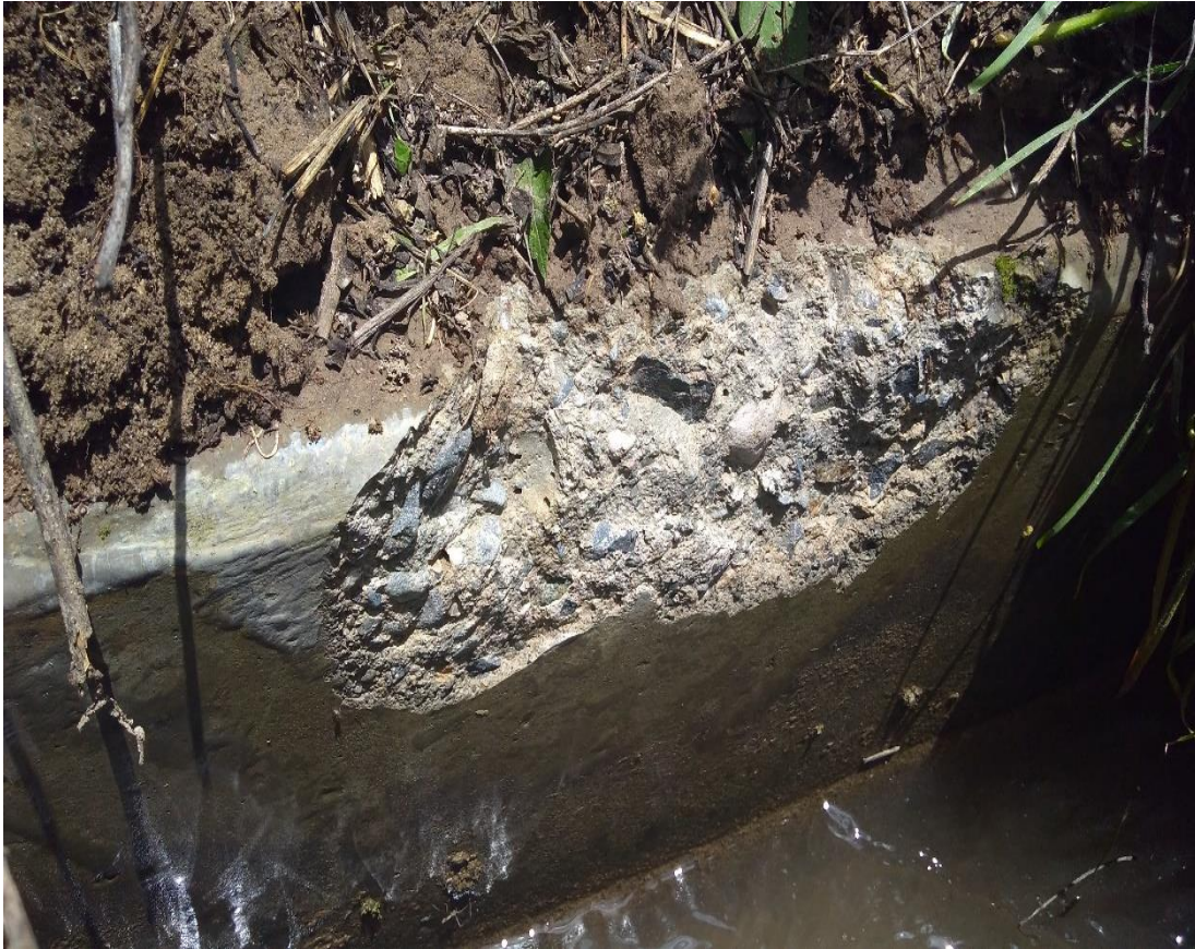
Figura 4: daño por caída de piedras y vegetación por no tener el mantenimiento adecuado del canal.
