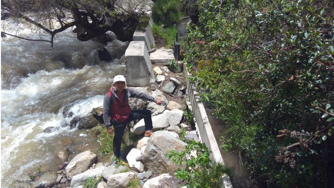
Figura 7: socavamiento del terreno de fundación.
