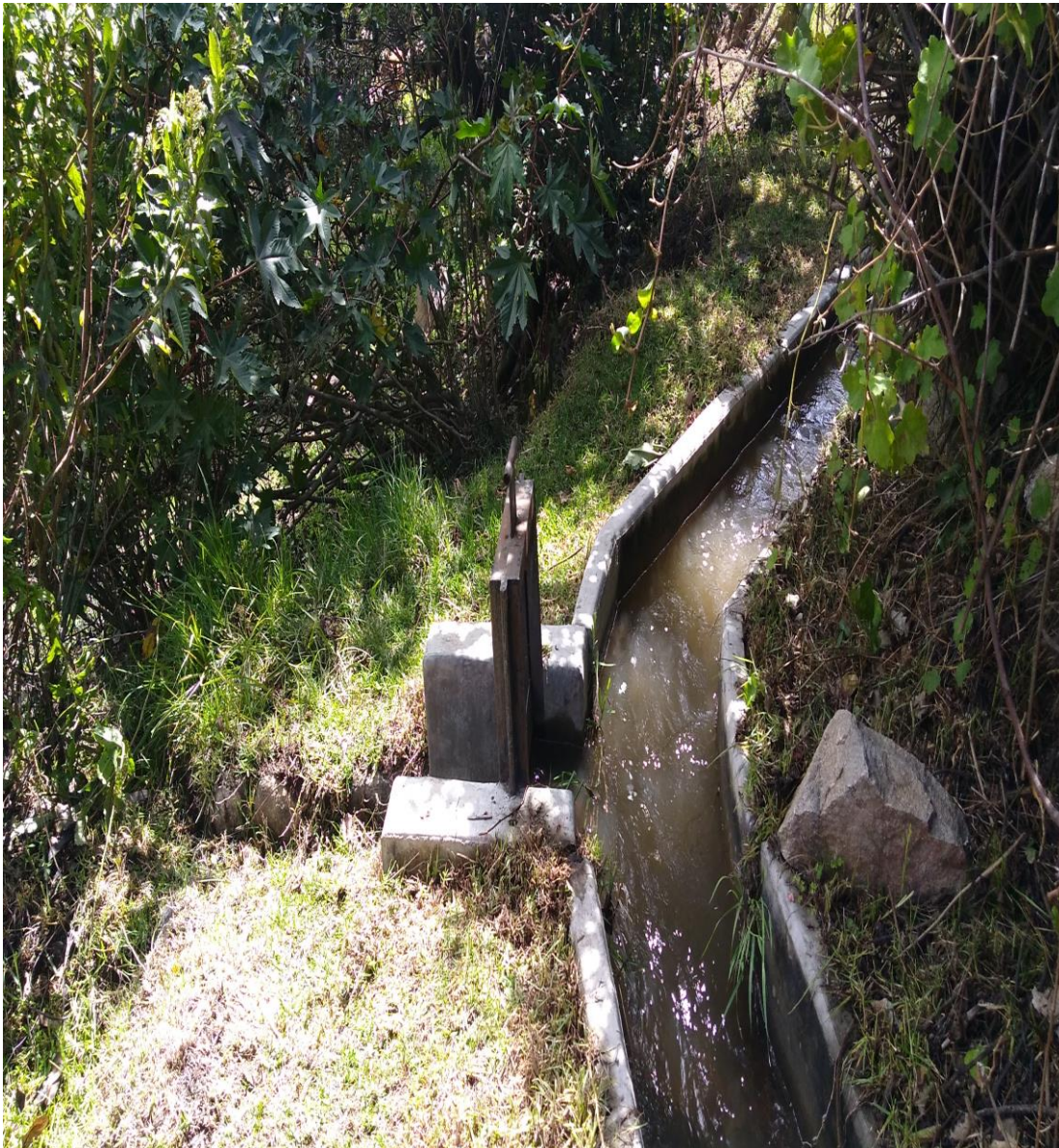
figura 5: proceso constructivo inadecuado.
