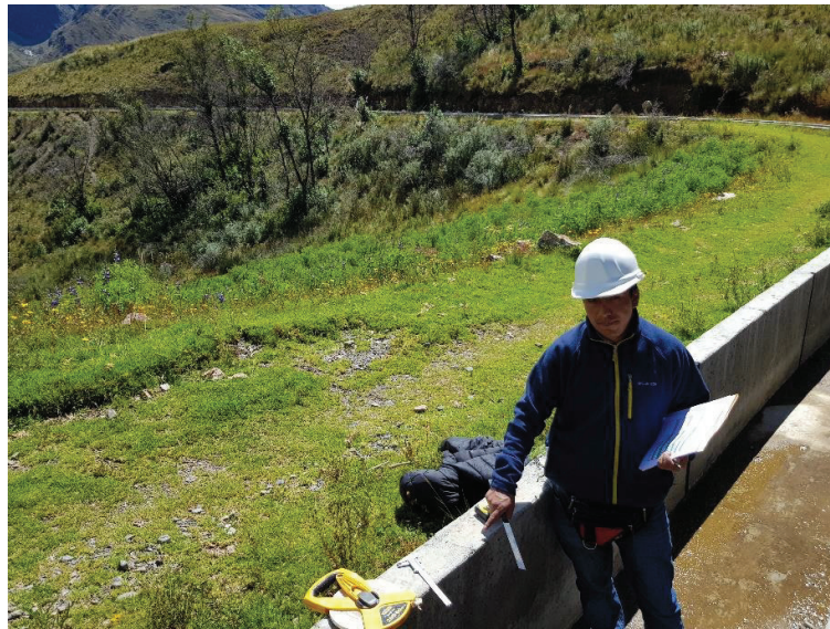
Imagen N° 21: En la vista se observa la ubicación exacta de la grieta del canal juitush en la progresiva 3+594.40 a 3+608.80 para la unidad muestral N° 04
