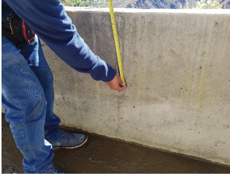
Imagen N° 30: En la vista se observa la medición de la longitud de la fisura en la unidad muestral N° 10
