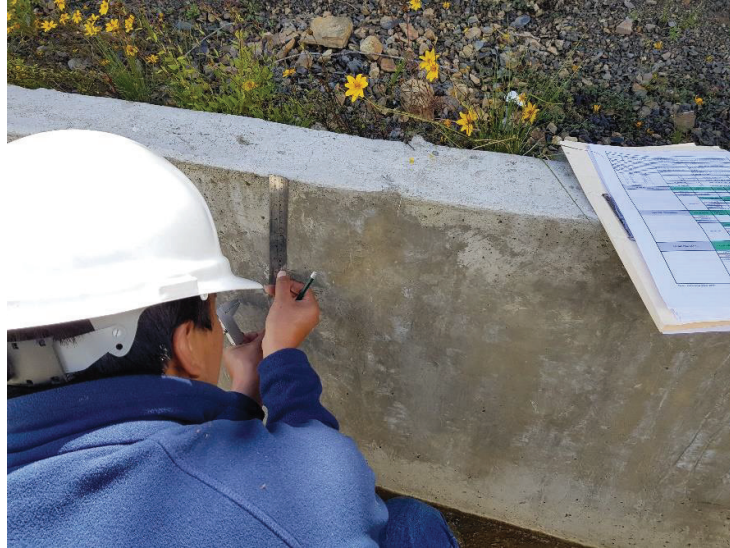
Imagen N° 14: En la vista se observa haciendo las mediciones de la fisura vertical en la primera unidad muestral entre la progresiva 3+460 a 3+474.40
