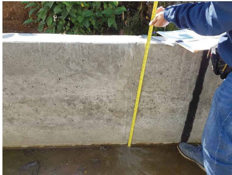
Imagen N° 25: En la vista se observa la medición de la longitud transversal de la grieta en margen derecho del canal en la progresiva 3+700.00 a 3+714.40 para la unidad muestral N° 07
