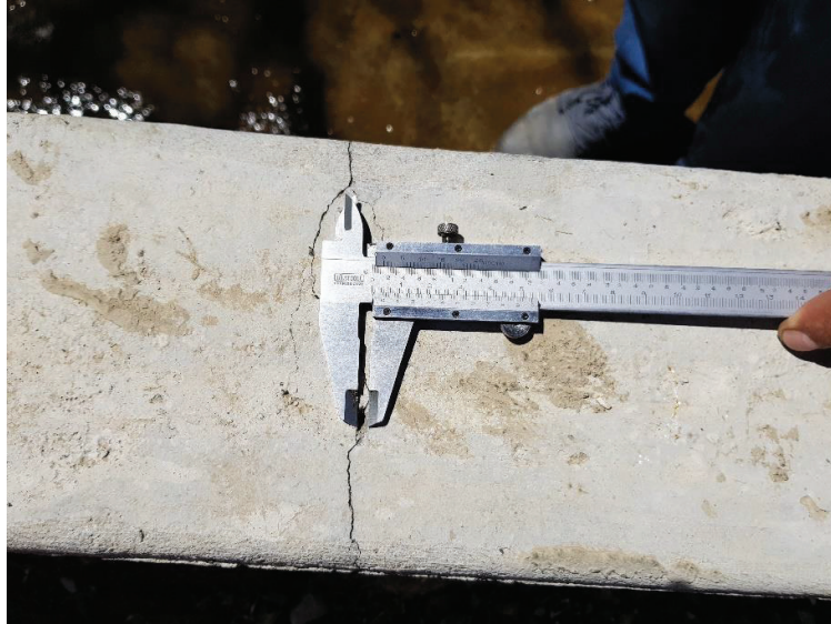
Imagen N° 22: En la vista se observa haciendo la medición de la abertura de la grieta con el vernier para la unidad de muestra N° 06
