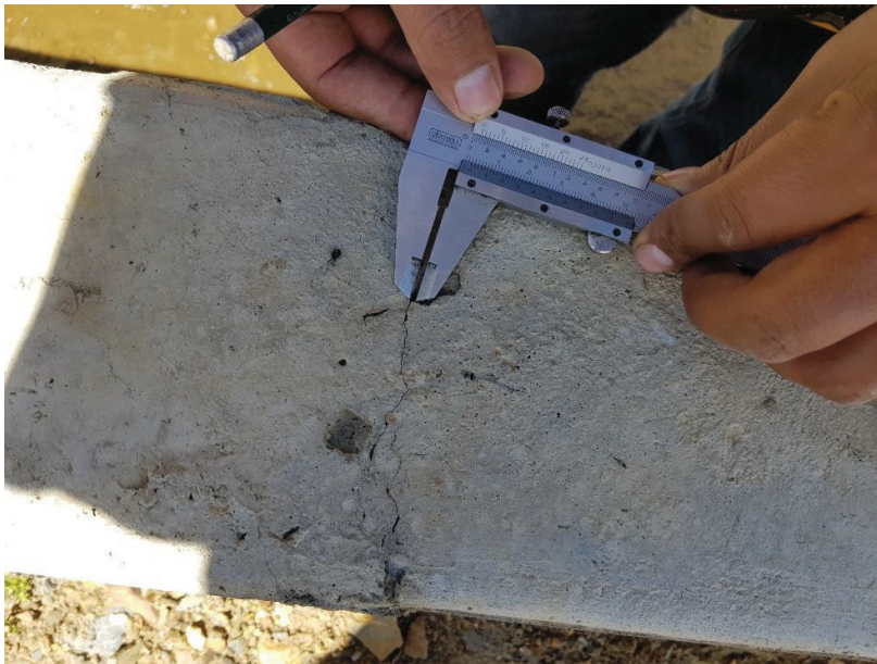
Imagen N° 29: En la vista se observa la medición con vernier la abertura de la fisura en la unidad muestral N° 10
