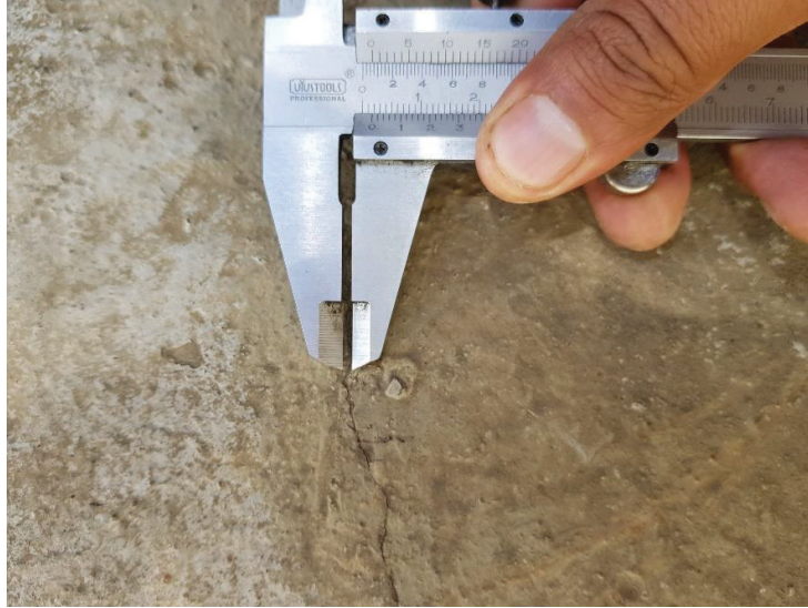
Imagen N° 32: En la vista se observa la medición con vernier la abertura de la grieta en el fondo del canal en la unidad muestral N° 13
