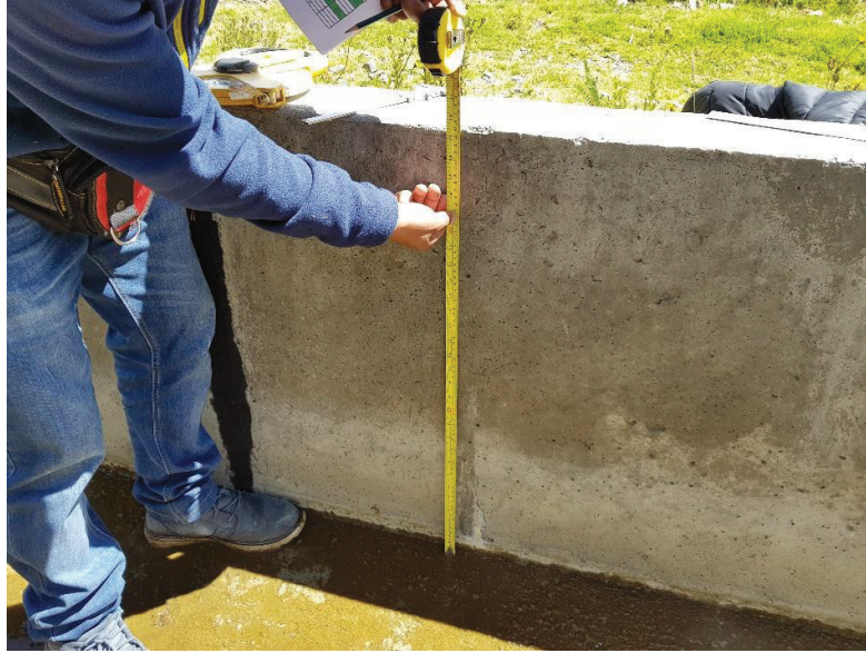
Imagen N° 20: En la vista se observa haciendo la medición de la grieta su longitud para la unidad de muestra N° 04
