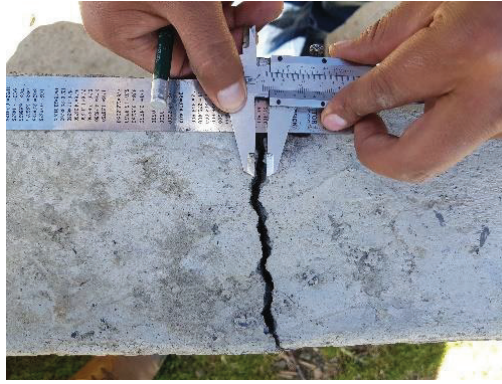
Imagen 09: Grieta en la pared del canal
