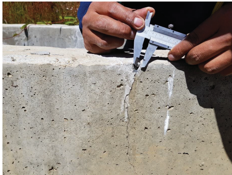
Imagen N° 31: En la vista se observa la medición con vernier la abertura de la grieta en la unidad muestral N° 11
