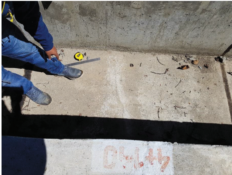
Imagen N° 33: En la vista se observa la grieta en el progresiva 4+124.00 a 4+142.00 en la unidad muestral N° 13
