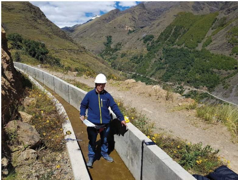
Imagen N° 17: En la vista se observa la ubicación exacta de la grieta del canal juitush en la progresiva 3+520 a 3+534.40
