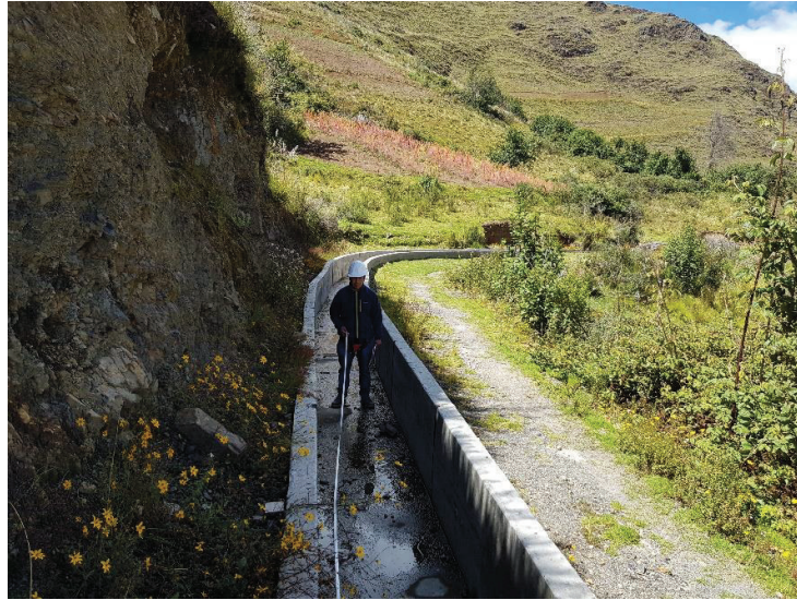
Imagen N° 12: En la vista se observa haciendo las mediciones de la primera unidad muestral entre la progresiva 3+460 a 3+474.40
