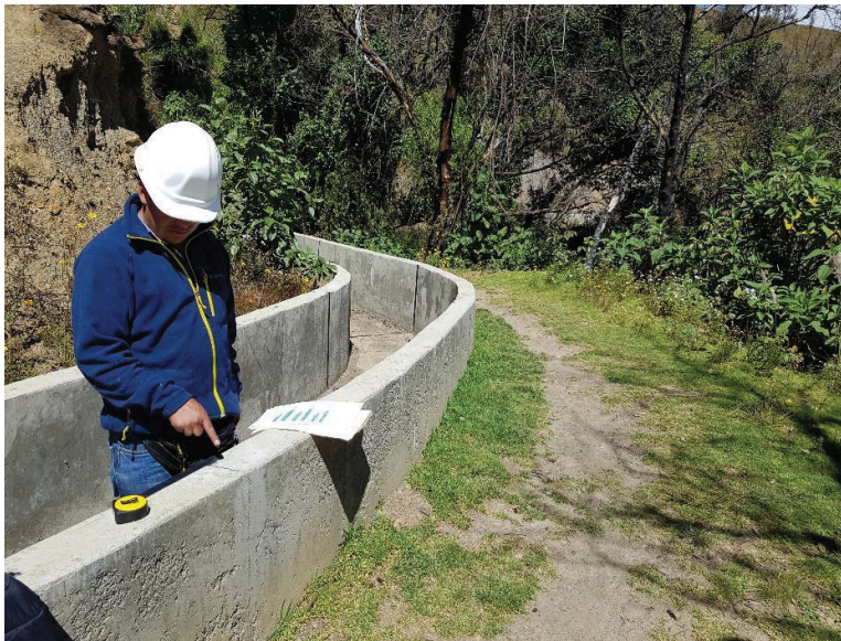
Imagen N° 35: En la vista se observa la grieta en el progresiva 4+142.00 a 4+160.00 en la unidad muestral N° 14
