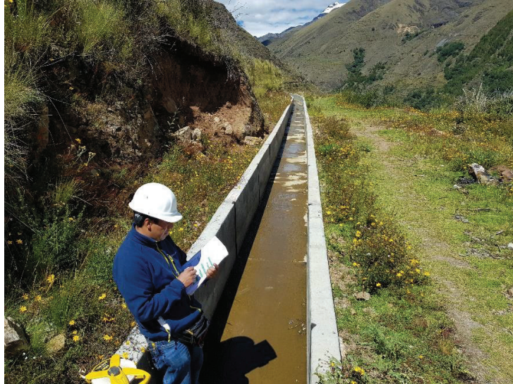
Imagen N° 18: En la vista se observa tomando los datos con la ficha de inspección para la unidad de muestra N° 03
