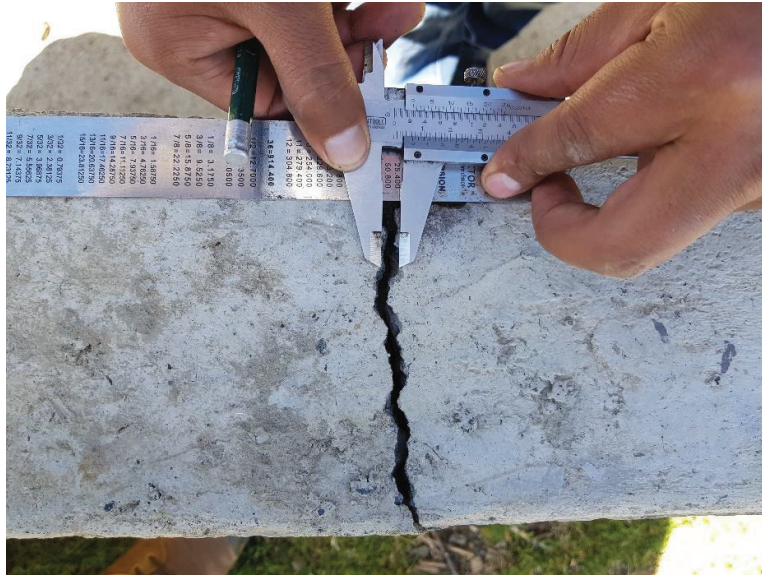
Imagen N° 34: En la vista se observa la medición con vernier la abertura de la grieta en margen izquierdo del canal en la unidad muestral N° 14
