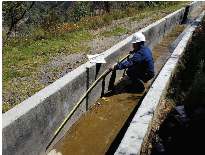
Imagen N° 23: En la vista se observa la medición de la área de la patología de eflorescencia en la progresiva 3+654.40 a 3+668.80 para la unidad muestral N° 06
