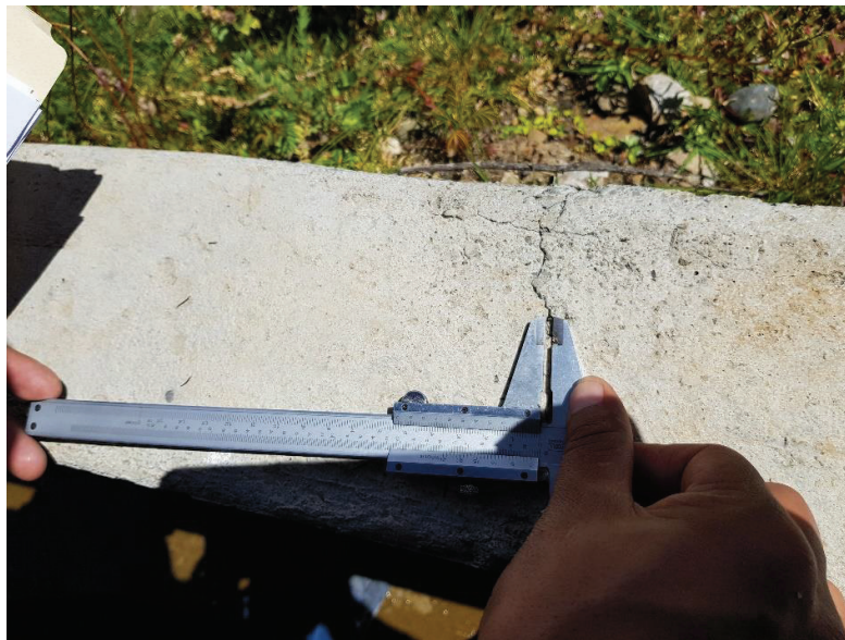
Imagen N° 19: En la vista se observa haciendo la medición de abertura la grieta con el vernier en margen Izquierdo del canal en la unidad muestral N° 04
