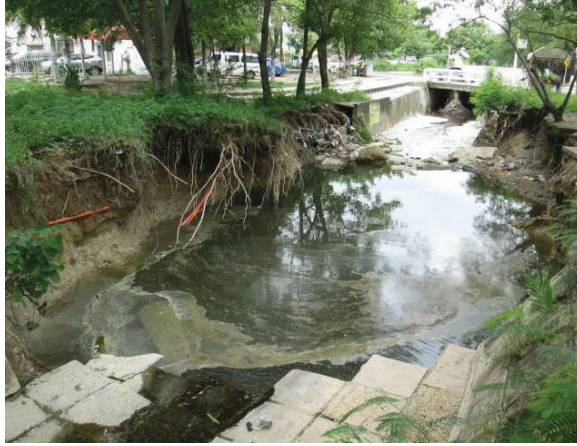
Imagen 11: Erosión en el piso del canal
