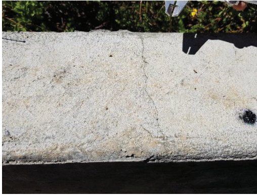
Imagen 10: Fisura en la pared del canal
