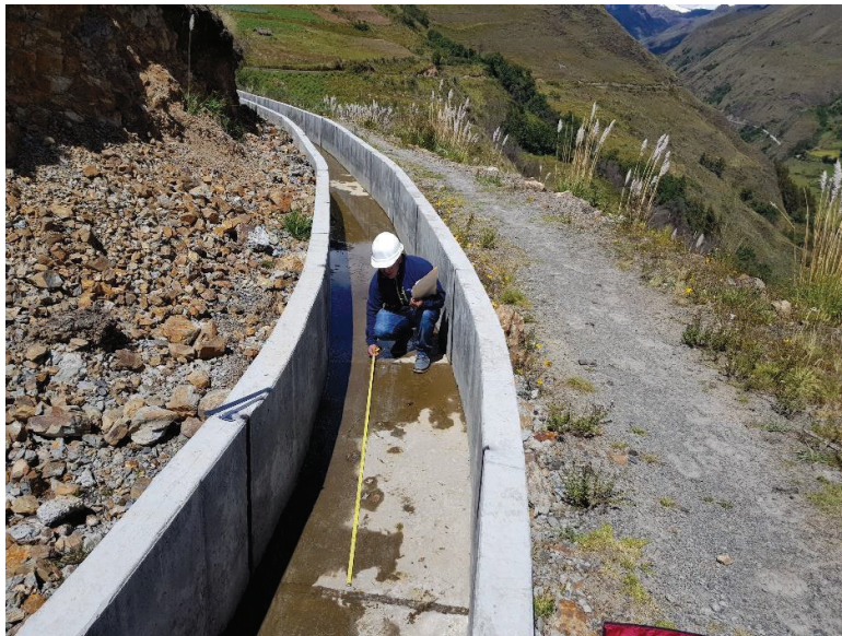
Imagen N° 27: En la vista se observa la medición de la área erosionada en la unidad muestral N° 08
