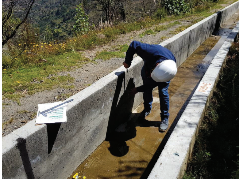
Imagen N° 24: En la vista se observa la medición de la área de la patología de eflorescencia en la progresiva 3+654.40 a 3+668.80 para la unidad muestral N° 06
