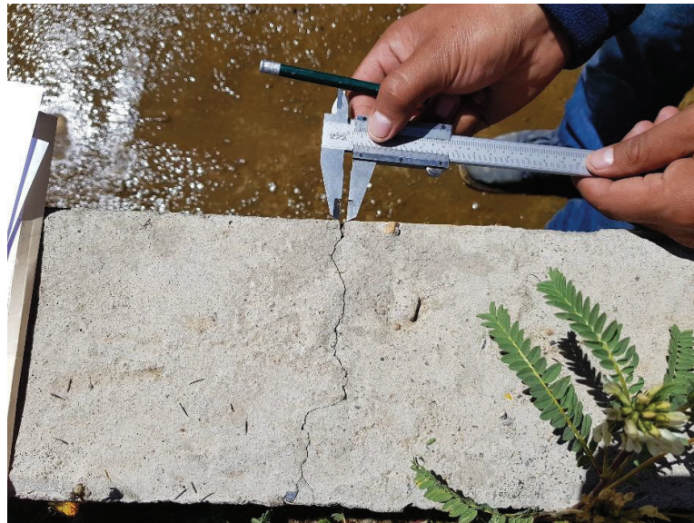
Imagen N° 15: En la vista se observa haciendo la medición de abertura la grieta con el vernier en margen Izquierdo del canal en la unidad muestral N° 02
