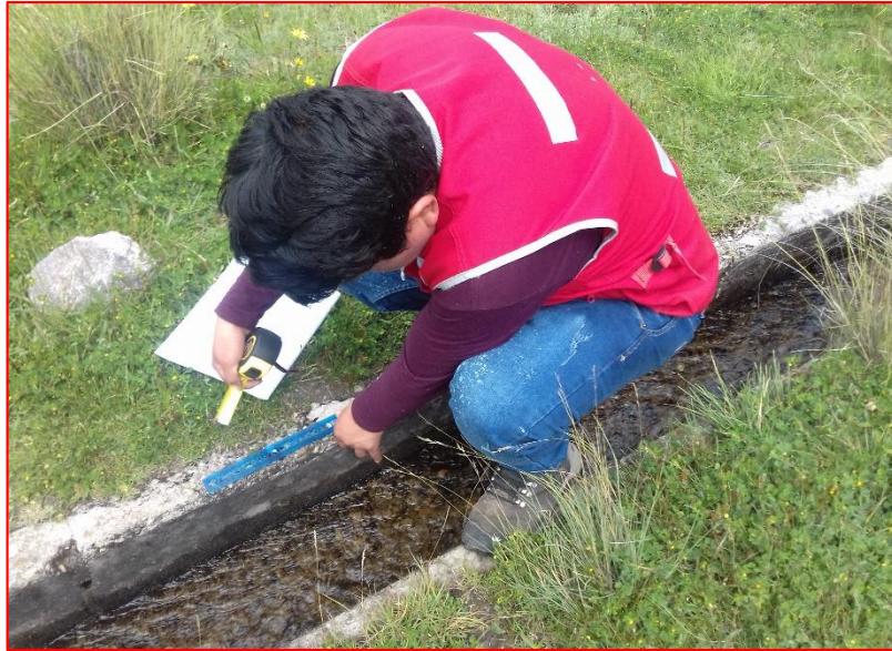
FOTO N° 05: VISTAS DE LAS TOMAS DE MEDIDAS DE LAS PATOLOGIAS EXISTENTES EN EL CANAL
