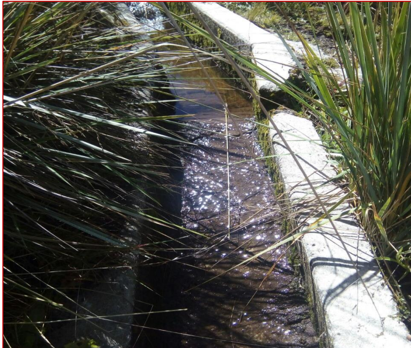
FOTO N° 01: VISTAS DE LA PATOLOGIA VEGETACION EN EL CANAL
