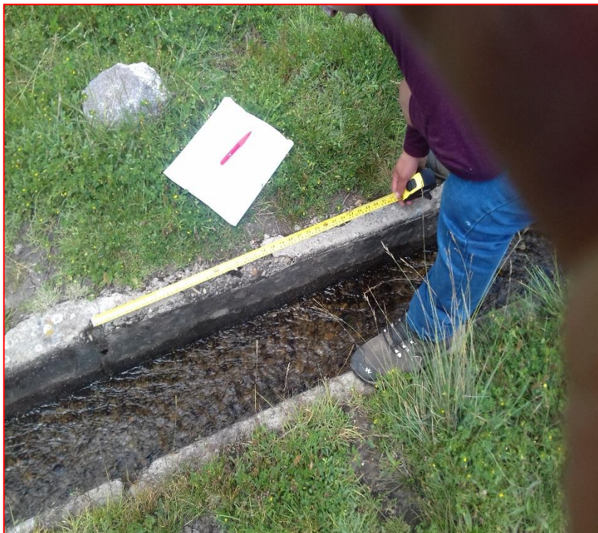
FOTO N° 06: VISTAS DE LAS TOMAS DE MEDIDAS DE LAS PATOLOGIAS EXISTENTES EN EL CANAL
