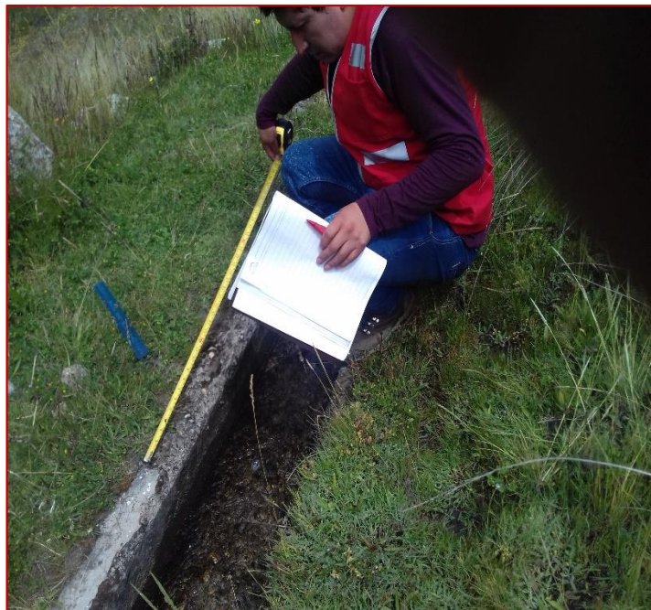
FOTO N° 04: VISTAS DE LAS TOMAS DE MEDIDAS DE LAS PATOLOGIAS EXISTENTES EN EL CANAL
