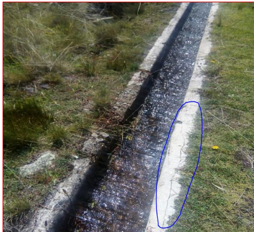
FOTO N° 02: VISTAS DE LAS PATOLOGIAS DESCASCAMIENTO Y FISURACION LONGITUDINAL EN EL CANAL
