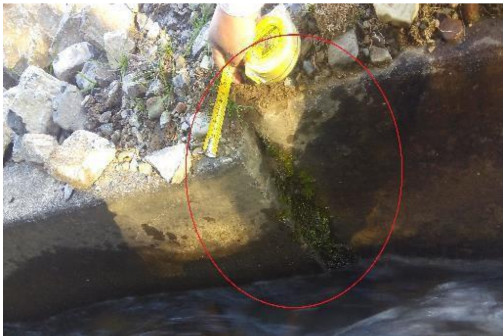
Fotografía 23: Se observa la patología desplazamiento de panel y humedad en el margen derecho de la unidad muestral 12.
