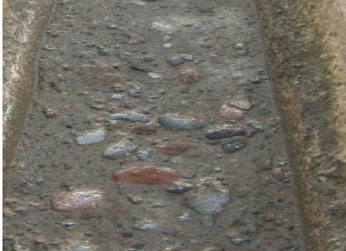
Figura 4. Erosión en canal. erosión en toda la sección.
