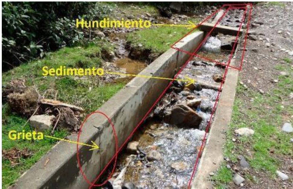
Fotografía 22: Se observa la patología hundimiento, sedimento y grieta de la unidad muestral 12.
