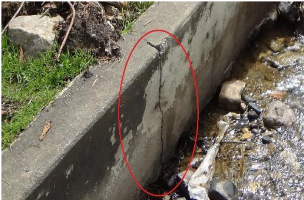
Fotografía 23: Se observa la patología grieta en el margen derecho de la unidad muestral 12.
