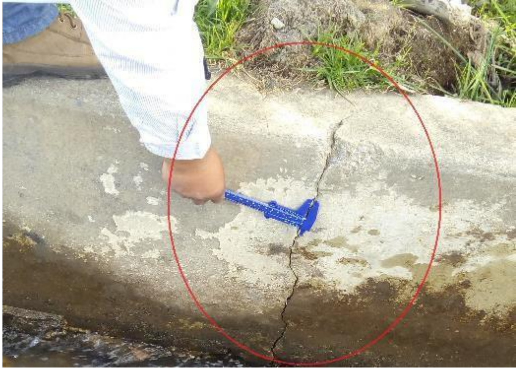
Fotografía 11: Se observa la patología grieta de la unidad muestral 6.
