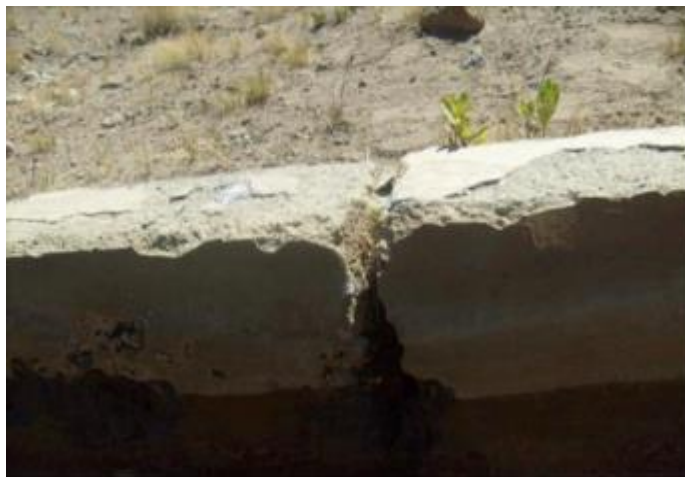
Figura 9. Mancha en el canal.
