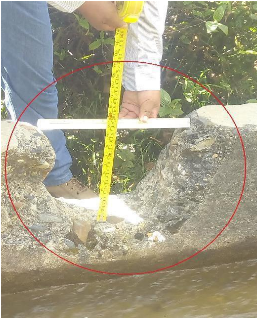
Fotografía 6: Se observa la patología impacto en el margen derecho.
