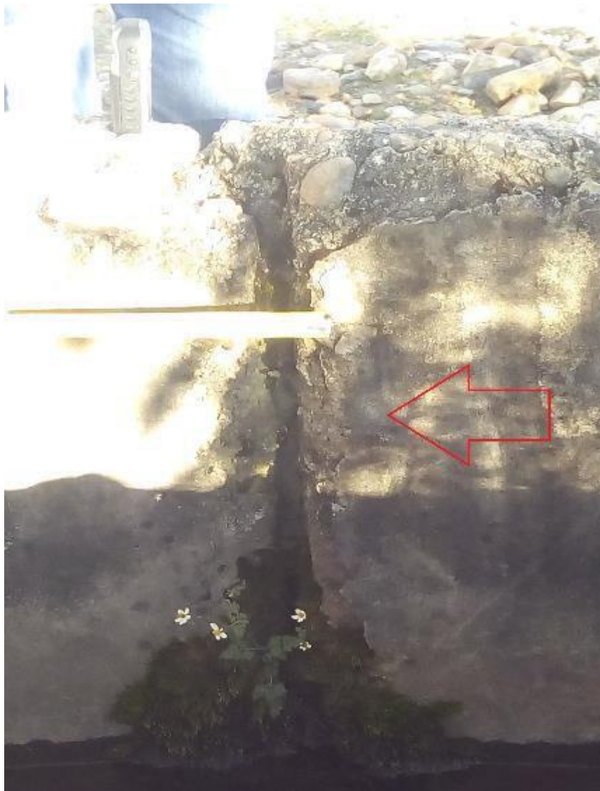
Fotografía 18: Se observa la patología sello de junta y vegetación, en la unidad muestral 11.
