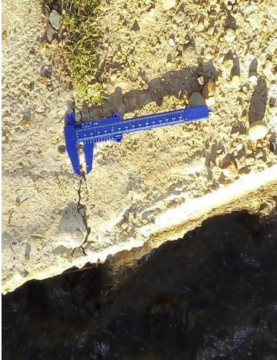
Fotografía 17: Se observa la patología sello de junta y descascaramiento en la unidad muestral 10.
