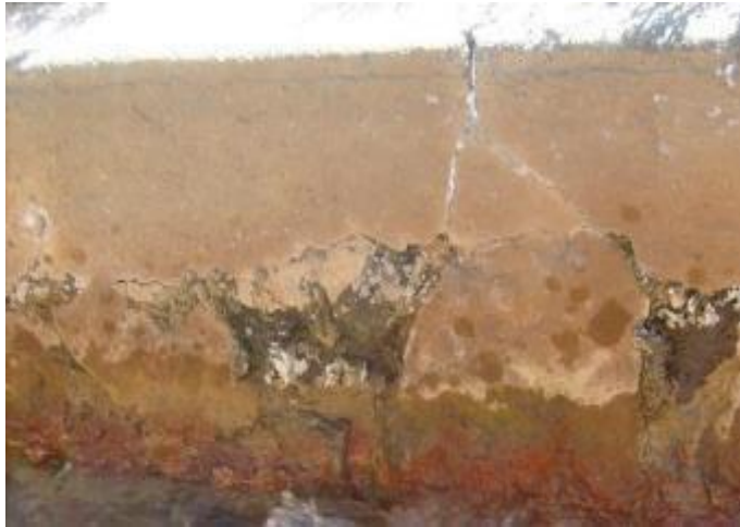
Figura 10. Descascaramiento del concreto.
