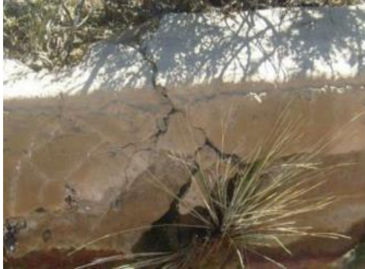
Figura 1. Grieta en el canal.
