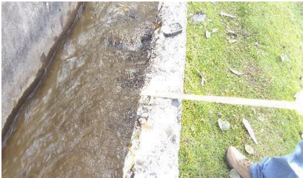
Fotografía 9: Se observa la patología descascaramiento en la unidad muestral 5.
