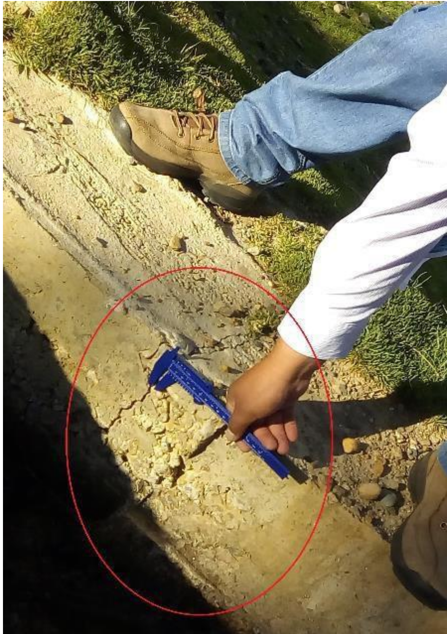
Fotografía 13: Se observa la patología grieta de la unidad muestral 7.
