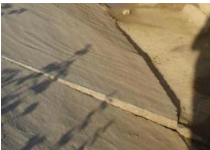
Figura 12. Desplazamiento de paneles
