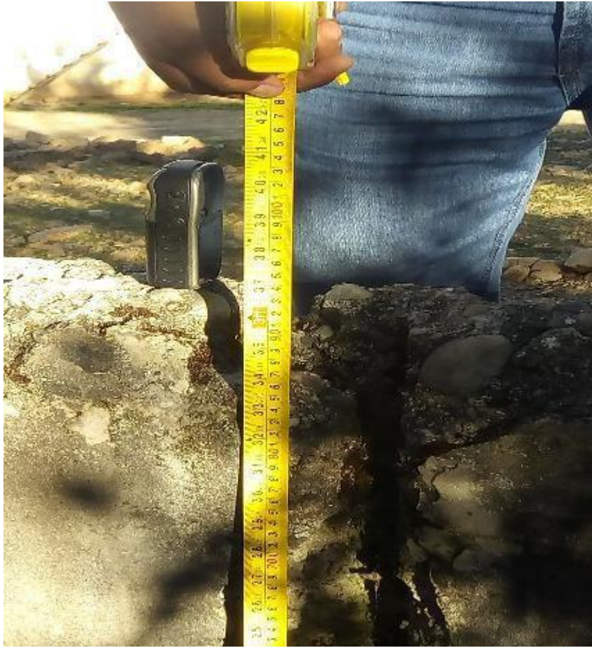
Fotografía 19: Se observa la patología sello de junta y descascaramiento, en la unidad muestral 11.
