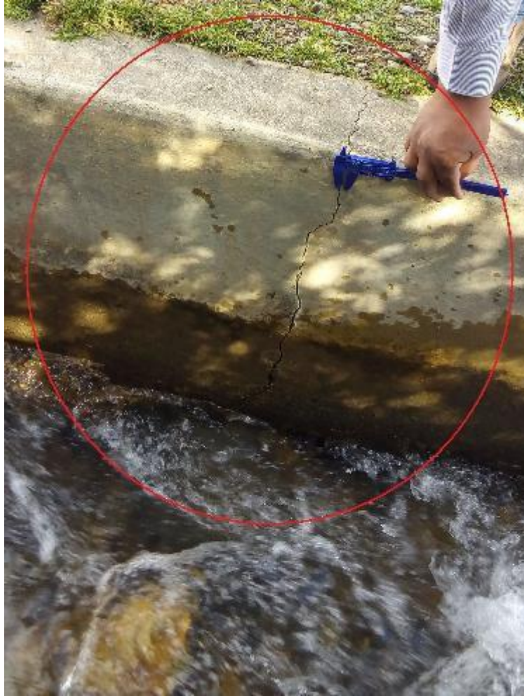
Fotografía 8: Se observa la patología grieta y sedimento.
