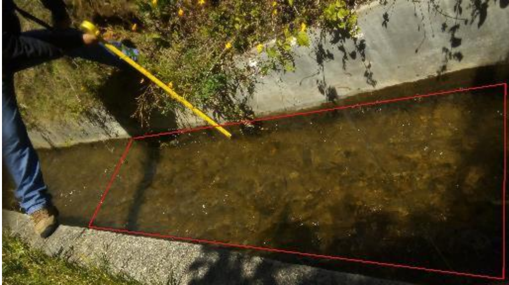
Fotografía 4: Se observa la patología en la losa de fondo del canal
