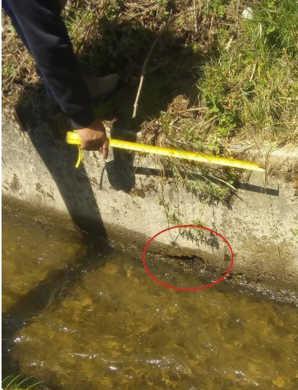
Fotografía 5: Se observa la patología erosión en el margen izquierdo.
