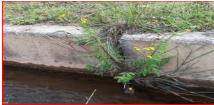
Imagen 10: Vegetación en canal de concreto.
