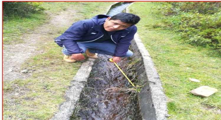
Imagen 13: Moho en el canal del concreto.
