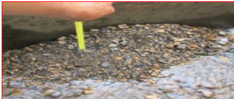
Imagen 12: Sedimentación en canal de concreto.
