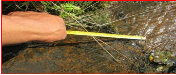
Imagen 11: Erosión en canal de concreto.
