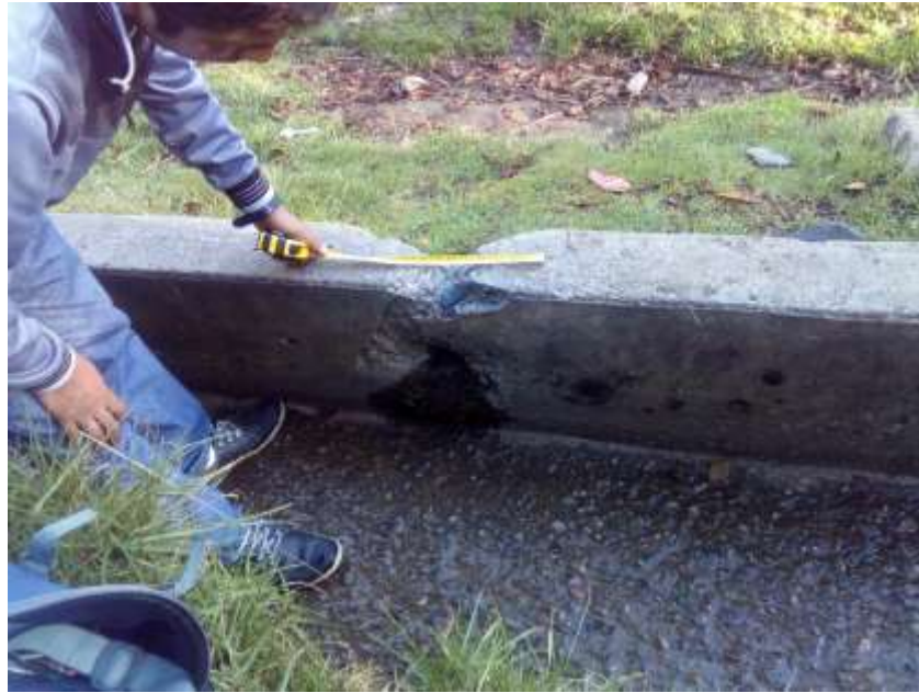
FOTO N° 03 - MEDICIÓN DE LAS PATOLOGÍAS MURO IZQUIERDO
