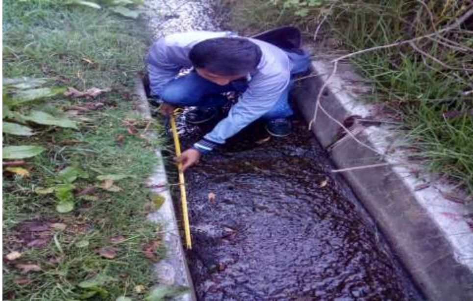
FOTO N° 01 - MEDICIÓN DE LAS PATOLOGÍAS MURO DERECHO
