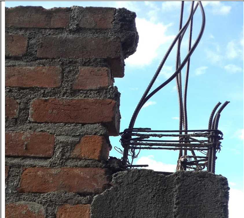
Fotografía 02: Oxidación en el fierro de la columna del cerco perimétrico del Centro de Salud de Tambillo, distrito Tambillo, provincia Huamanga, región Ayacucho.
