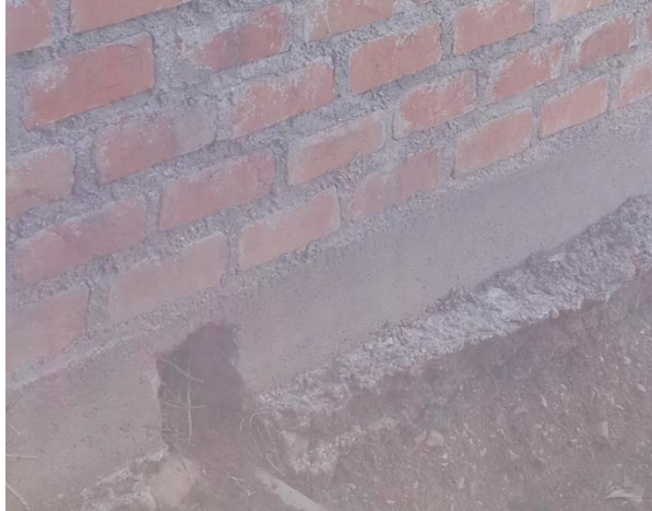
Figura 08: Picadura en los sobrecimiento.
