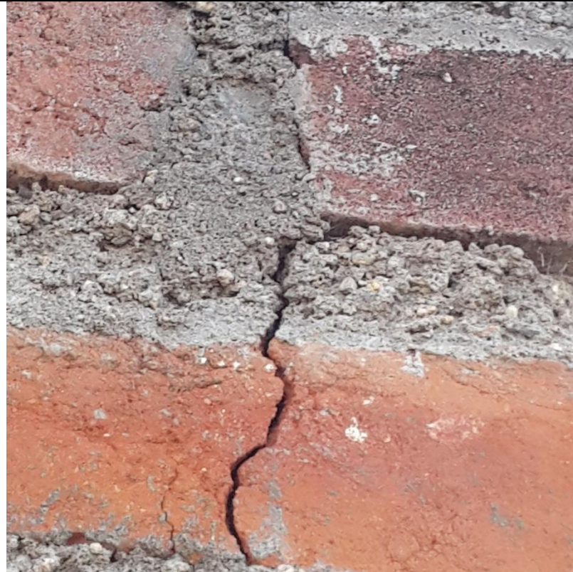
Fotografía 05: Grieta en muro del cerco perimétrico del Centro de Salud de Tambillo, distrito Tambillo, provincia Huamanga, región Ayacucho.
