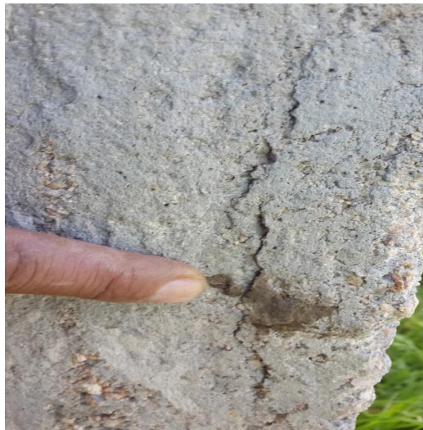
Figura 10: Desprendimiento en columna.
