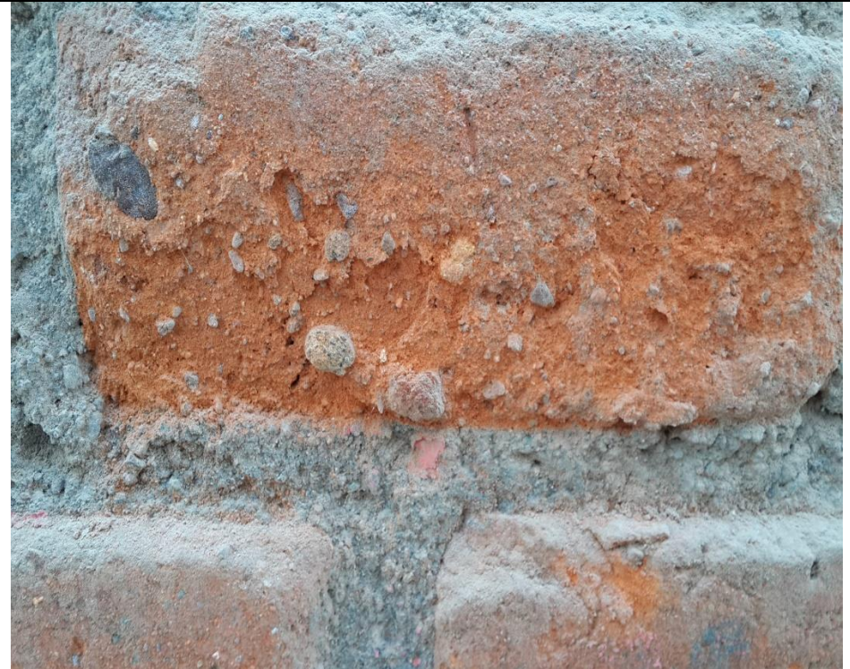
Fotografía 06: Erosión en muro del cerco perimétrico del Centro de Salud de Tambillo, distrito Tambillo, provincia Huamanga, región Ayacucho.
