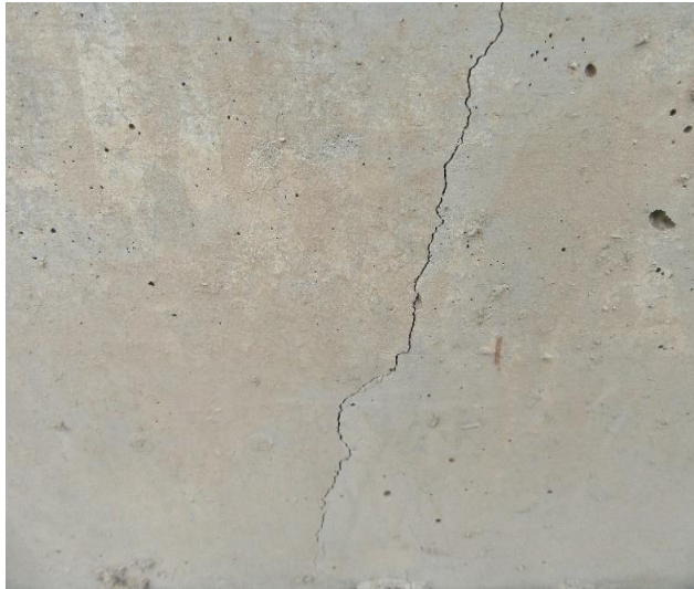
Figura 07. Fisuras en columna
