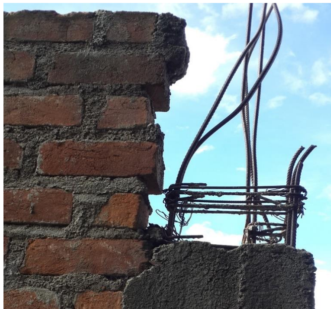
Figura 05: Oxidación en el acero de columna.
