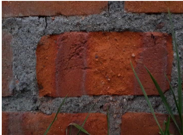
Figura 06: Erosión en muro
