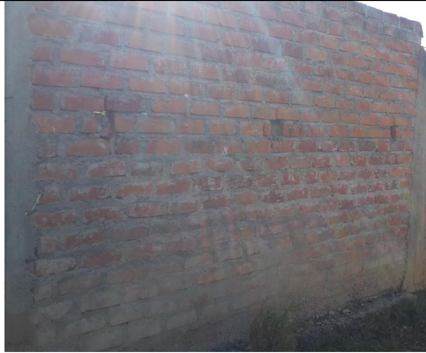
Fotografía 03: Picadura en muro del cerco perimétrico del Centro de Salud de Tambillo, distrito Tambillo, provincia Huamanga, región Ayacucho.
