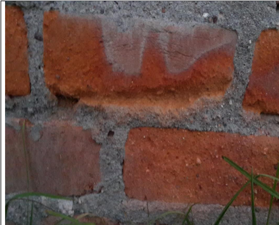
Fotografía 01: Erosión en muro del cerco perimétrico del Centro de Salud de Tambillo, distrito Tambillo, provincia Huamanga, región Ayacucho.
