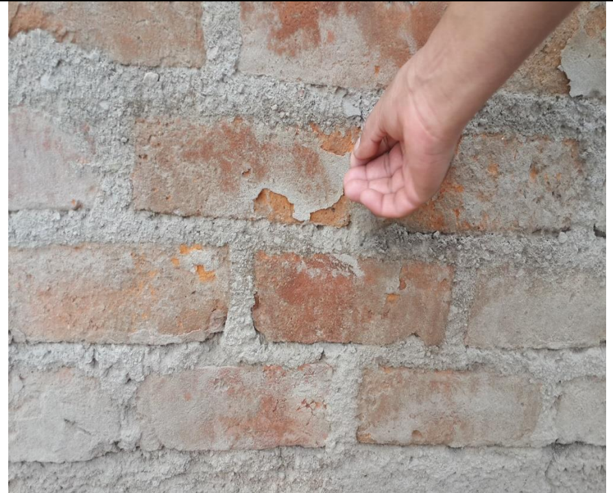
Fotografía 04: Desprendimiento en muro del cerco perimétrico del Centro de Salud de Tambillo, distrito Tambillo, provincia Huamanga, región Ayacucho.
