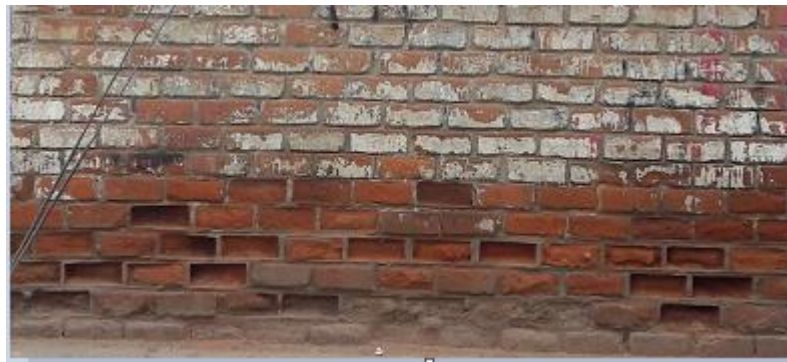
Imagen 1. Muro de albañilería afectada por la patología tipo Erosión.
