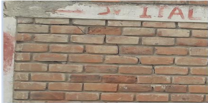
Imagen 3. Muro de albañilería afectada por la patología tipo Grieta.
