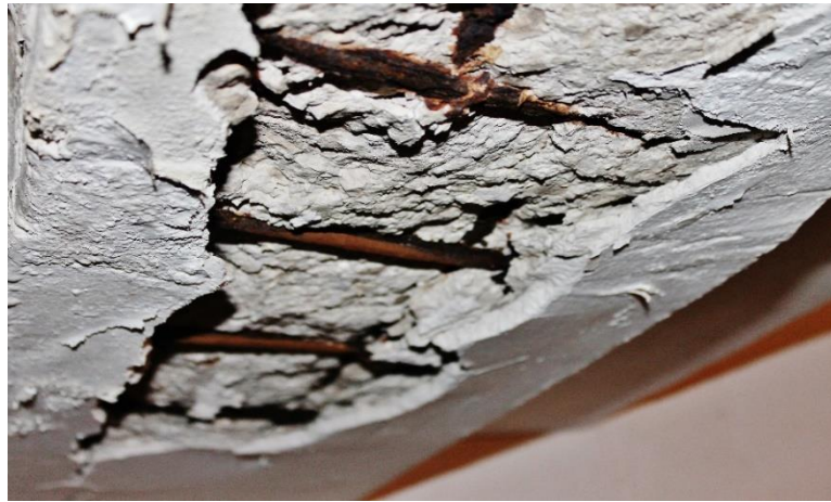
Imagen 2. Patología en viga de hormigón. Corrosión avanzada de armaduras.
