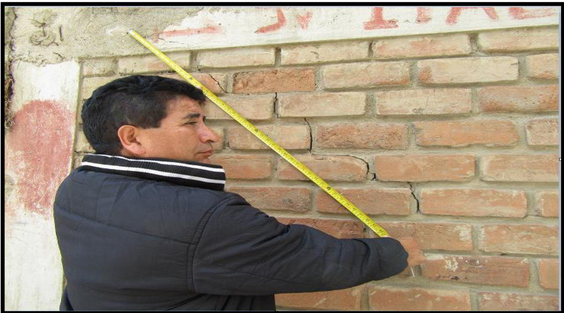
Fotografía 07: Vista medición de patología tipo grieta del muro de albañilería confinada del cerco perimétrico de la Unidad de Gestión Educativa Local de Huaraz.
