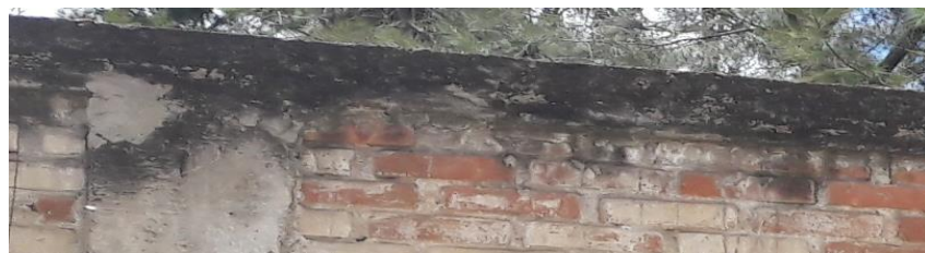
Figura 4. Viga y columna afectada por la patología tipo Mohos. Nota. Fuente: Elaboración Propia. (2018).
