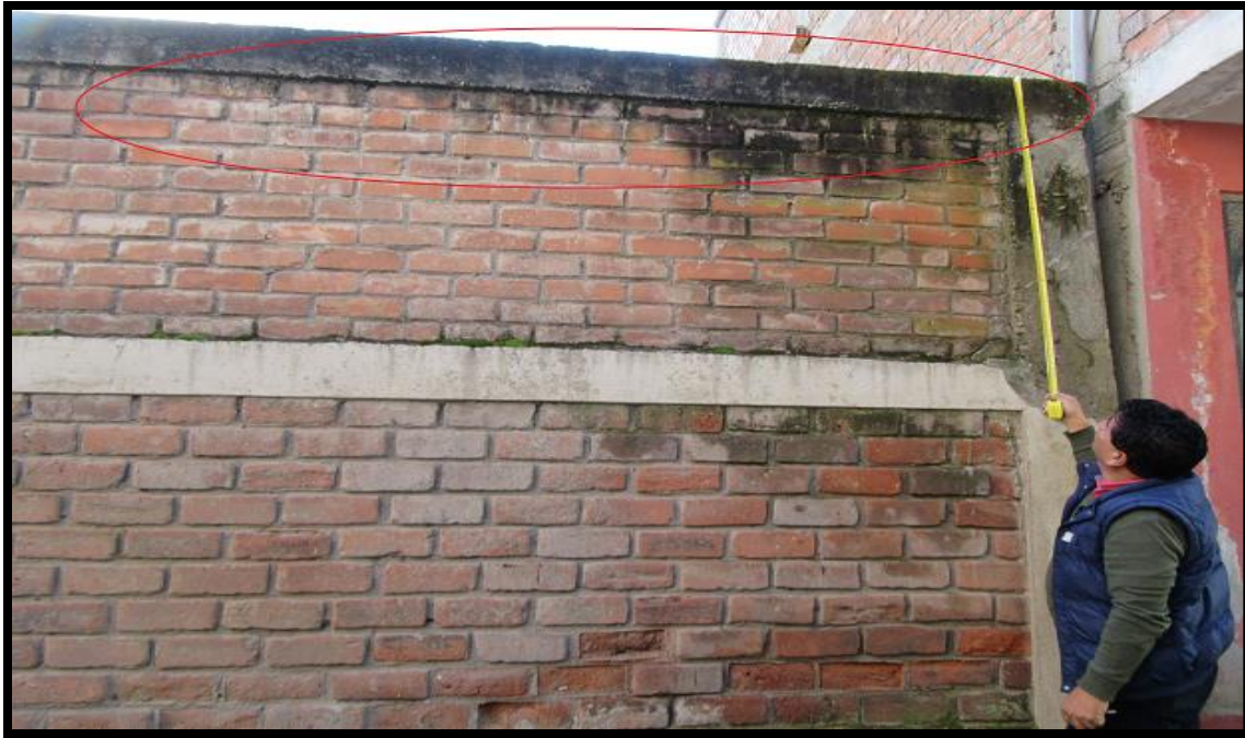
Fotografía 05: Vista de la patología tipo Moho en la viga, columna y unidades de albañilería del muro de albañilería confinada del cerco perimétrico de la Unidad de Gestión Educativa Local de Huaraz.
