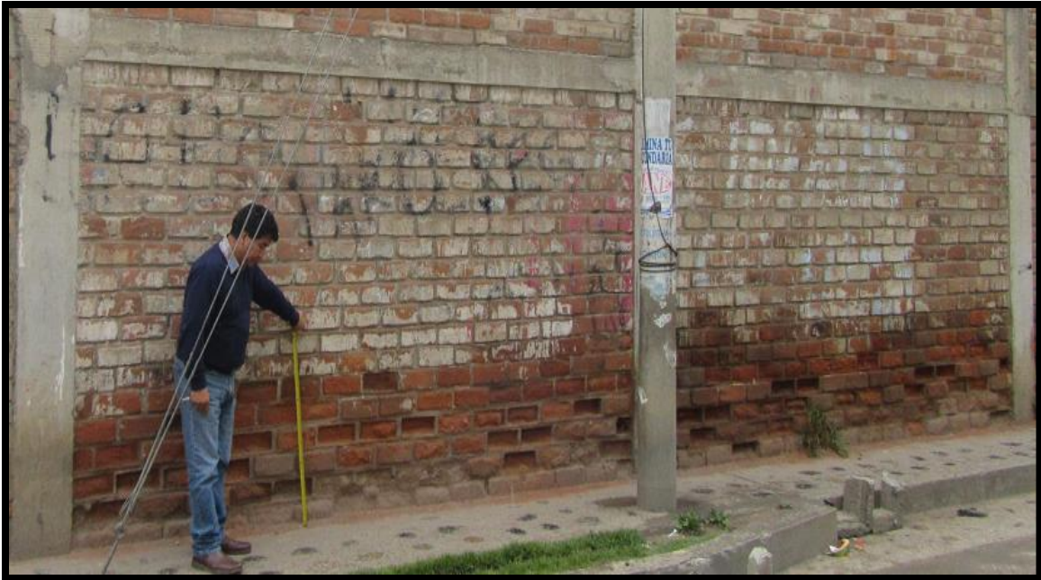
Fotografía 07: Vista medición de patología tipo Erosión del muro de albañilería confinada del cerco perimétrico de la Unidad de Gestión Educativa Local de Huaraz.
