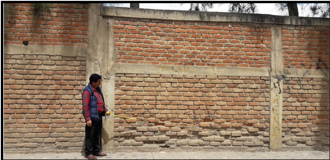
Fotografía 06: Vista de patología tipo Erosión del muro de albañilería confinada del cerco perimétrico de la Unidad de Gestión Educativa Local de Huaraz.
