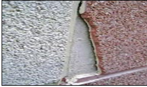
FIGURA 17: Desprendimiento de muro
