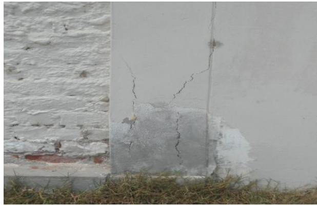
Figura 16. Fisura en columna
