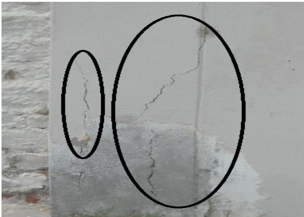
Fotografía 8: Albañilería confinada afectada por fisura en la columna
