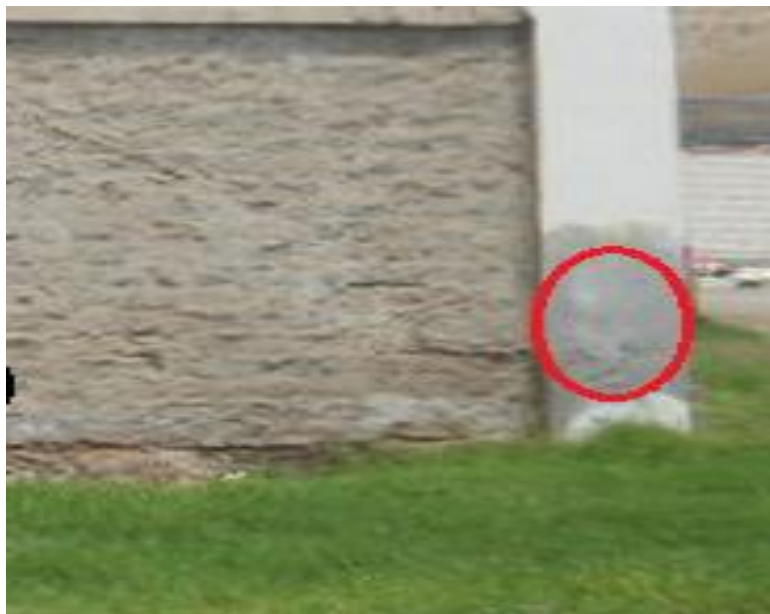
Fotografía 6: Muro de albañilería confinada por eflorescencia
