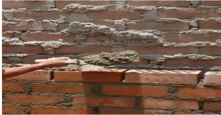
Figura 4. Albañil realizando la colocación del mortero para la colocación del ladrillo de un muro de albañilería.
