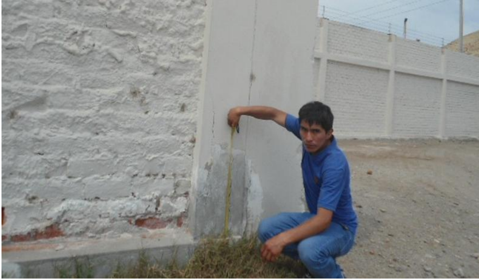
Fotografía 9: tomando datos en la columna, patología la eflorescencia
