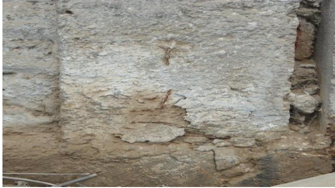
Figura 18. Oxidación en los estribos de la columna. Nota. Fuente: Elaboración propia (2018).
