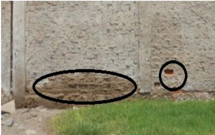
Fotografía 5: Muro de albañilería confinada por erosión
