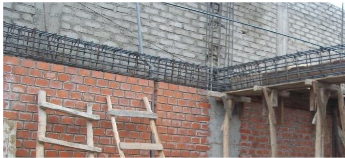
Figura 9. Armadura y encofrado de vigas de concreto armado. Nota. Fuente: Yraitá, A. (2016).
