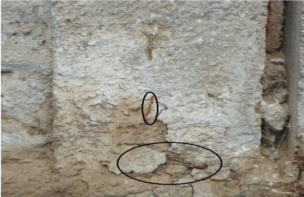
Fotografía 7: Albañilería confinada afectada corrosión en la columna
