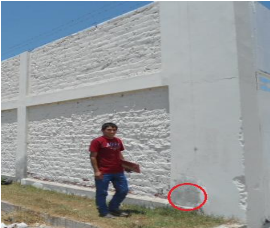
Fotografía 10: Albañilería confinada afectada por eflorescencia
