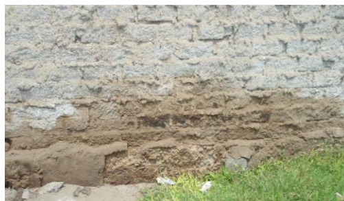
Figura 14. Erosión de un nivel alto en muro de albañilería Nota. Fuente: Elaboración propia (2018)
