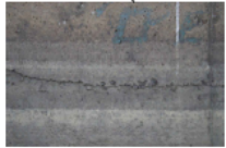
Fisuras menores de 1.5mm de separación
