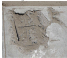
Desprendimiento del concreto, con exposición de las armaduras
