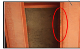
Corrosión superficial y se han formado o están por formarse picaduras superficiales
