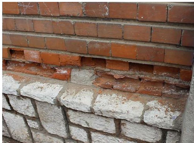
Figura 09. Erosión física en muros. Nota Fuente: Colorificio San Marco. (2012)
