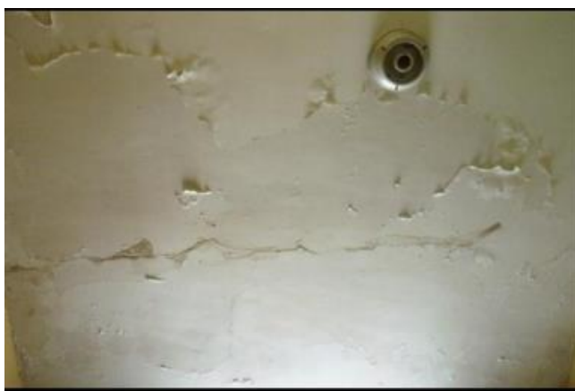
Figura 02. Interior de techo baño con rajaduras notorias. Nota Fuente: Ascasibar R. (2012)
