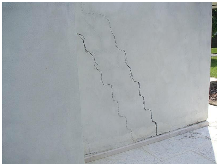
Figura 10. Grieta en muro.
