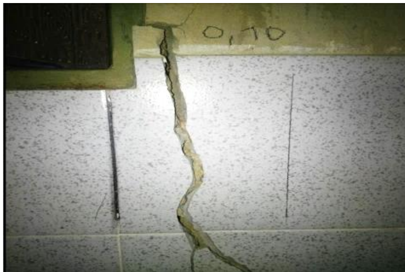
Figura 01: grietas al interior del baño. Fuente: Ciro R y Jiménez W (2017)
