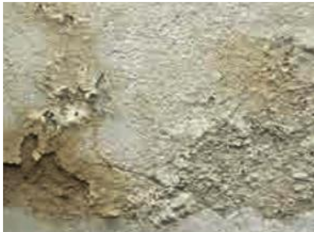
Figura 11. Eflorescencia en muros Nota Fuente: Colorificio San Marco. (2012)
