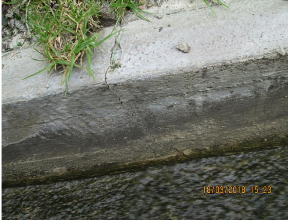
Vista de patologías del canal de riego de Huarmey en el tramo (5+000 - 5+020)
