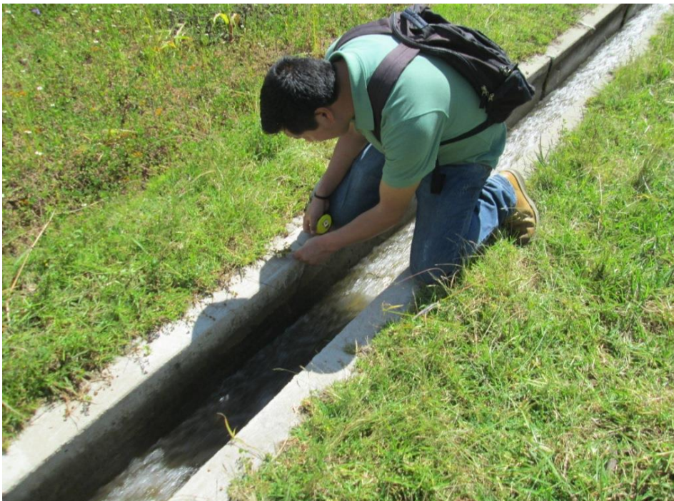
Vista de toma de datos de grietas, fisuras y eflorescencia para la evaluación del canal de riego.
