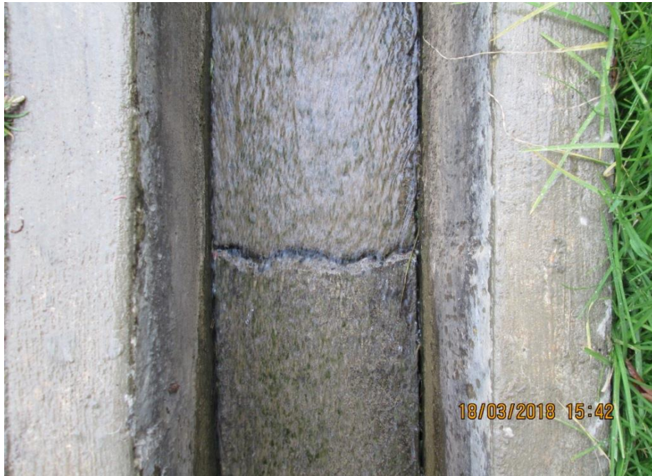
Vista de patologías del canal de riego de Huarmey en el tramo (5+460 - 5+480)
