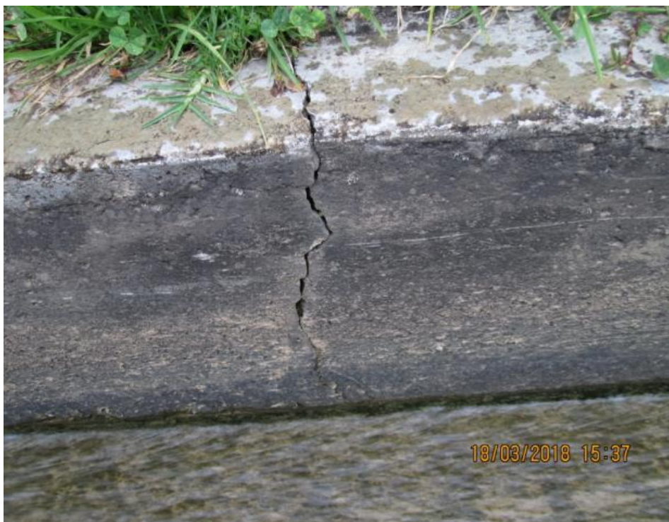
Vista de patologías del canal de riego de Huarmey en el tramo (5+220 - 5+240)
