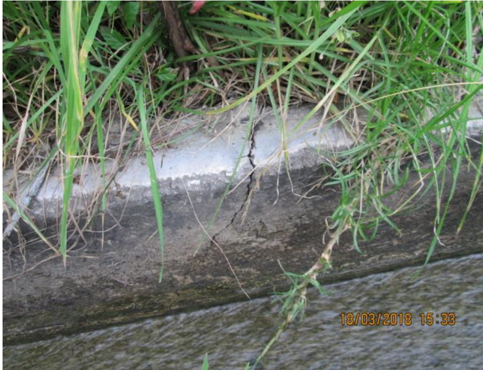
Vista de patologías del canal de riego de Huarmey en el tramo (5+160 - 5+180)
