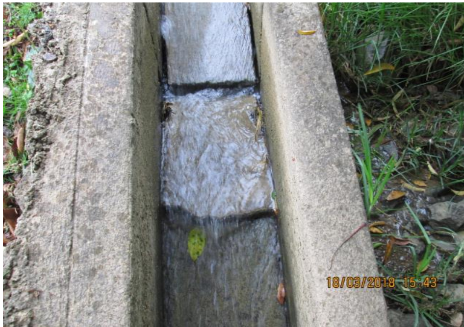
Vista de patologías del canal de riego de Huarmey en el tramo (5+620 - 5+640)
