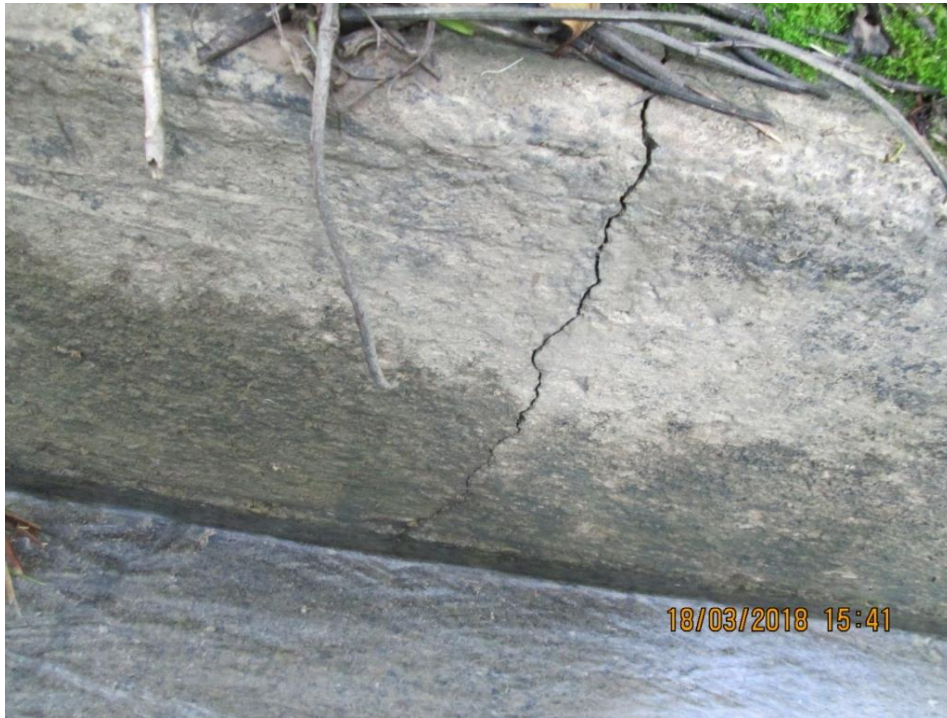
Vista de patologías del canal de riego de Huarmey en el tramo (5+300 - 5+320)
