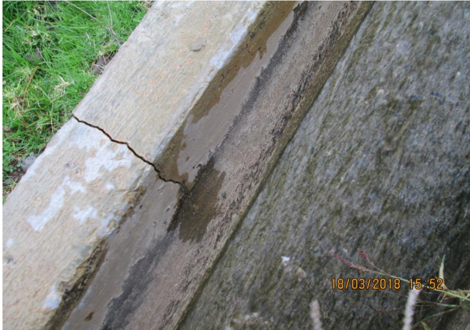
Vista de patologías del canal de riego de Huarmey en el tramo (5+700 - 5+720)
