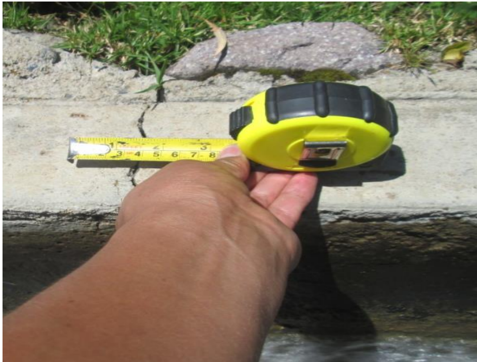
Vista de toma de datos de las patologías del canal de riego de Huarmey en el tramo (5+840 - 5+860)
