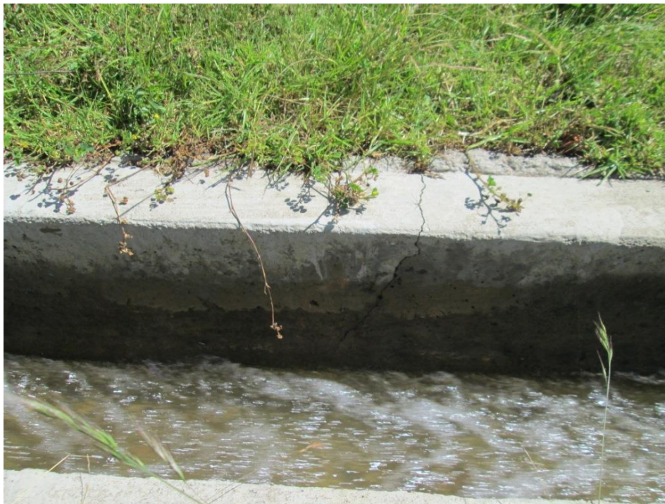
Vista de las patologías del canal de riego de Huarmey en el tramo (5+920 - 5+940)
