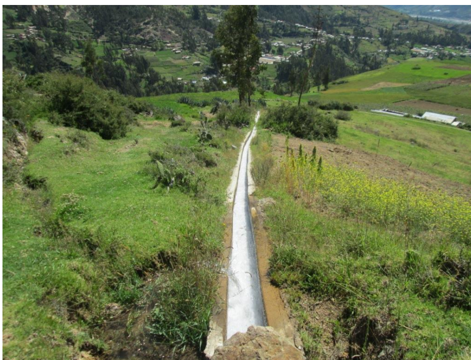
Vista del canal de riego de Huarmey, donde se puede ver la gran pendiente que tiene en ciertos tramos para que ocurra mayor erosión.
