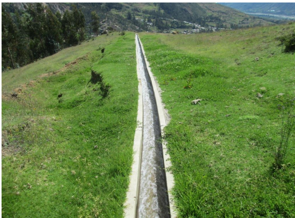
Vista del canal de riego de Huarmey, donde se puede ver la gran pendiente que tiene en ciertos tramos y de esta manera se da en mayor grado la erosión en estos puntos.
