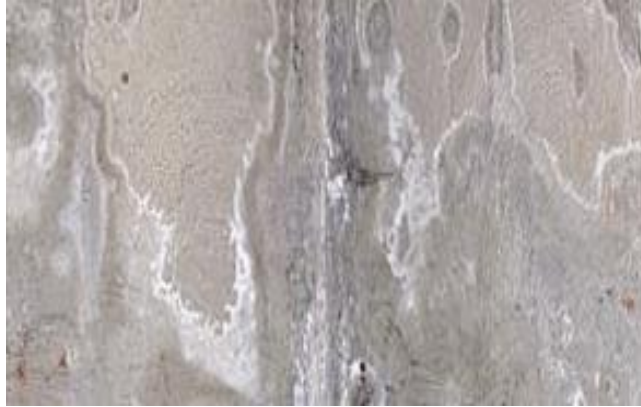
Figura 6. Daño por eflorescencia.
