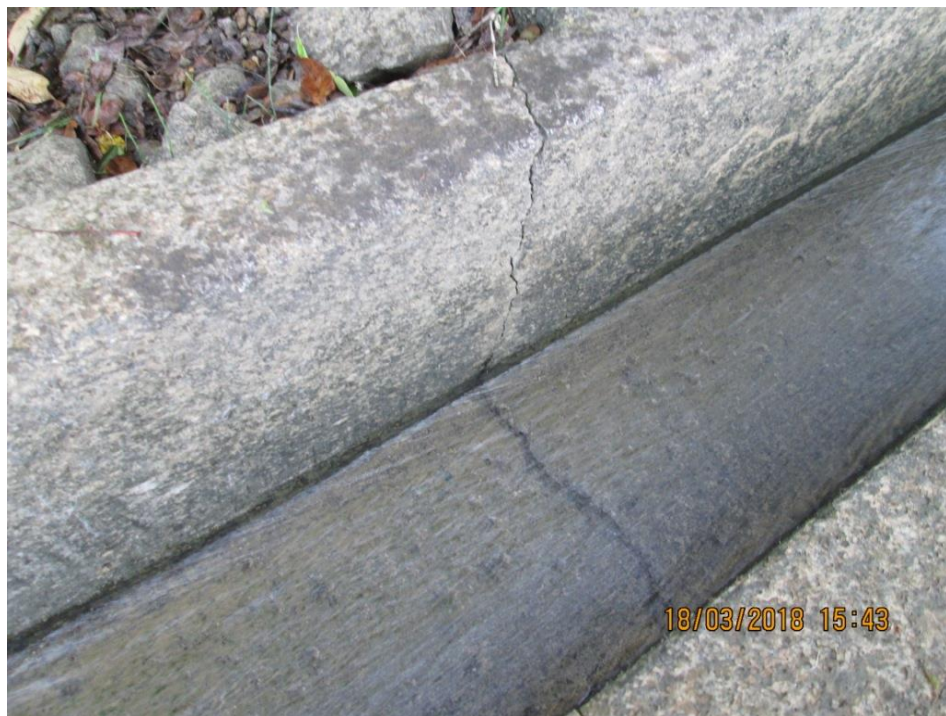
Vista de patologías del canal de riego de Huarmey en el tramo (5+540 - 5+560)
