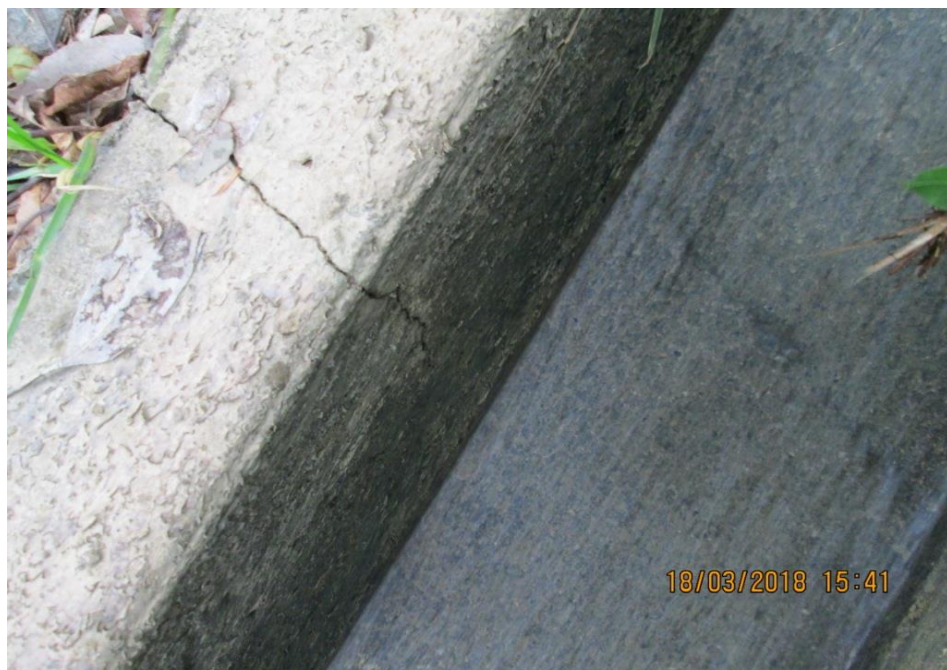
Vista de patologías del canal de riego de Huarmey en el tramo (5+380 - 5+400)
