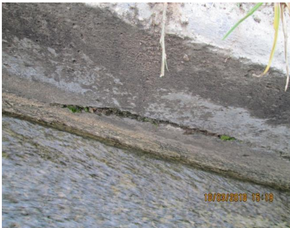
Vista de patologías del canal de riego de Huarmey en el tramo (5+080 - 5+100)
