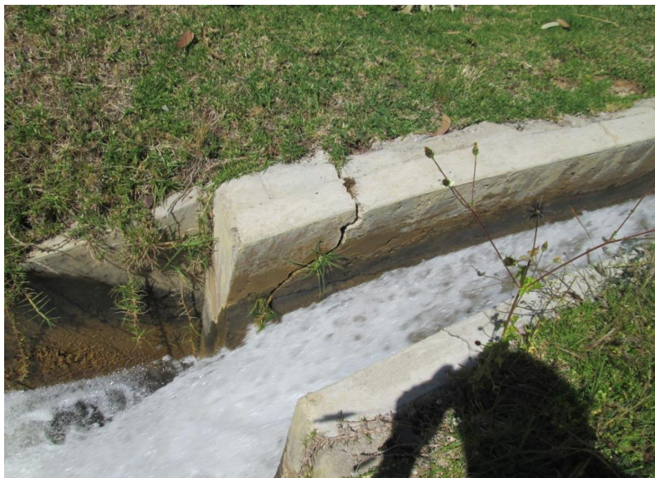
Vista de las patologías del canal de riego de Huarmey en el tramo (5+980 - 6+000)
