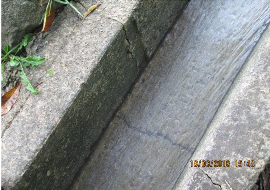
Vista de patologías del canal de riego de Huarmey en el tramo (5+540 - 5+560)
