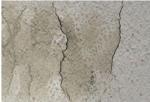
Figura 4. Daño por fisuras.
