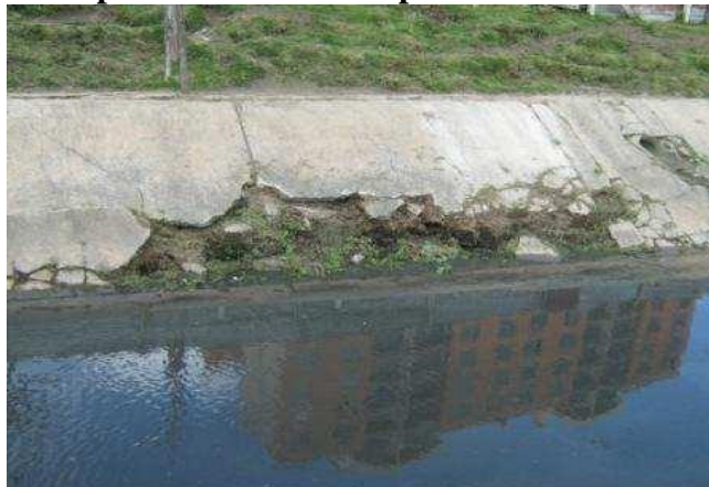
Figura 3. Daño por Erosión de la superficie.
