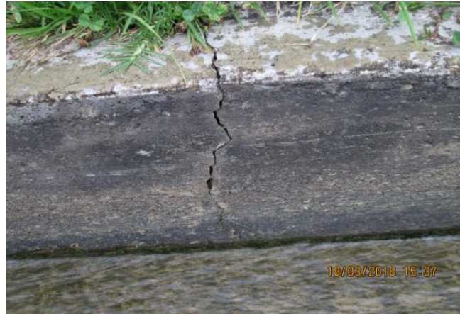
Figura 5. Daño por agrietamiento en canales.
