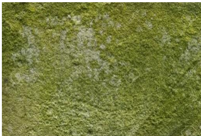
Figura 7. Daño por vegetación.
