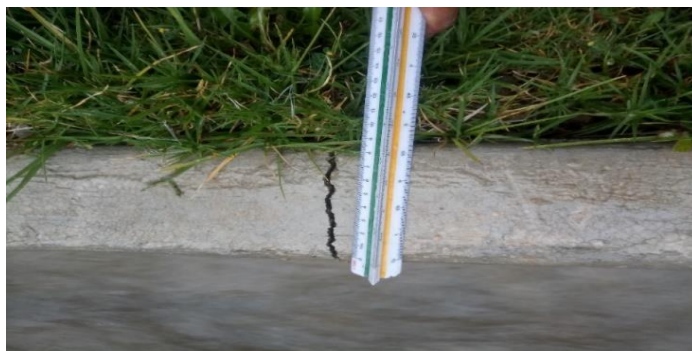
Figura 11. Fisura en el muro del canal.
