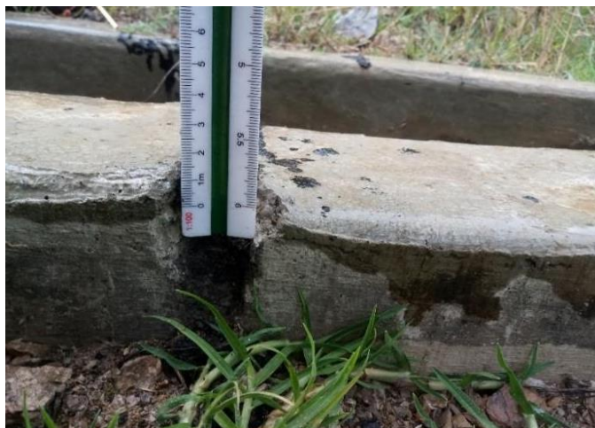
Figura 14. Hundimiento en el muro del canal.
