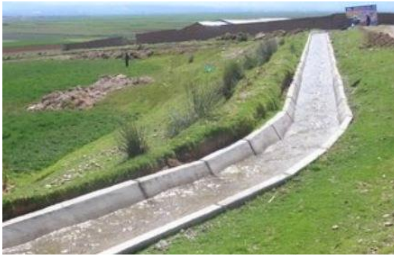
Figura 3. Canal de riego - Ancash.
