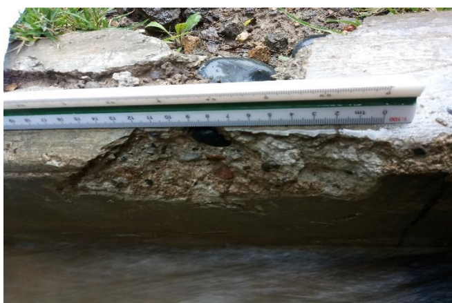
Figura 15. Impactó en el muro del canal.
