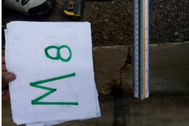
Figura 10: Grieta en muro del canal
