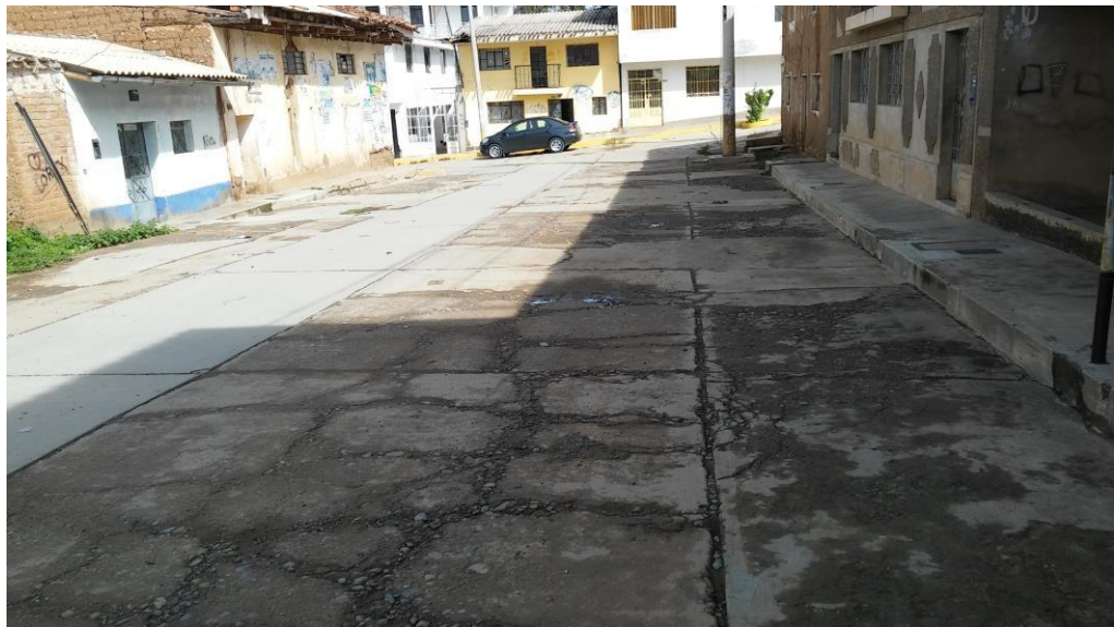
FOTOGRAFÍA N° 06: Se observa el tipo de patología denominada losa dividida, pulimiento de agregados en Jr. Soledad
