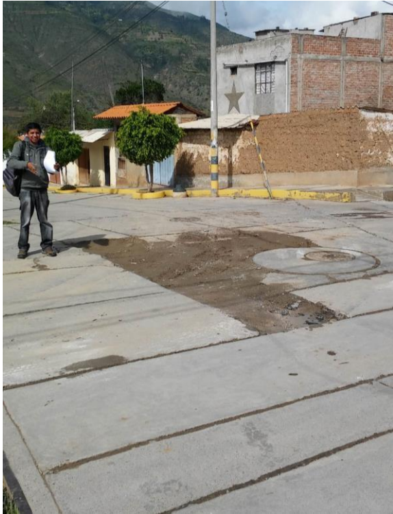
FOTOGRAFÍA N° 04: Se observa el tipo de patología denominada desnivel de Carril en Jr. Soledad
