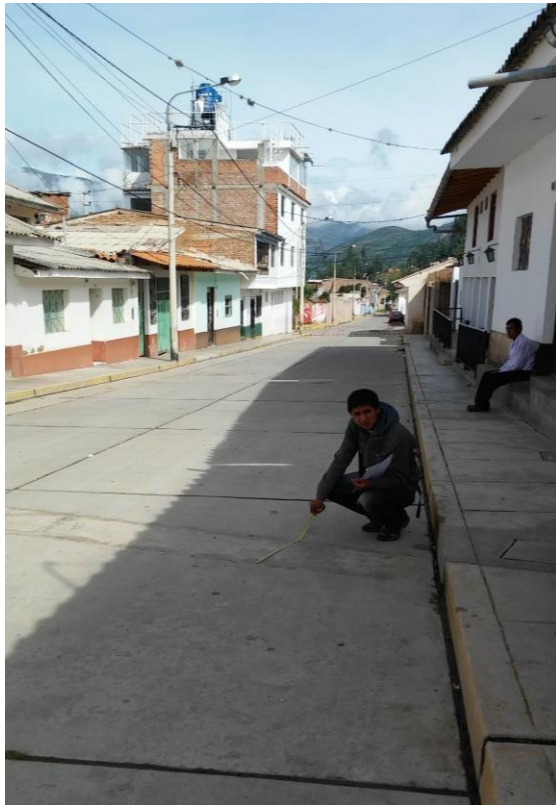
FOTOGRAFÍA N° 10: Se observa el tipo de patología denominada parche grande en Jr. Santa Rosa
