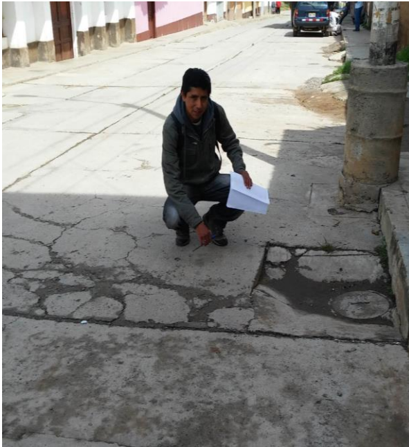
FOTOGRAFÍA N° 13: Se observa el tipo de patología denominada losa dividida en Jr. Brazil
