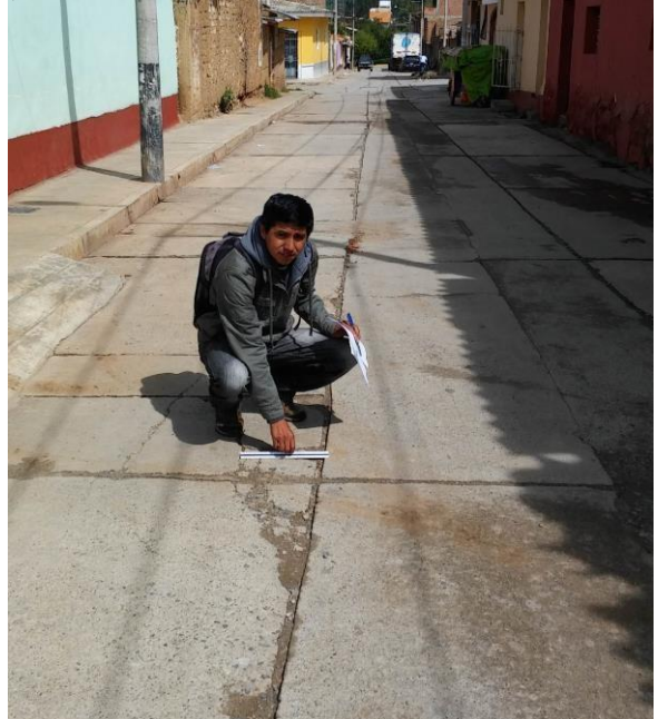
FOTOGRAFÍA N° 14: Se observa el tipo de patología denominada pulimiento de agregados en Jr. Brazil
