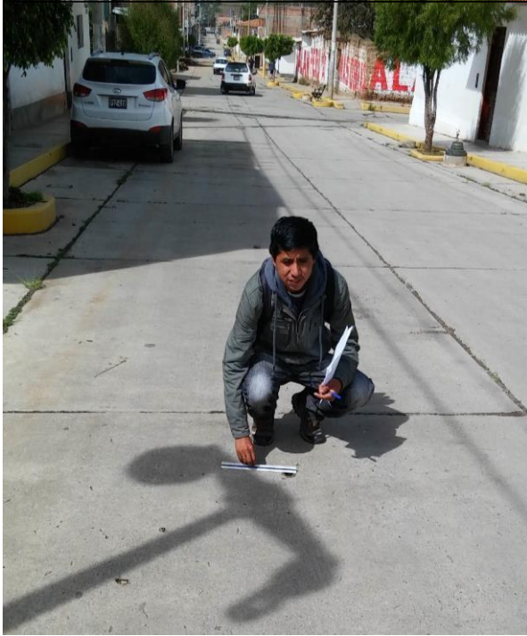
FOTOGRAFÍA N° 07: Se observa el tipo de patología denominada Pulimento de Agregados en Jr. Comercio
