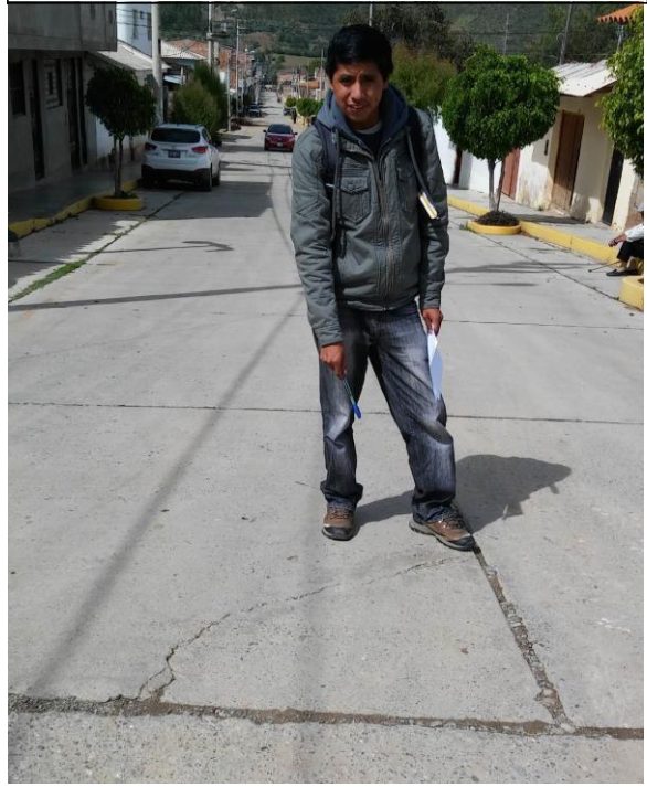
FOTOGRAFÍA N° 08: Se observa el tipo de patología denominada grietas de esquina en Jr. Comercio
