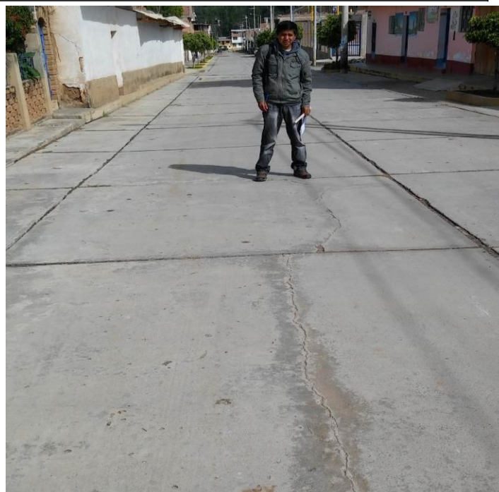
FOTOGRAFÍA N° 12: Se observa el tipo de patología denominada grieta lineal en Jr. Santa Rosa
