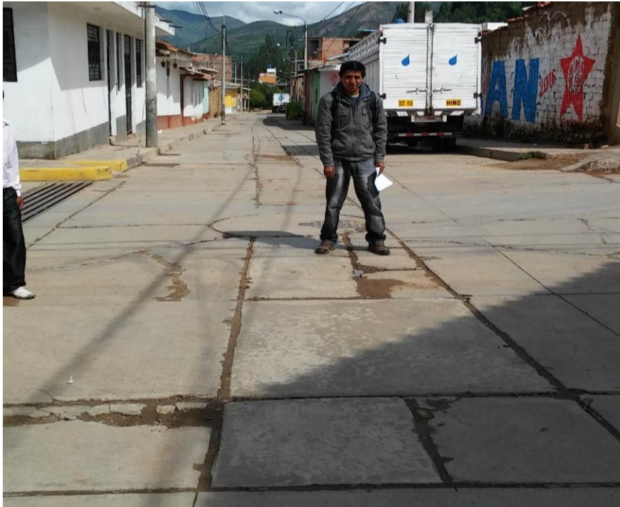
FOTOGRAFÍA N° 09: Se observa el tipo de patología denominada desnivel de carril en Jr. Comercio
