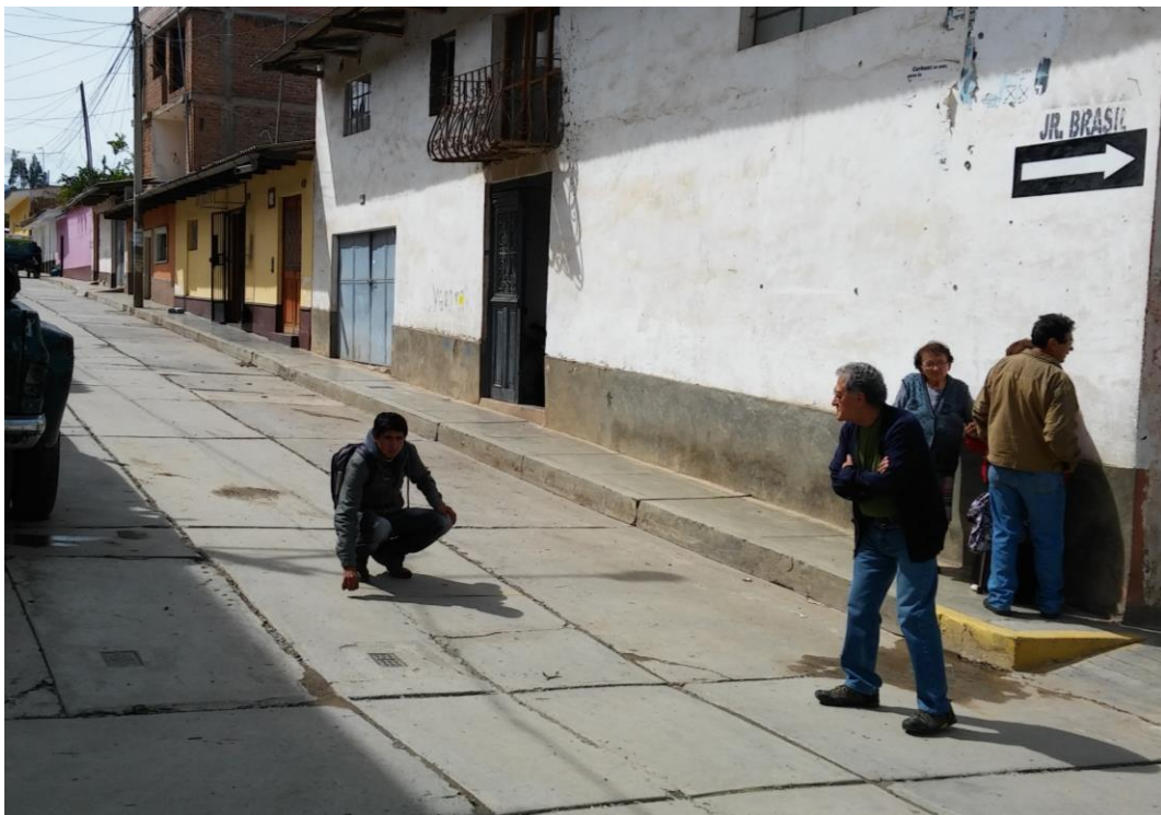
FOTOGRAFÍA N° 15: Se observa el tipo de patología denominada grieta lineal en Jr. Brazil
