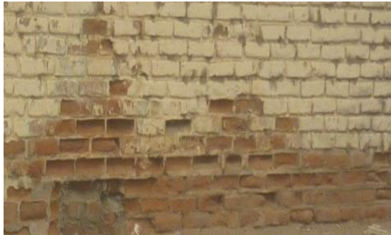
Figura 17. Erosión Química en Muro de albañilería Nota. Fuente: (Broto C. 2005) 22
