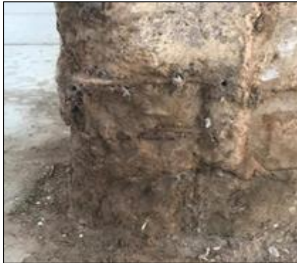
Figura 14. Patología del concreto Nota. Fuente: (Reilly V. 2008) 19
