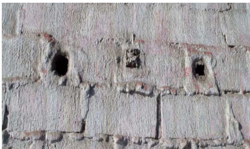
Figura 16. Erosión Mecánica en Albañilería
