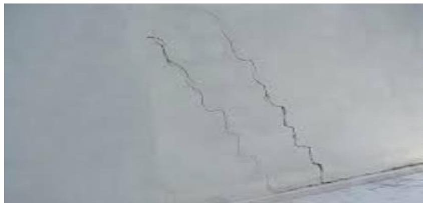
Figura 18. Fisura Nota. Fuente: (Rodríguez E. 2006) 23
