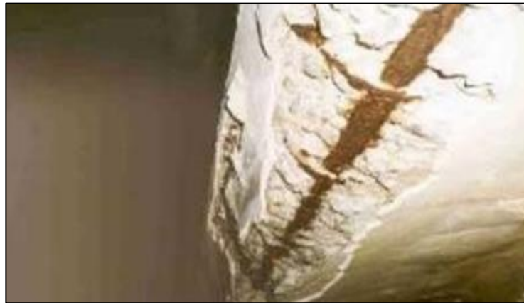
Figura 20. Corrosión Nota. Fuente: (Casas O. 2001) 24
