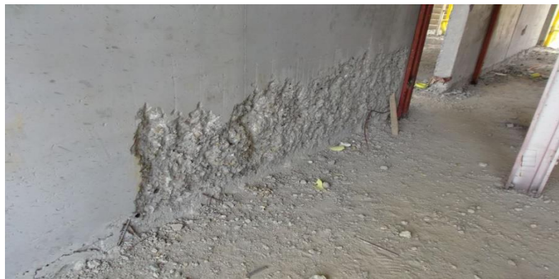
Figura 17.erosión en muro de albañilería Nota. Fuente: (Astorga y Rivero) 17
