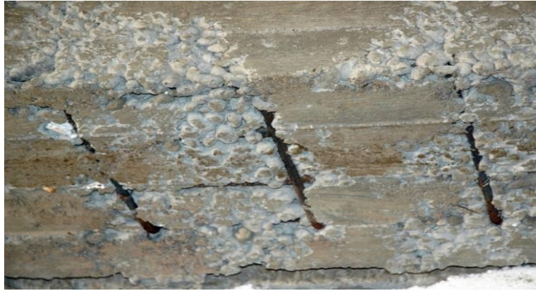
Figura 11. Segregación del mortero Nota. Fuente: (Soto J. 2004) 13
