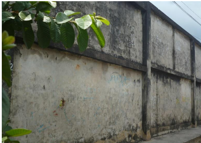
Figura 15. Patología Moho Nota. Fuente: (Elaboracion Propia)
