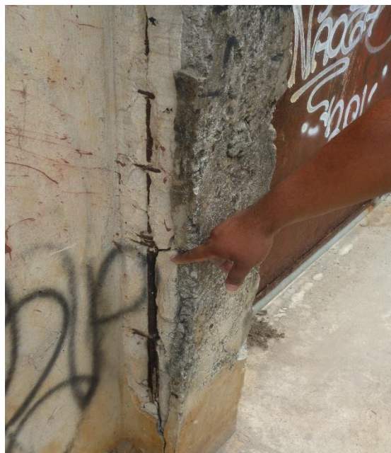
Figura 22. Corrosión en columna Nota. Fuente: (Elaboracion Propia)
