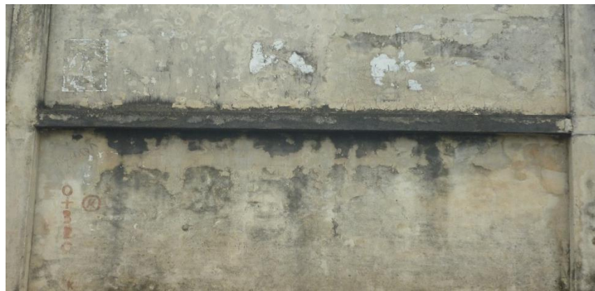
Figura 23. Moho en viga de muro confinado Nota. Fuente: (Elaboracion Propia)
