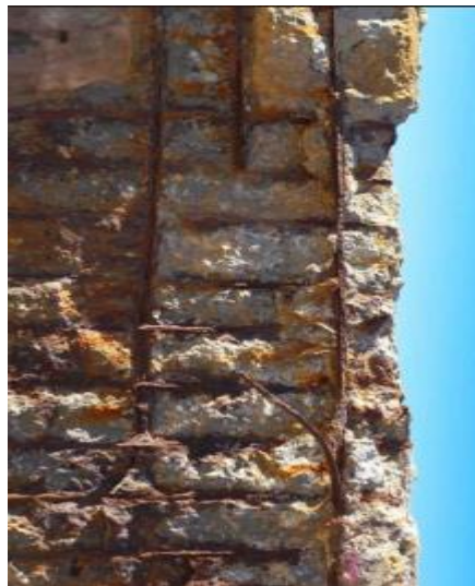
Figura 16. corrosión en columna Nota. Fuente: (Rivva E. 2006) 15
