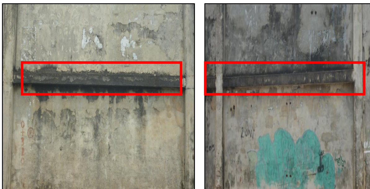
Fotografía 02: Patología Moho en la viga del cerco perimétrico
