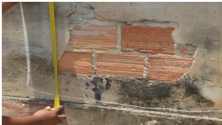
Figura 21.Desprendimiento en muro Nota. Fuente: (Elaboracion Propia)
