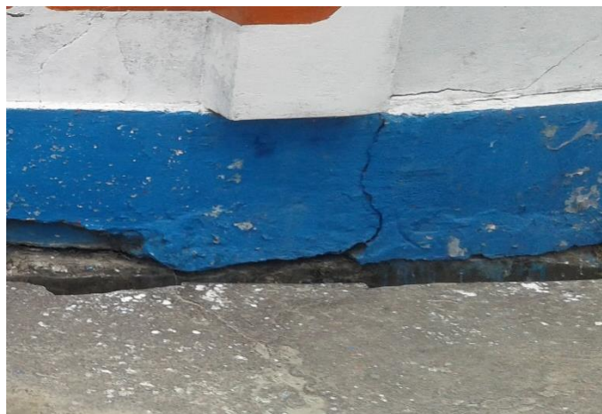
Figura 20. Grieta en sobrecimiento Nota. Fuente: (Elaboración Propia)
