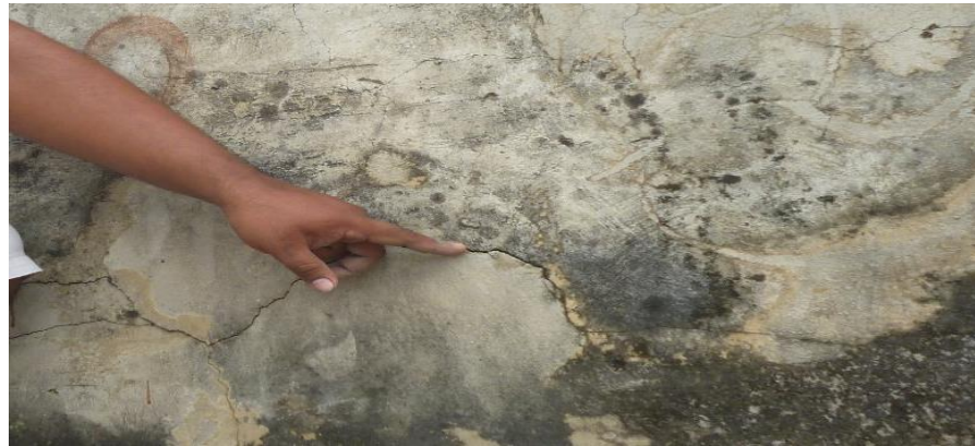
Figura 19. Fisura en Muros de albañilería Nota. Fuente: (Elaboracion Propia)
