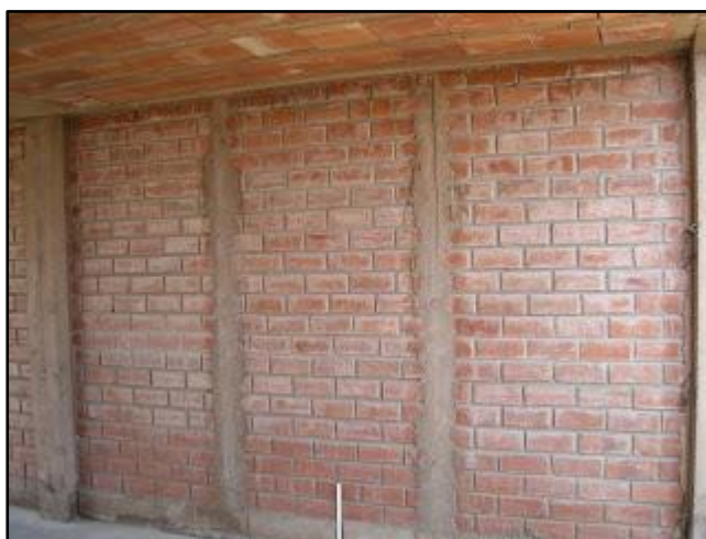
Figura 7. Muro confinado Nota. Fuente: (Flores F. 2014) 11
