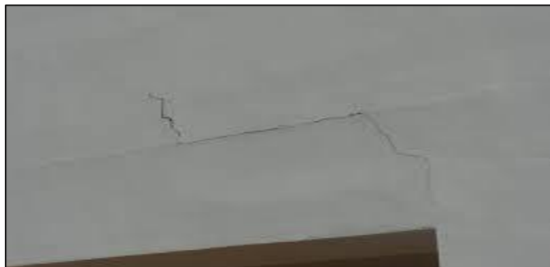
Figura 15. Fisura Nota. Fuente: (Florentín y Granada 2009) 23
