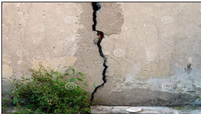
Figura 14. Grieta en muro Nota. Fuente: Enciclopedia Broto. 2004) 24
