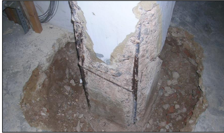
Figura 16. Corrosión en columnas Nota. Fuente: (Florentín y Granada 2009) 23
