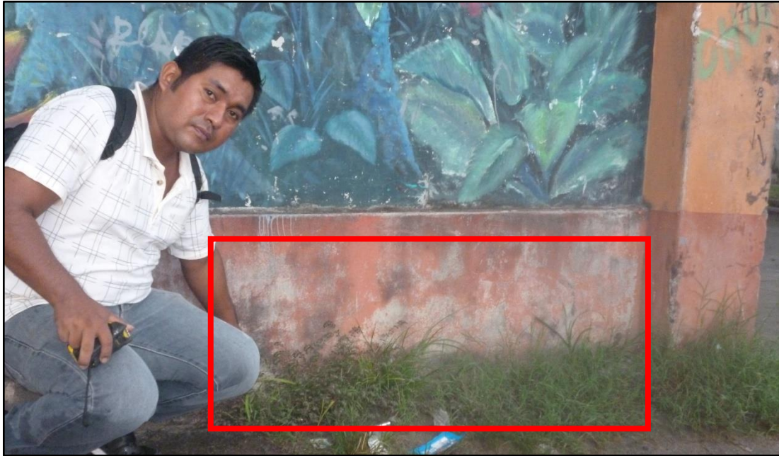
Fotografía 05: Patología Organismos Identificado en el Muro confinado
