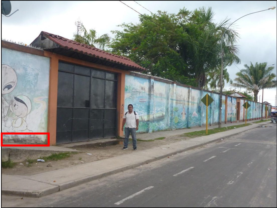
Fotografía 09: Patología Eflorescencia Identificado en el Muro confinado
