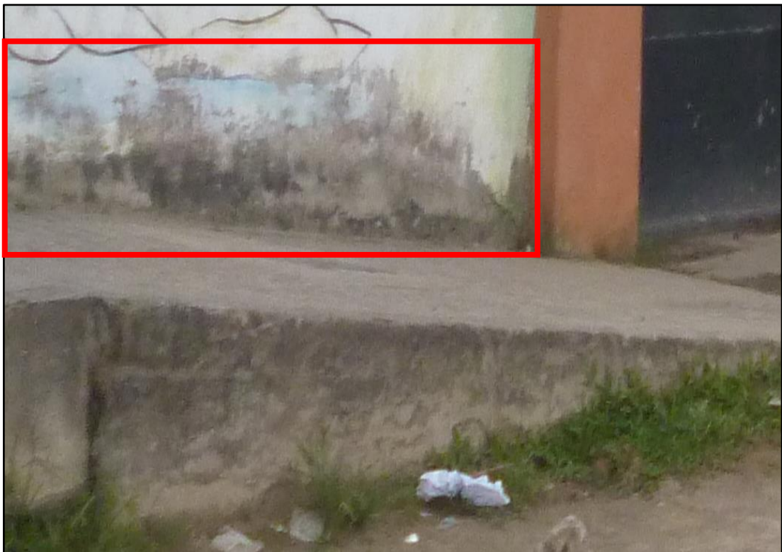
Fotografía 10: Patología Eflorescencia Identificado en el Muro confinado
