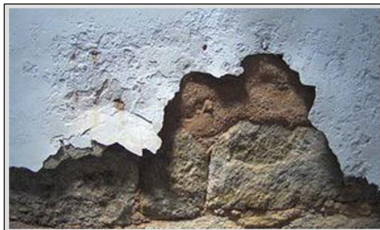
Figura 16. Erosión en muro de albañilería Nota. Fuente: (Ramos I. 2013) 18
