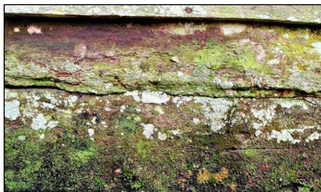
Figura 34. Moho en muro Nota. Fuente: (Elaboración Propia)
