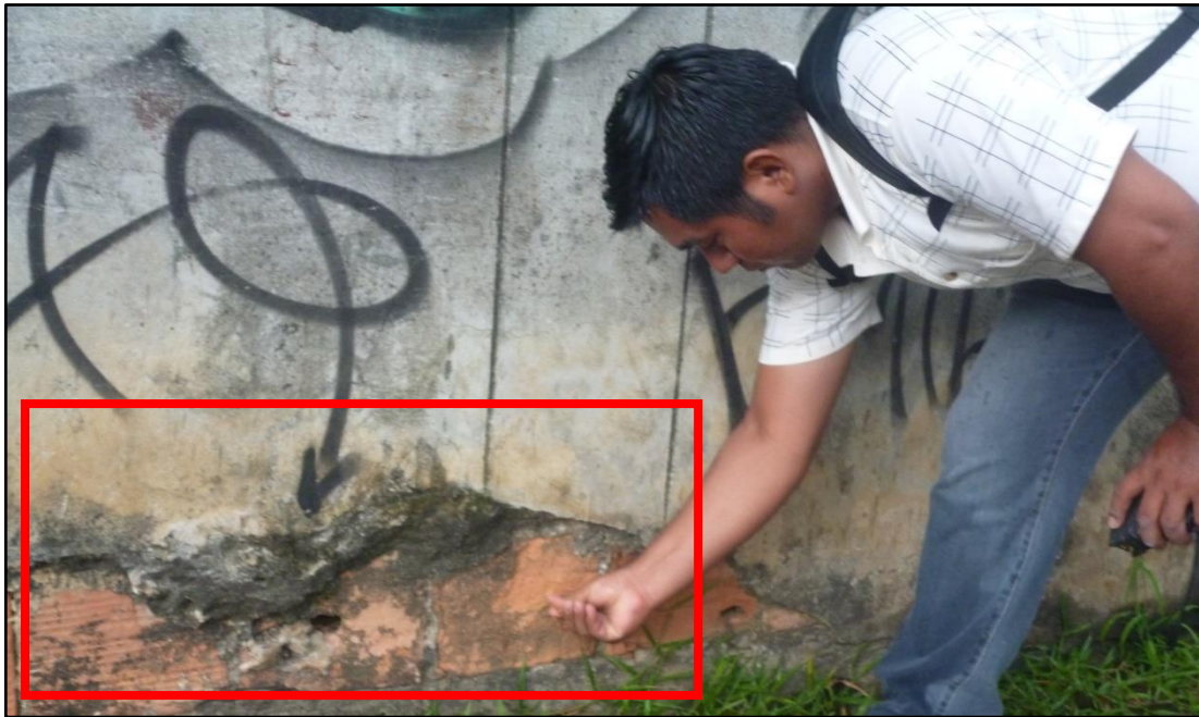
Fotografía 01: Patología Desprendimiento Identificado en el Muro confinado
