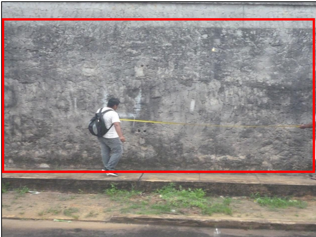
Fotografía 08: Patología Moho Identificado en el Muro confinado
