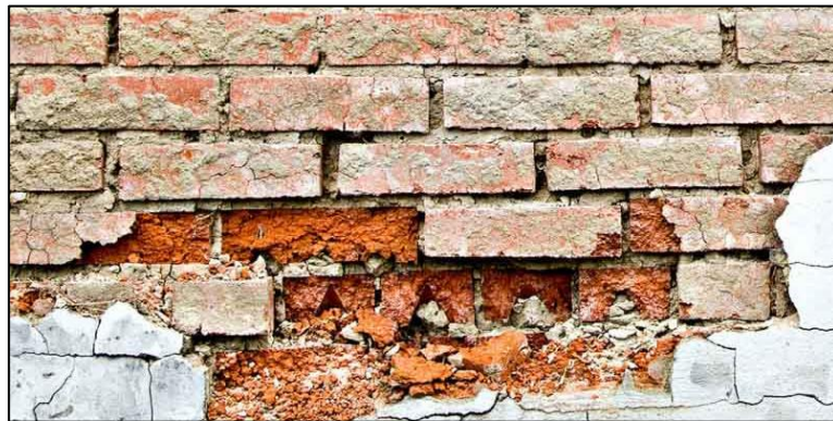
Figura 22. Erosión en muro confinado Nota. Fuente: (Astorga A, Rivero P. 2009) 18
