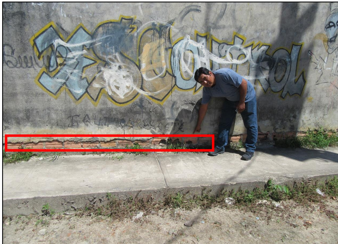
Fotografía 02: Patología Desprendimiento Identificado en el Muro confinado
