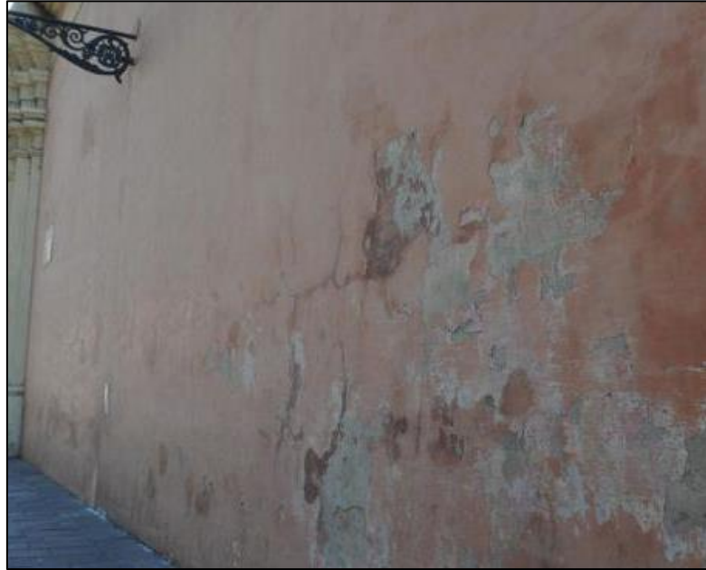
Figura 19. Eflorescencia en muros de albañilería Nota. Fuente: (Astorga A, Rivero P. 2009) 19
