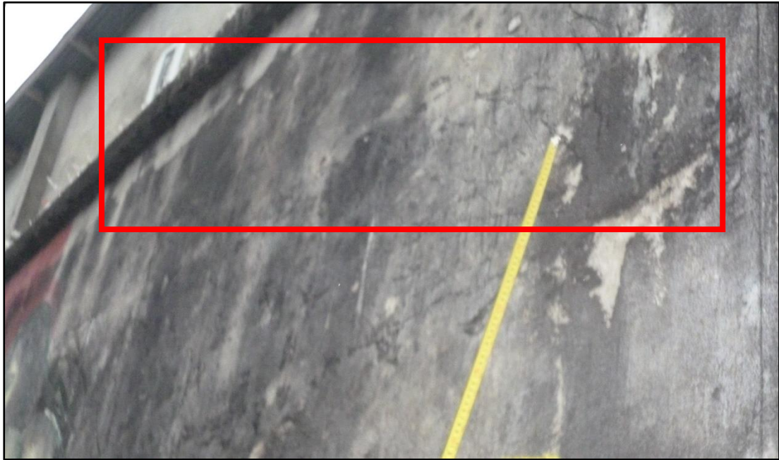
Fotografía 07: Patología Moho Identificado en el Muro confinado
