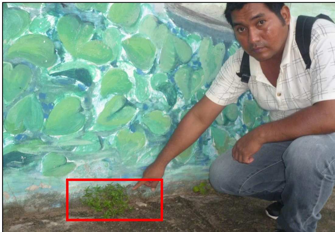
Fotografía 06: Patología Organismos Identificado en el Muro confinado
