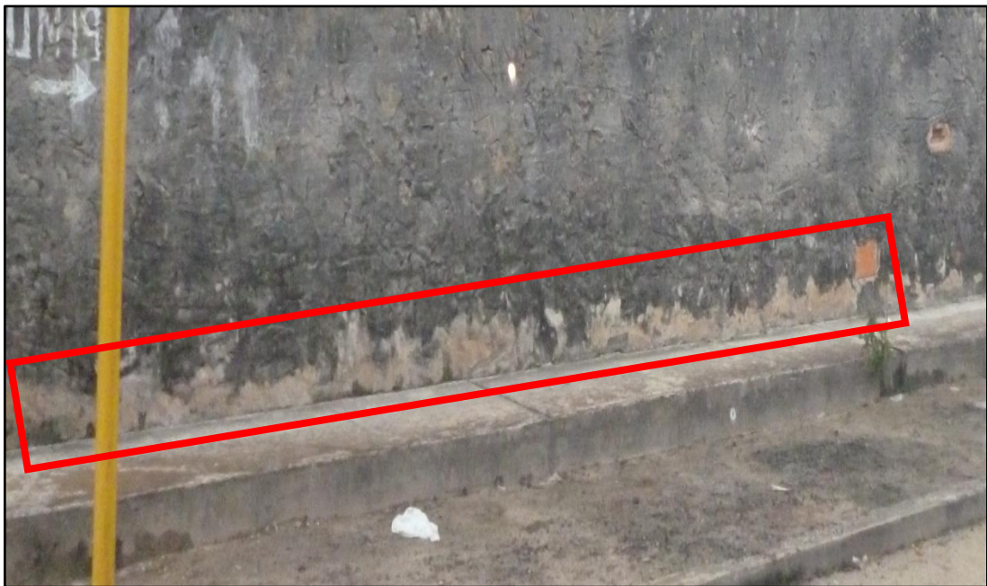
Fotografía 12: Patología Erosión Identificado en el Muro confinado
