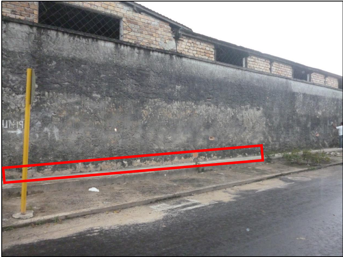
Fotografía 11: Patología Erosión Identificado en el Muro confinado
