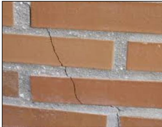
Figura 28. Fisura en muro de albañilería Nota. Fuente: ((Muñoz M. 2001) 23
