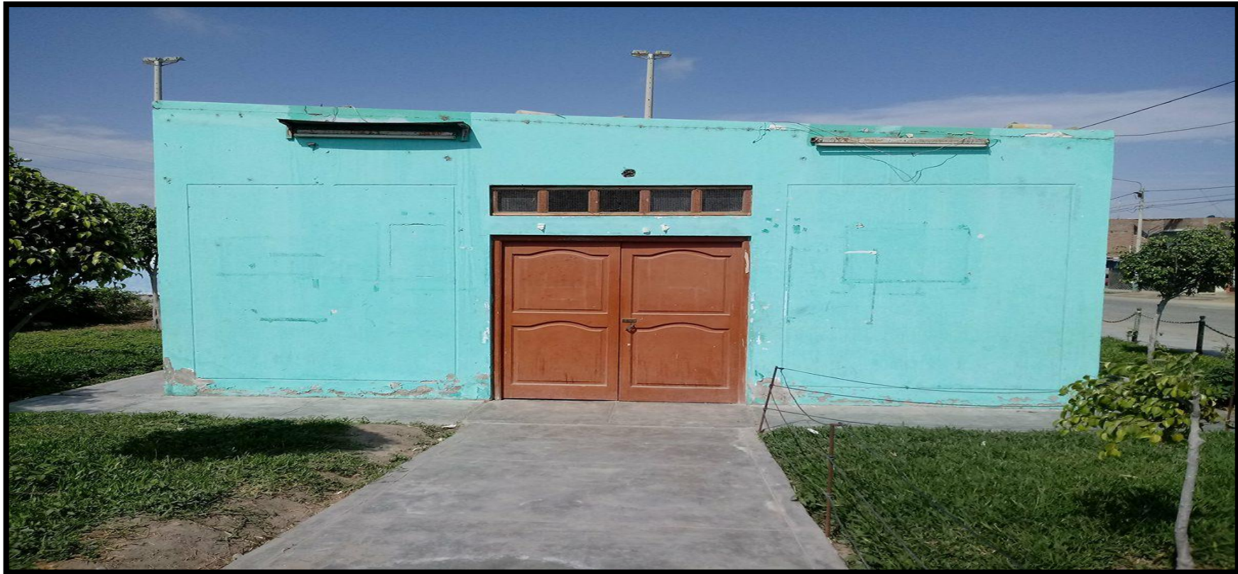
Fotografía 4: Vista exterior del tramo 17-18 de albañilería del Local Comunal de la Urbanización los Álamos PPAO, del distrito de Nuevo Chimbote, provincia del Santa, departamento de Áncash
