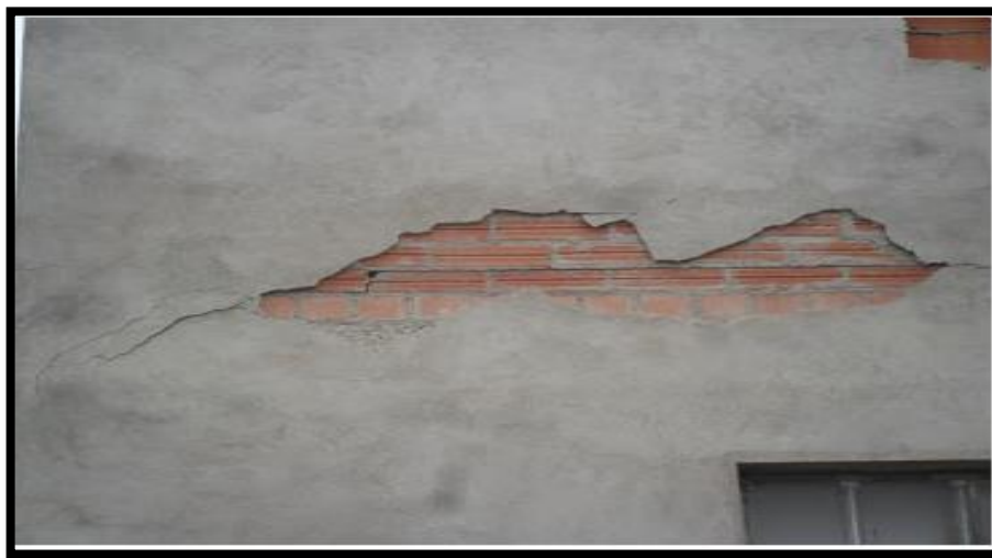
Figura 10: Desprendimiento en mortero.
