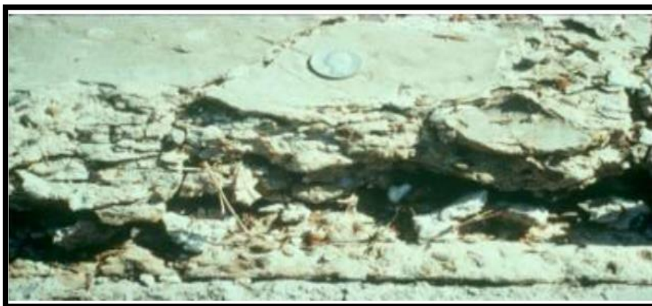
Figura 12: Presencia de Desintegración.
