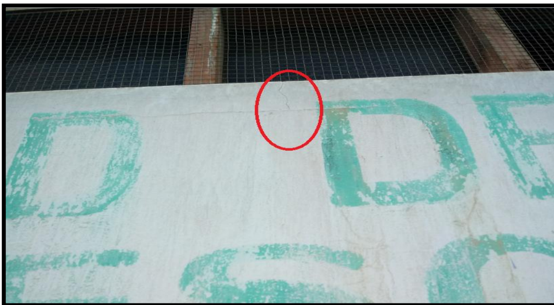
Fotografía 10: Patología de fisuras en muros del local comunal en la unidad de muestra 2.
