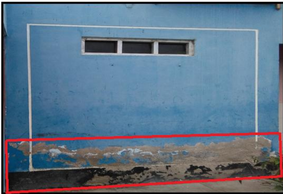
Fotografía 6: Patología de Eflorescencia en muros y sobrecimiento del local Comunal en la Unidad Muestral 11.
