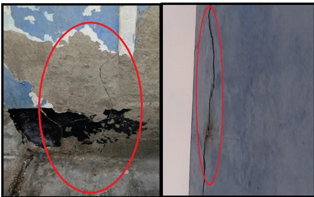
Fotografía 9: Patología de grietas en muros del local comunal en la Unidad Muestral 9.
