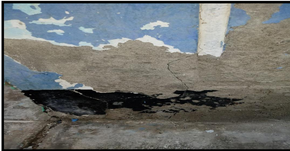
Figura 9: Presencia de fisuras en muros.
