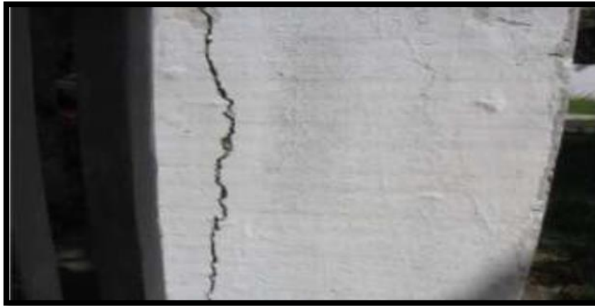
Figura 11: Presencia de Grieta en columna.
