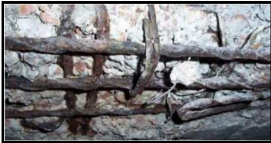
Figura 14: Presencia de Corrosión en el acero.
