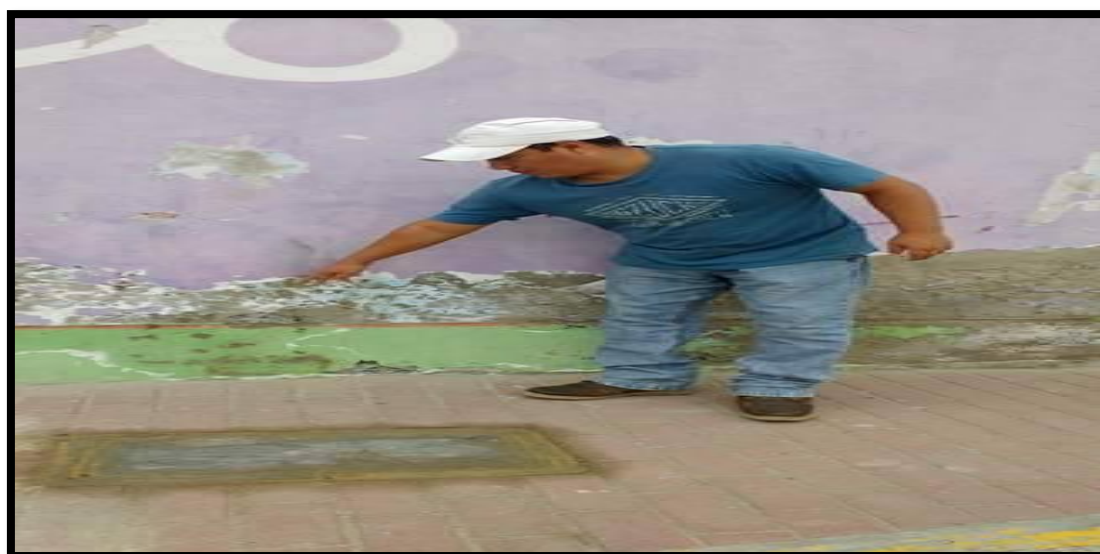
Fotografía 7: Patología de Eflorescencia en muros y sobrecimiento del local Comunal en la Unidad Muestral 07.
