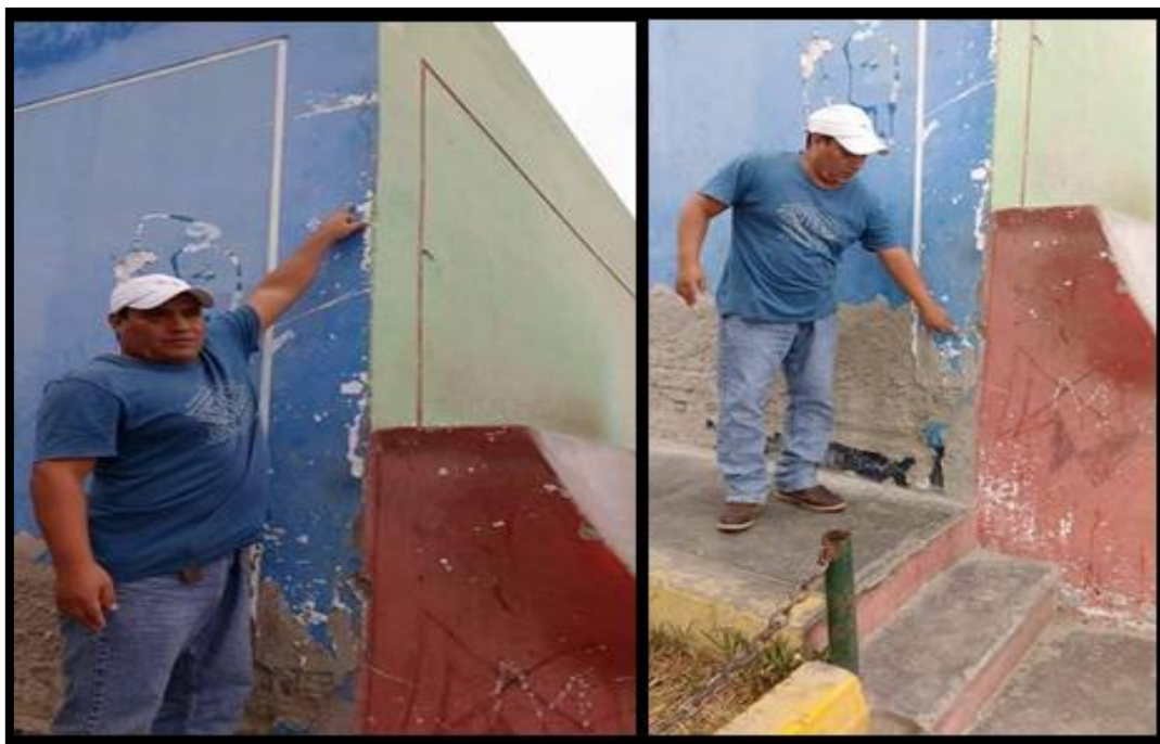
Fotografía 8: Patología de Grietas en columnas del local Comunal en la Unidad Muestral 04.
