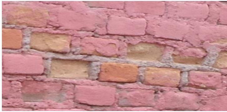
Figura 17. Erosión en muros de albañilería
