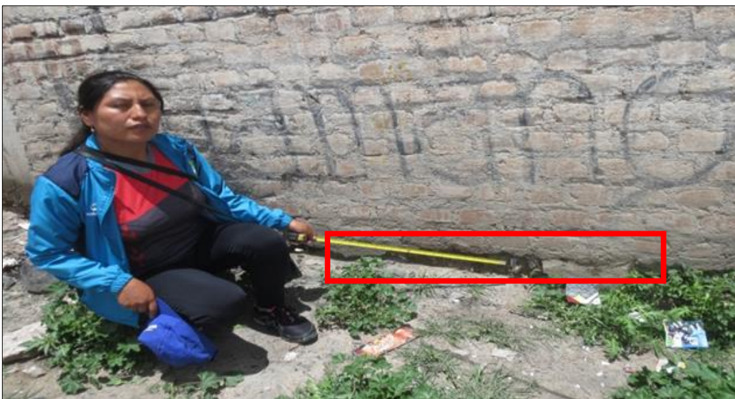
Fotografía 2: Erosión en el muro de albañilería del Cerco perimétrico del Instituto Superior Tecnológico Monseñor Víctor Álvarez Huapaya ubicado en el sector de Miraflores del distrito de San Juan Bautista, provincia de Huamanga, región Ayacucho.
