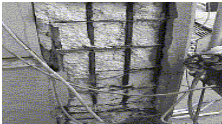
Figura 16. Corrosión en armadura de columna
