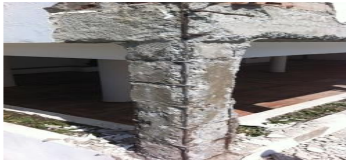
Figura 14. Patología del concreto Nota. Fuente: (Silva O. 2007) 19
