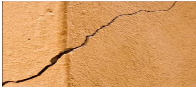
Figura 22. Grietas longitudinales Nota. Fuente: (Corral J. 2004) 27
