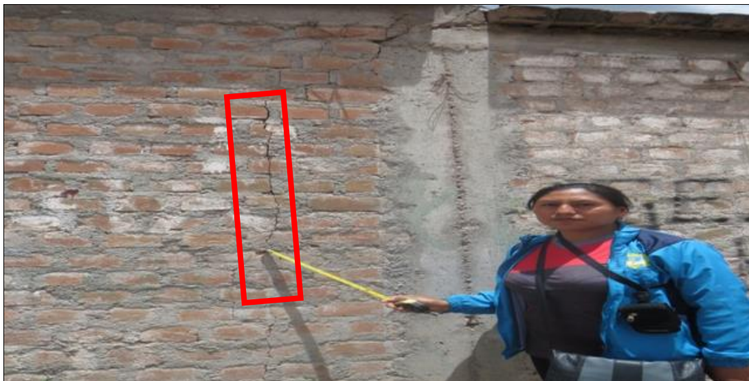
Fotografía 3: Grieta en el muro de albañilería del cerco perimétrico del Instituto Superior Tecnológico Monseñor Víctor Álvarez Huapaya ubicado en el sector de Miraflores del distrito de San Juan Bautista, provincia de Huamanga, región Ayacucho.
