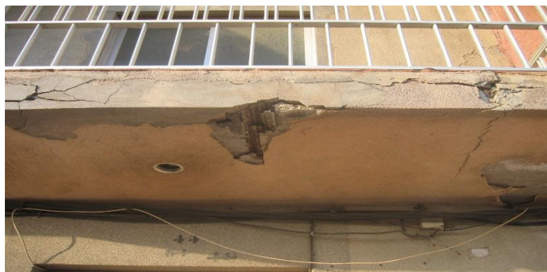
Figura 23. Desprendimiento del alero Nota. Fuente: (Fiol F. 2014) 28
