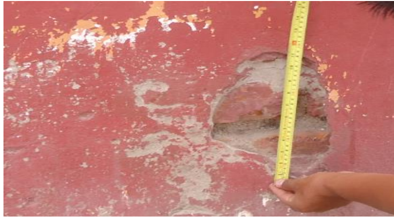
Figura 19. Picadura en muro confinado Nota. Fuente: Elaboracion Propia
