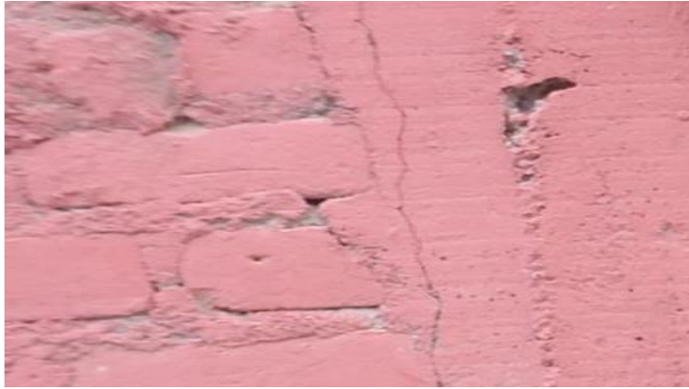
Figura 18. Fisura de columna Nota. Fuente: Elaboracion Propia
