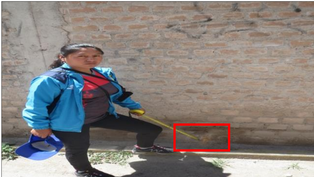
Fotografía 5: Eflorescencia en el muro de albañilería del cerco perimétrico del Instituto Superior Tecnológico Monseñor Víctor Álvarez Huapaya ubicado en el sector de Miraflores del distrito de San Juan Bautista, provincia de Huamanga, región Ayacucho.
