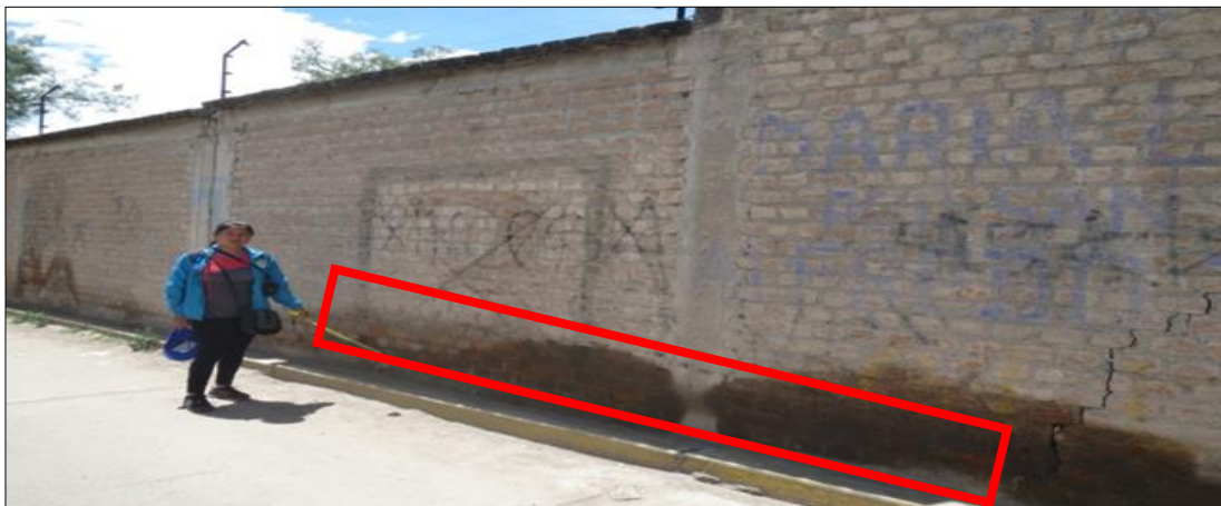
Fotografía 6: Erosión en el muro de albañilería del cerco perimétrico del Instituto Superior Tecnológico Monseñor Víctor Álvarez Huapaya ubicado en el sector de Miraflores del distrito de San Juan Bautista, provincia de Huamanga, región Ayacucho.
