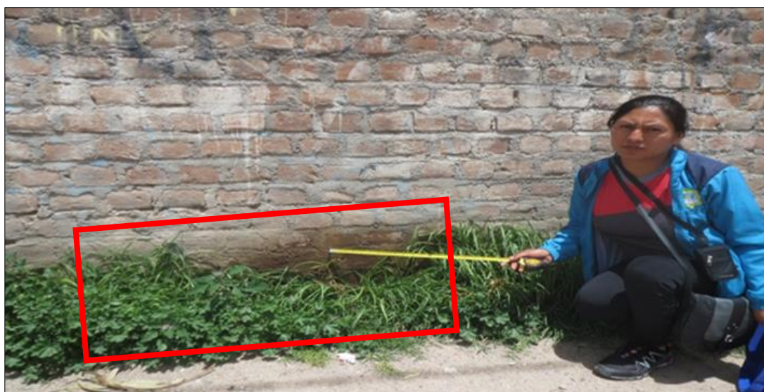
Fotografía 4: Presencia de humedad debido al riego y a áreas verdes provocara a futuro la aparición de diversas patologías como la eflorescencia y posteriormente la erosión en los muros del cerco perimétrico del Instituto Superior Tecnológico Monseñor Víctor Álvarez Huapaya ubicado en el sector de Miraflores del distrito de San Juan Bautista, provincia de Huamanga, región Ayacucho.
