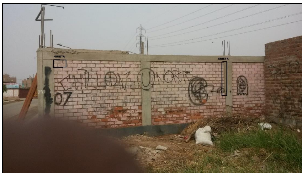
Fotografía 05: Se observa la grieta en columna y muro. En la U.M 05
