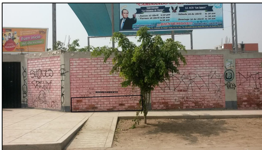
Fotografía 02: se observa el disgregamiento en los muros. En la U.M 18
