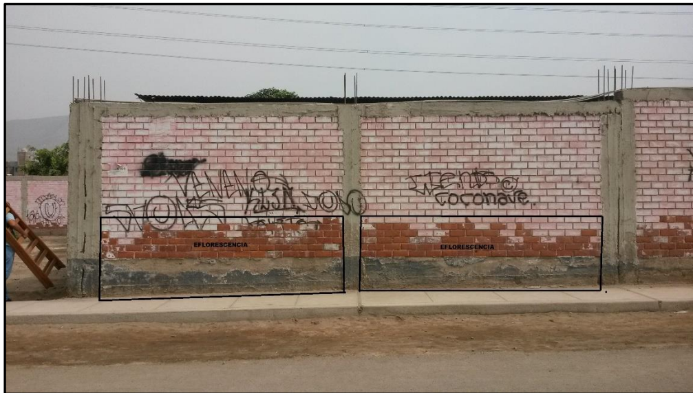
Fotografía 04: Se observa la eflorescencia en muros y sobrecimientos. En la U.M 09
