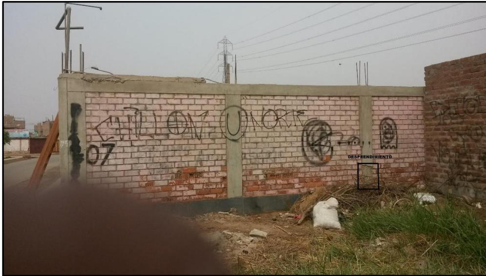
Fotografía 03: se observa el Desprendimiento en columna. En la U.M 05
