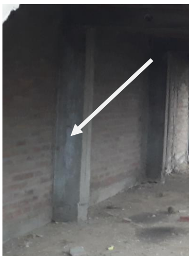
Figura 04. Imagen de Eflorescencia Fuente: Elaboración Propia (2018)
