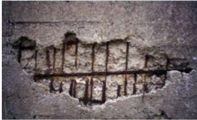
Figura 6. Imagen de corrosión Fuente: Elaboración Propia (2018)
