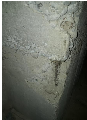
Figura 05. Imagen de oxidación Fuente: Elaboración Propia (2018)
