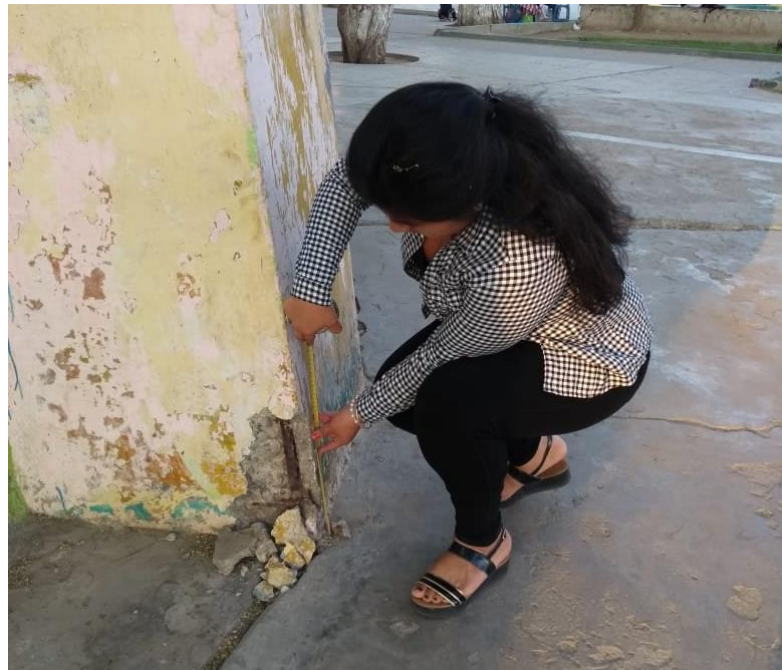
Gráfico 9: Desprendimiento en parte inferior de columna de concreto
