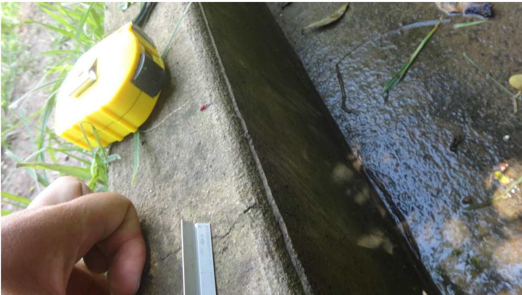
Imagen 27: Medición de fisuras
