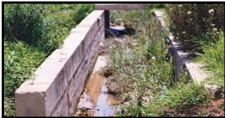
Figura 17. Sedimento y escombros en canal.
