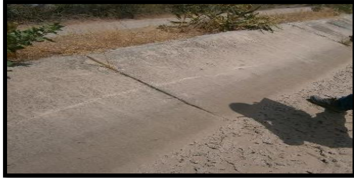
Figura 16. Eflorescencia en el concreto.
