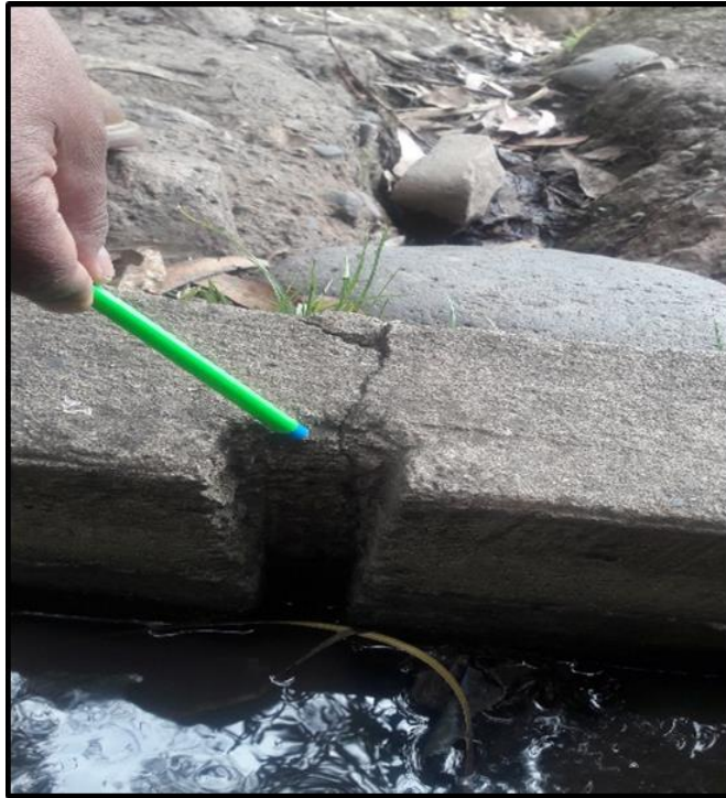
Fotografía N°03: Visualización de Fisuras y grietas en el lado derecho e izquierdo del canal
