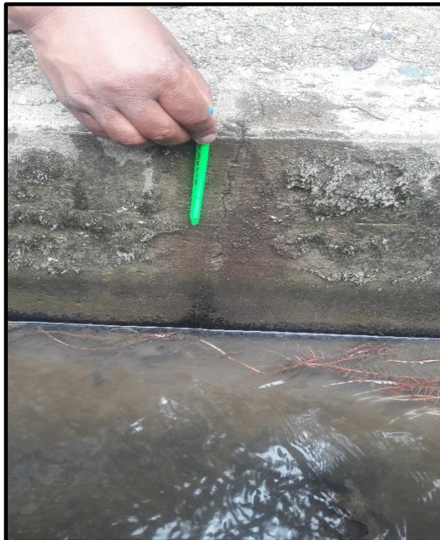
Fotografía N°08- Identificando la presencia de patologías Canal de riego Cayac- Huishca
