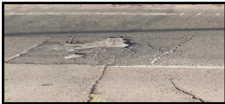
Figura 12. Hundimiento de la losa de concreto.
