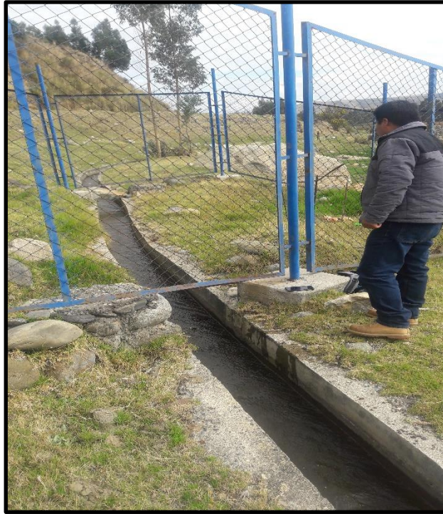
Fotografía N°09 Identificando la presencia de patologías Canal de riego Cayac – Huishca
