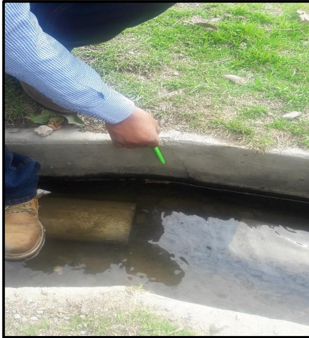
Fotografía N°05: Identificación de patologías en el canal de riego Cayac – Huishca
