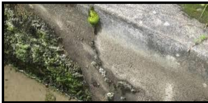
Figura 13. Daño por vegetación.
