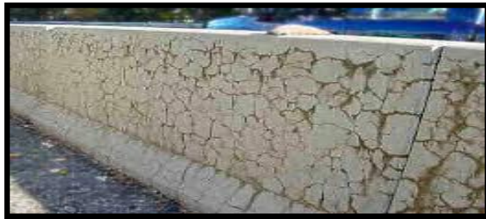
Figura 15. Descascaramiento de concreto.
