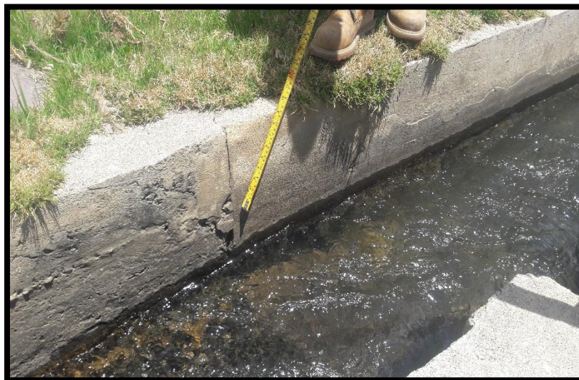
Fotografía N°02: Patología de grieta en el canal en estudio .
