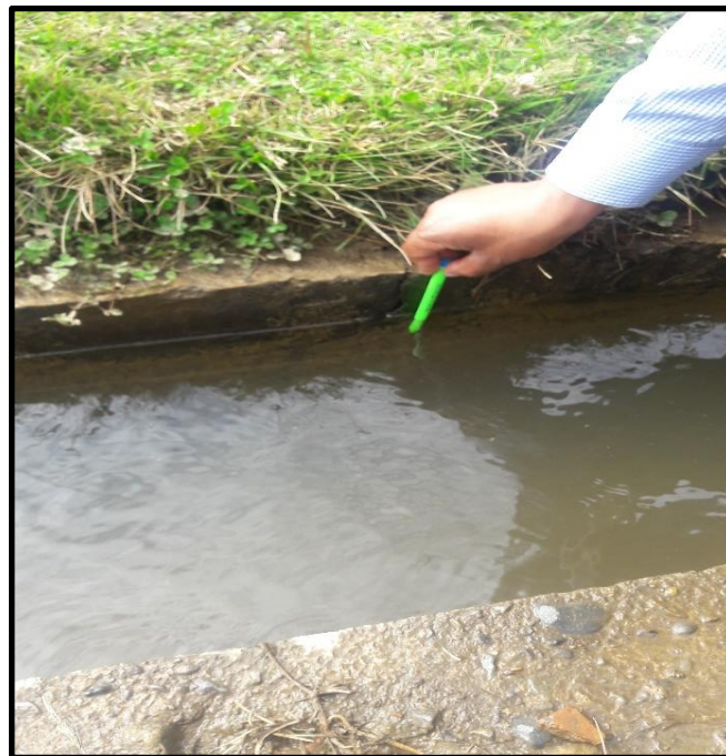
Fotografía N°04: Identificación de patologías en el canal de riego Cayac – Huishca
