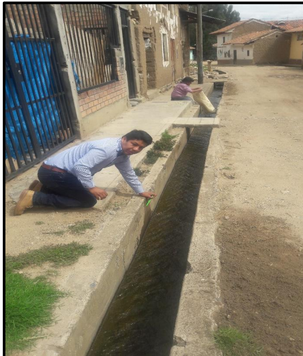
Fotografía N°06: Canal de riego Cayac – Huishca muy cercana a las viviendas y edificaciones
