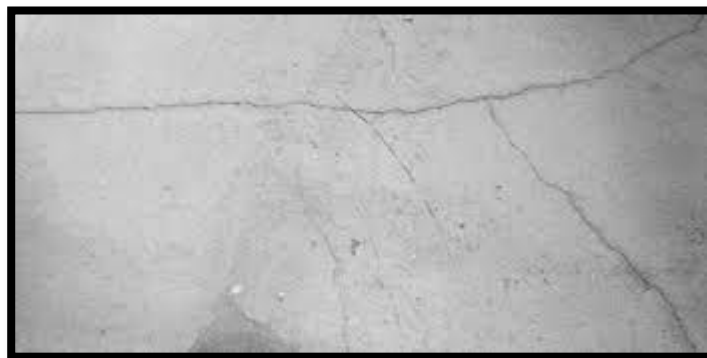
Figura 10. Fisura en concreto.
