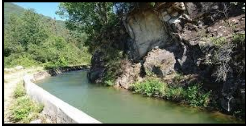
Figura 18: Daño por impacto.
