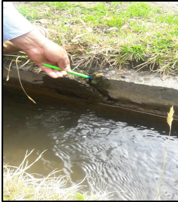
Fotografía N°07 identificando la presencia de patologías Canal de riego Cayac – Huishca
