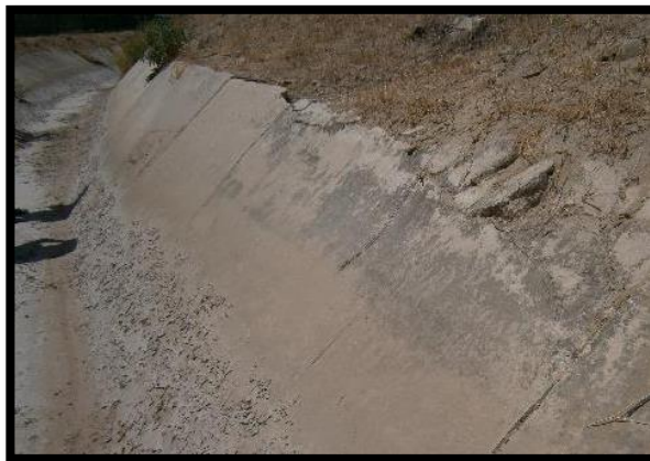
Figura 8. Erosión del concreto.
