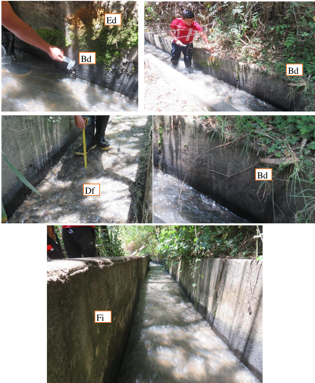
Figura 17. Detalle de las patologías de la unidad muestral 07
