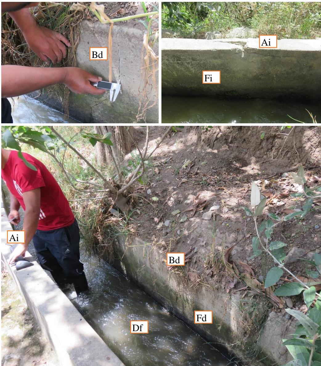
Figura 22. Detalle de las patologías de la unidad muestral 12
