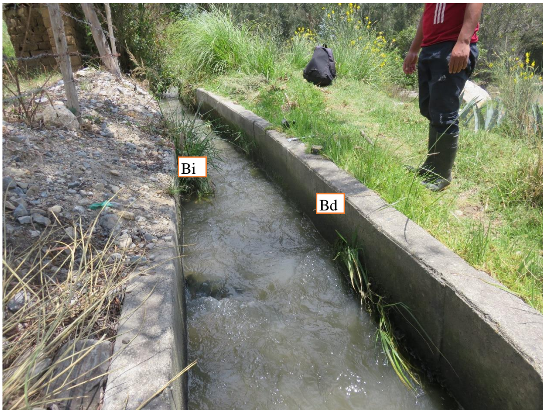
Figura 19. Detalle de las patologías de la unidad muestral 09
