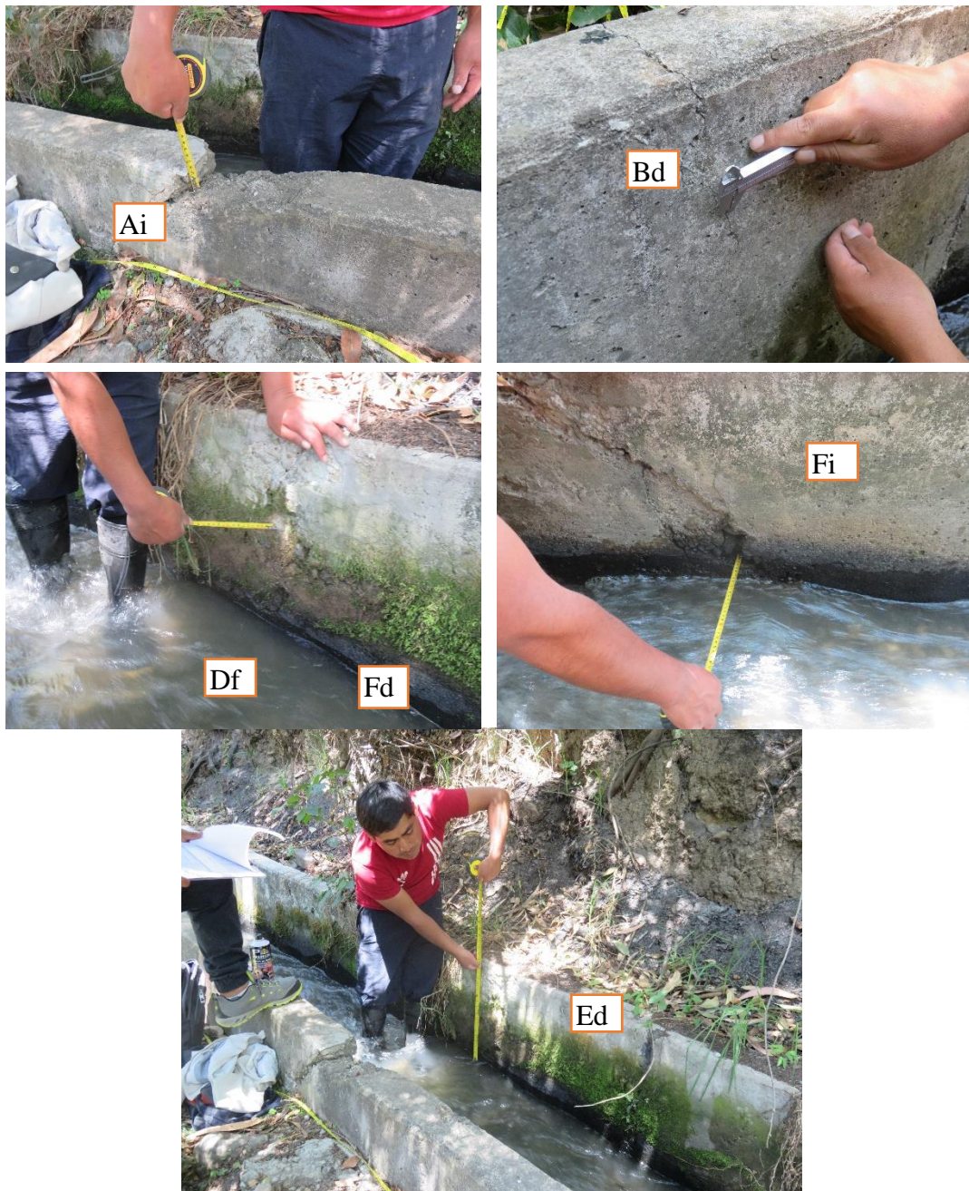
Figura 15. Detalle de las patologías de la unidad muestral 05
