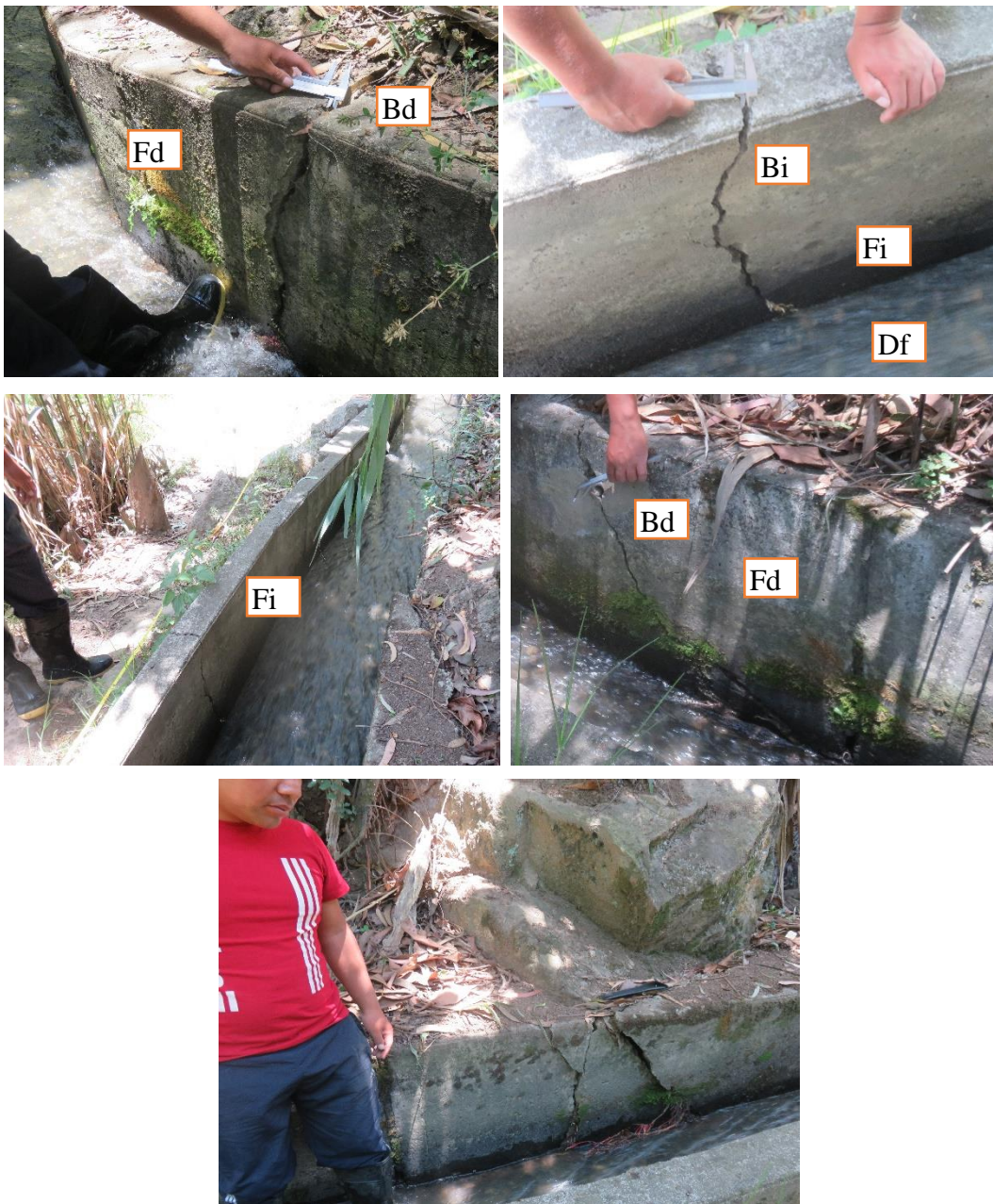
Figura 16. Detalle de las patologías de la unidad muestral 06
