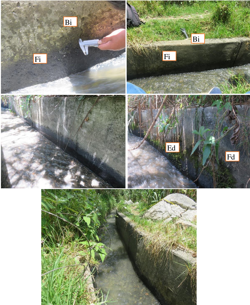
Figura 18. Detalle de las patologías de la unidad muestral 08
