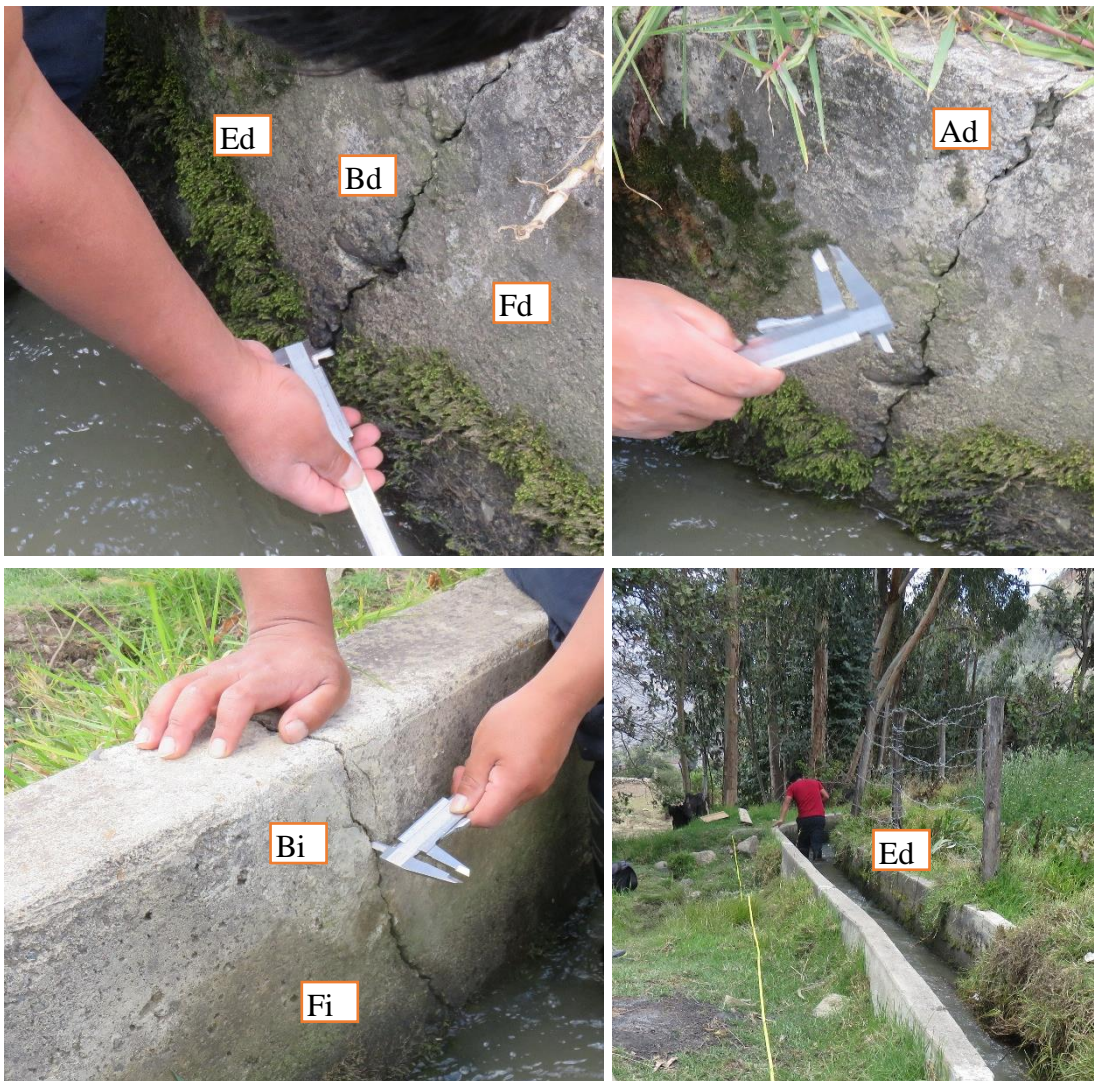
Figura 20. Detalle de las patologías de la unidad muestral 10
