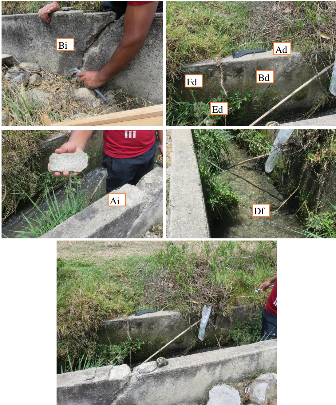
Figura 21. Detalle de las patologías de la unidad muestral 11
