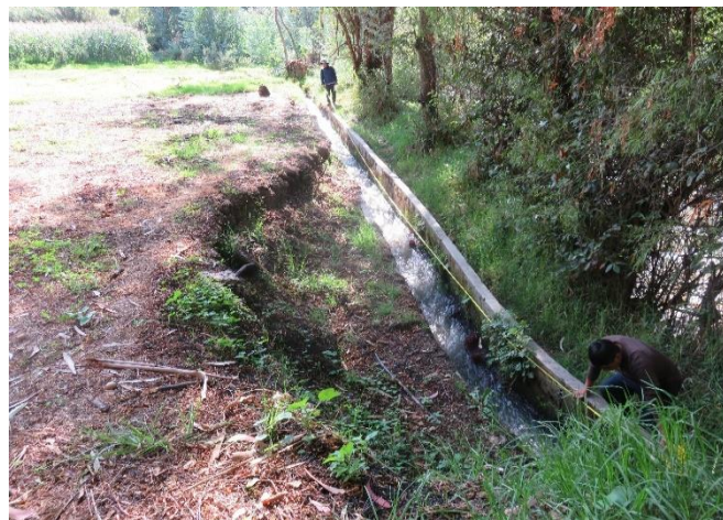
Figura 12. Detalle de las patologías de la unidad muestral 02
