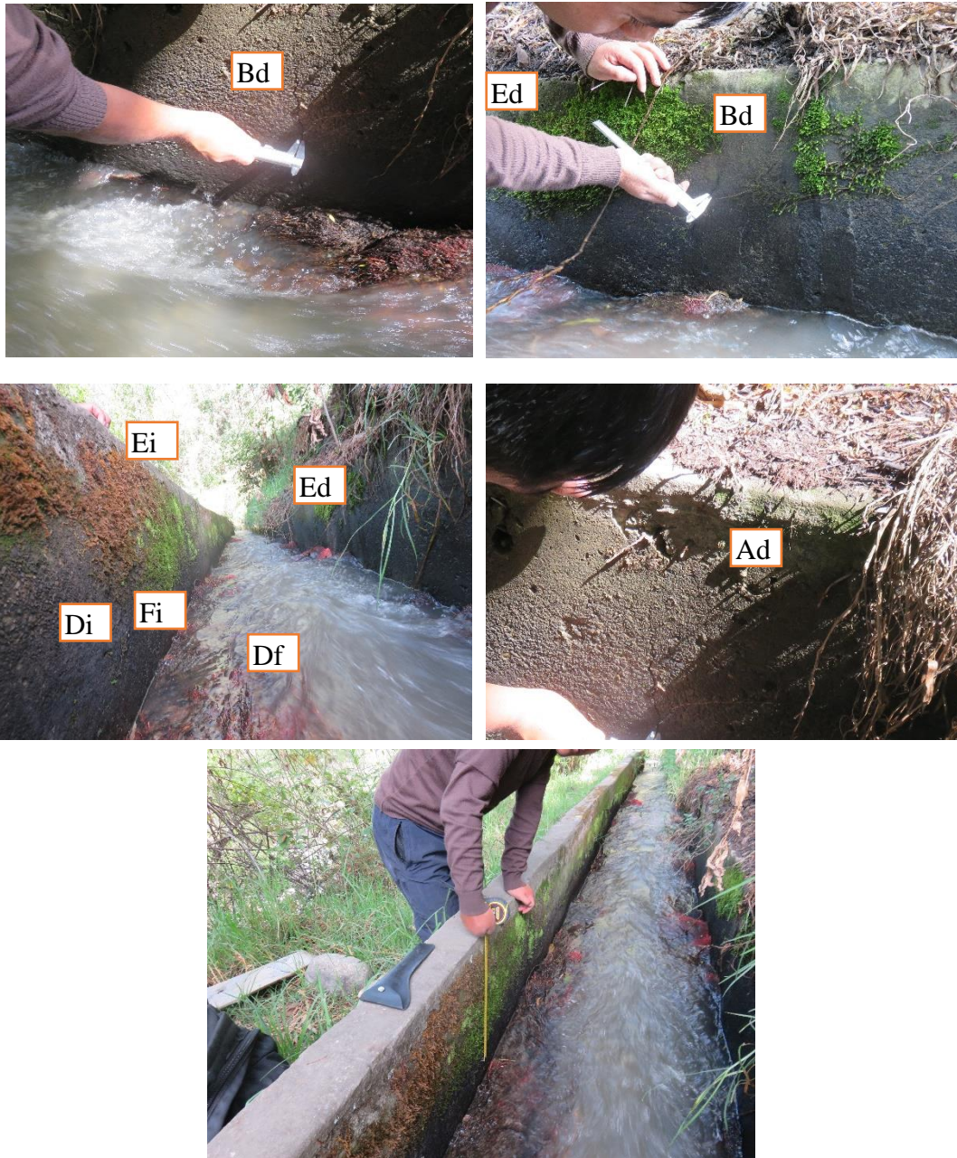
Figura 13. Detalle de las patologías de la unidad muestral 03
