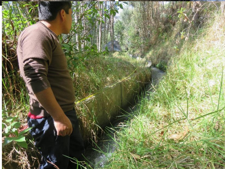
Figura 14. Detalle de las patologías de la unidad muestral 04
