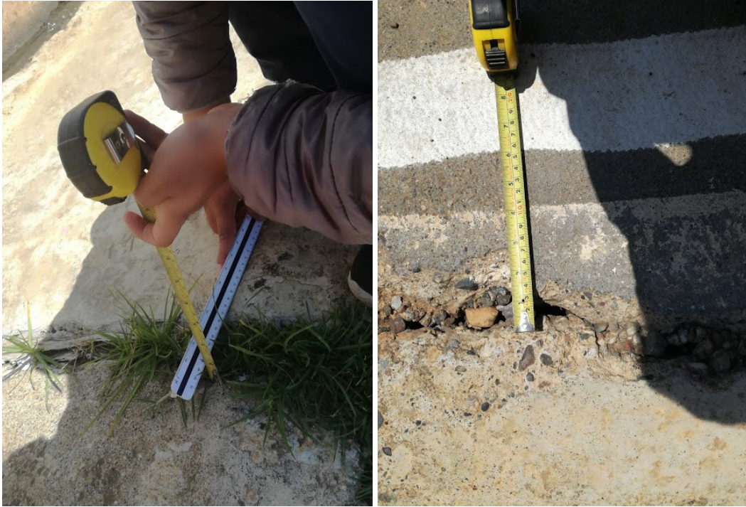
Ilustración 3. La separación de la cuneta con la carretera ha permitido la filtración del agua y el escalonamiento.
