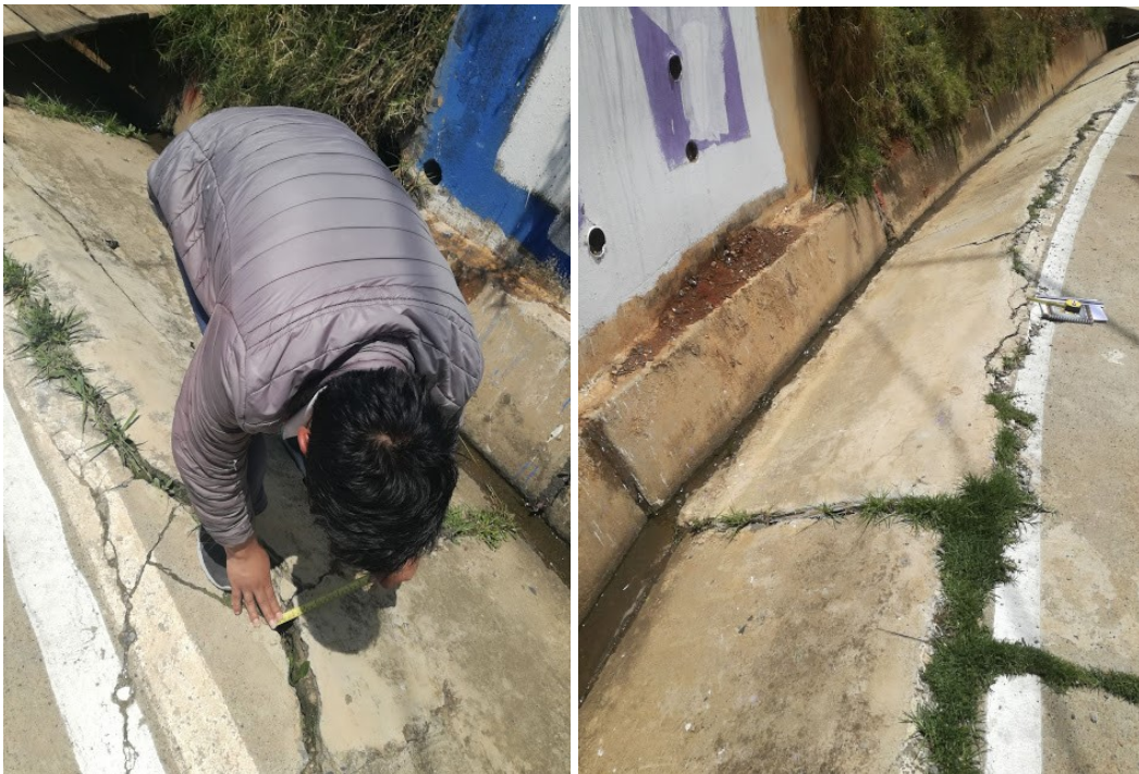
Ilustración 2. Fracturamiento de la estructura ha permitido la filtración del agua y el crecimiento de vegetación en las grietas.
