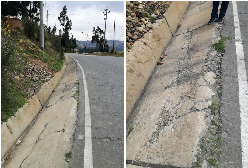
Ilustración 4. Fracturamiento de la estructura debido a las acciones mecánicas.
