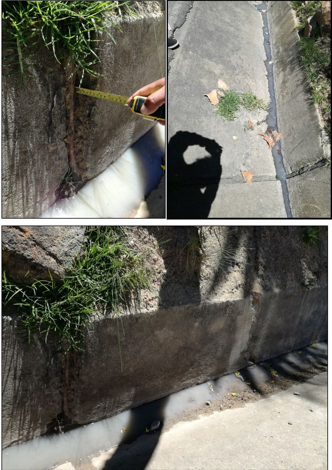
Ilustración 5. Fracturamiento de la estructura por el empuje del terreno.
