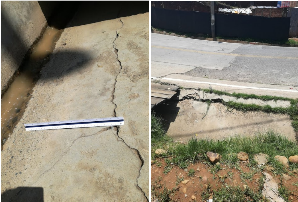
Ilustración 1. Presencia de grietas debido a las deformaciones por acciones mecánicas.
