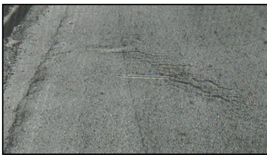
Imagen 19. Falla por Grieta parabólica
