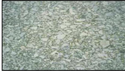
Imagen 15. Falla por Pulimento de agregados
