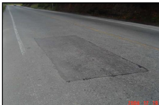
Imagen 14. Falla por Parcheo y acometidas de servicios públicos
