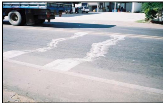
Imagen 17. Falla por Ahuellamiento
