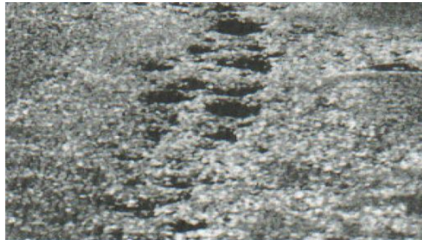
Imagen 21. Falla por Desprendimiento de agregados
