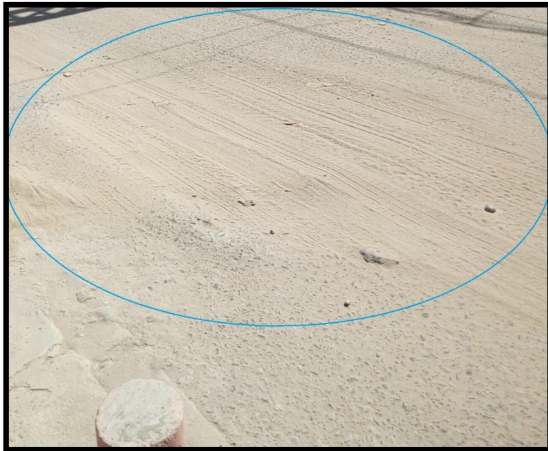
Se observa la patología de hundimiento, esta se origina por el tránsito de vehículos de carga pesada. Fuente propia
