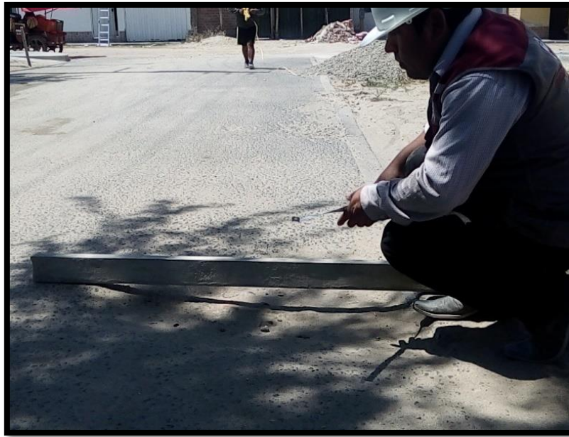
Se observa la patología Huecos que se producen cuando pavimento pierde estratos de la superficie del pavimento. Fuente propia.
