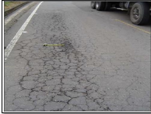
Imagen 6. Falla tipo piel de cocodrilo.
