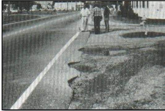
Imagen 12. Falla por Depresión
