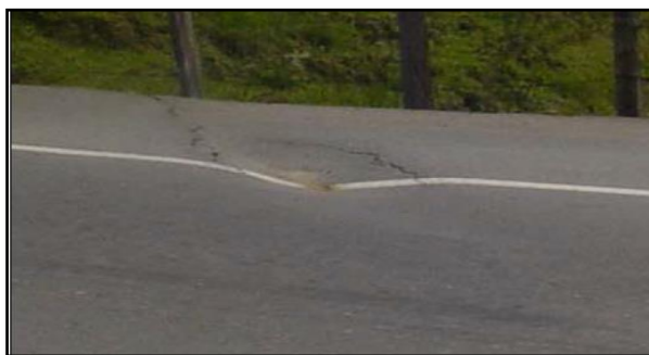
Imagen 9. Falla por Hundimiento
