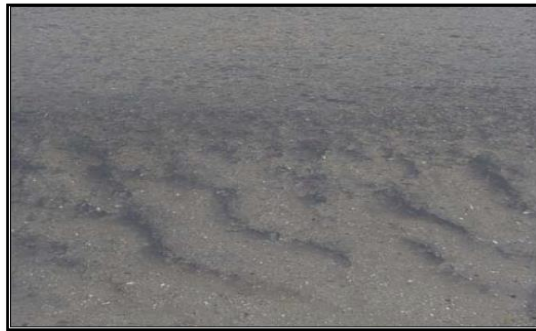
Imagen 7. Falla por exudación
