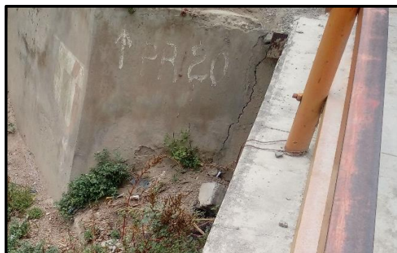
Figura 33: Grieta en el estribo.
