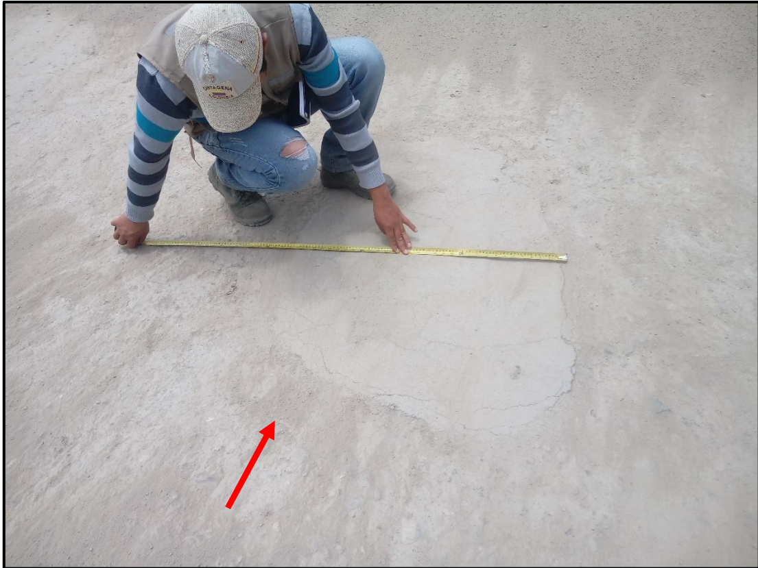
Fotografía N° 3. Se observa la erosión presente en la Unidad Muestral 3.
