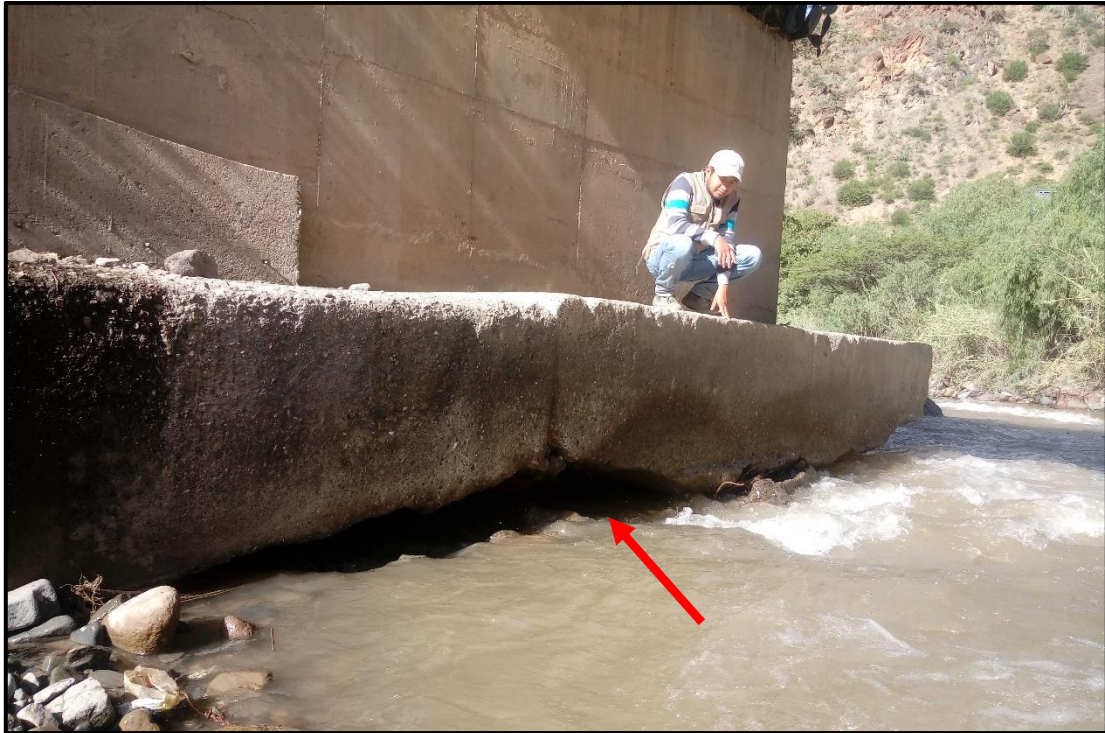
Fotografía N° 7. Se observa la socavación en la Unidad Muestral 11.
