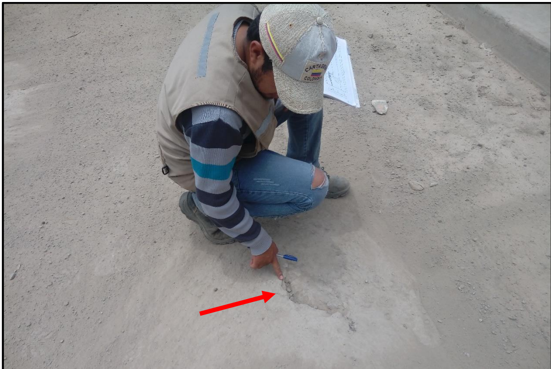
Fotografía N° 4. Se observa la grieta presente en la Unidad Muestral 3.
