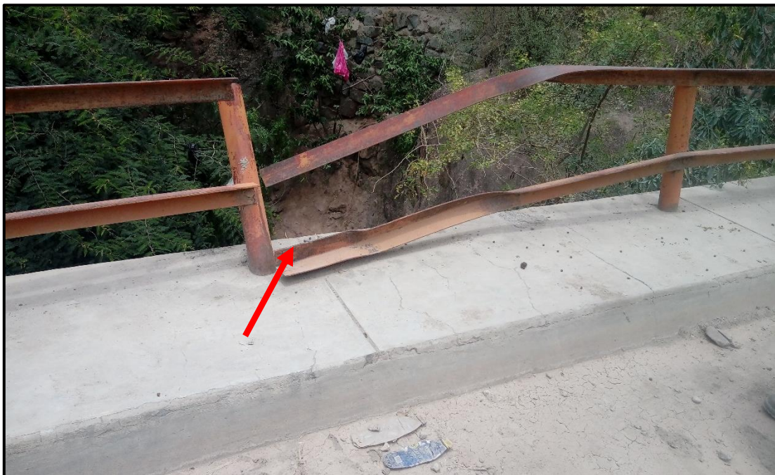
Fotografía N° 6. Se observa la deformación en la Unidad Muestral 1, generada por el impacto.
