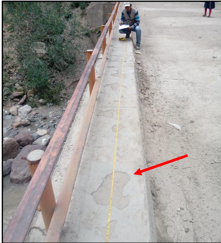
Fotografía N° 11. Se observa la erosión en la Unidad Muestral 2.
