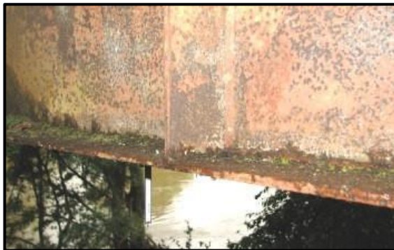
Figura 37: Oxidación del acero estructural.
