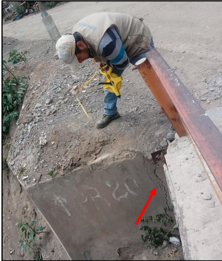
Fotografía N° 5. Se observa la grieta presente en la Unidad Muestral 10.
