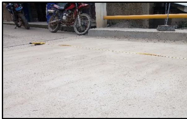
Figura 32: Erosión del pavimento.
