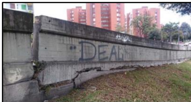
Figura 7: Inspección patológica de la estructura puente avenida Rojas con calle 26.
