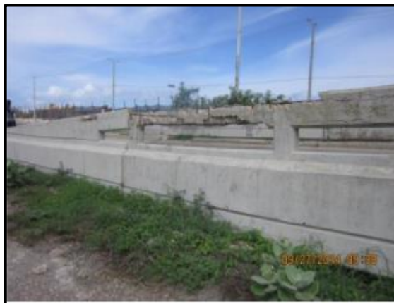
Figura 5: Exposición de acero en las barandas. Nota. Fuente: Contreras C, Reyes E. (2014).
