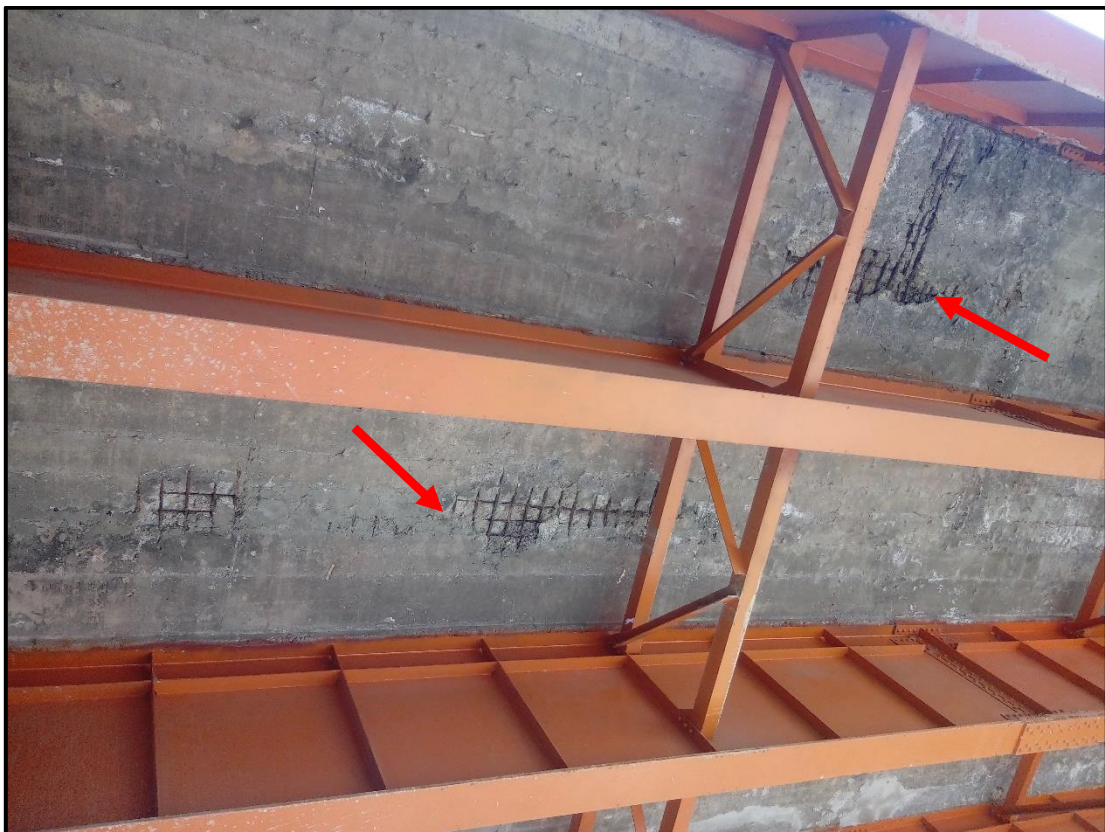
Fotografía N° 8. Se observa la oxidación de las mallas de acero en la Unidad Muestral 4.
