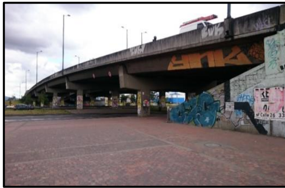
Figura 6: Inspección patológica de la estructura Av. ciudad de Cali con calle 26.
