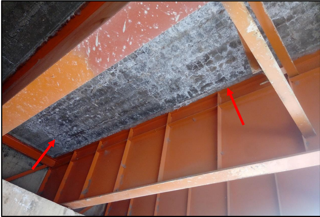
Fotografía N° 9. Se observa las eflorescencias en la Unidad Muestral 4.
