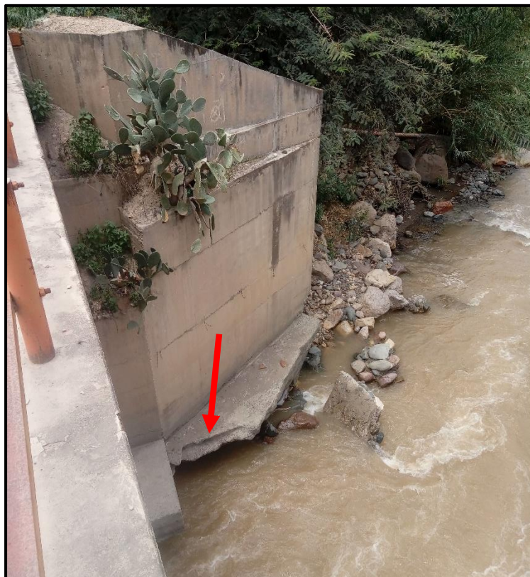
Fotografía N° 12. Se observa la pérdida de sección en la Unidad Muestral 11.
