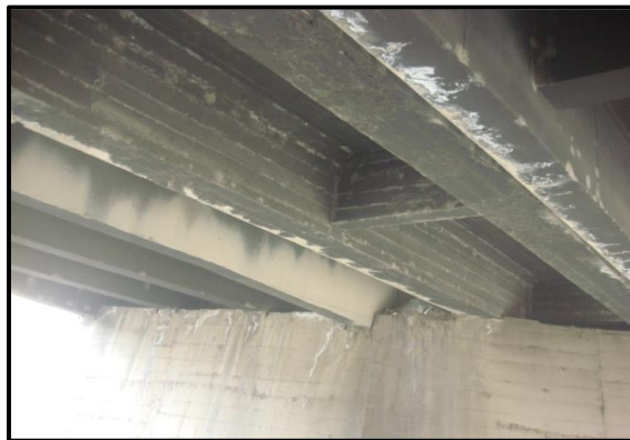
Figura 38: Eflorescencia en el concreto.
