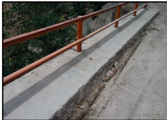
Figura 35: Desprendimiento del concreto en el borde de las veredas.
