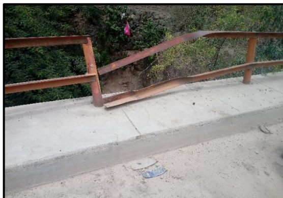
Figura 34: Deformación de las barandas debido al impacto.
