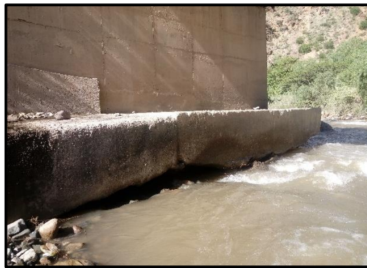
Figura 36: Socavación de la cimentación. Nota. Fuente: Elaboración propia. (2018).
