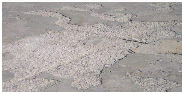
Gráfico 4 Desintegración de concreto
