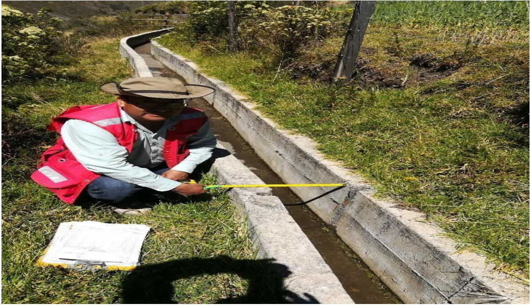
Fotografía 01- vista muro derecho midiendo las fisuras en el canal de irrigación Túpac Amaru de la localidad de Racrachaca distrito de Aquia, provincia de Bolognesi, departamento de ncash,
