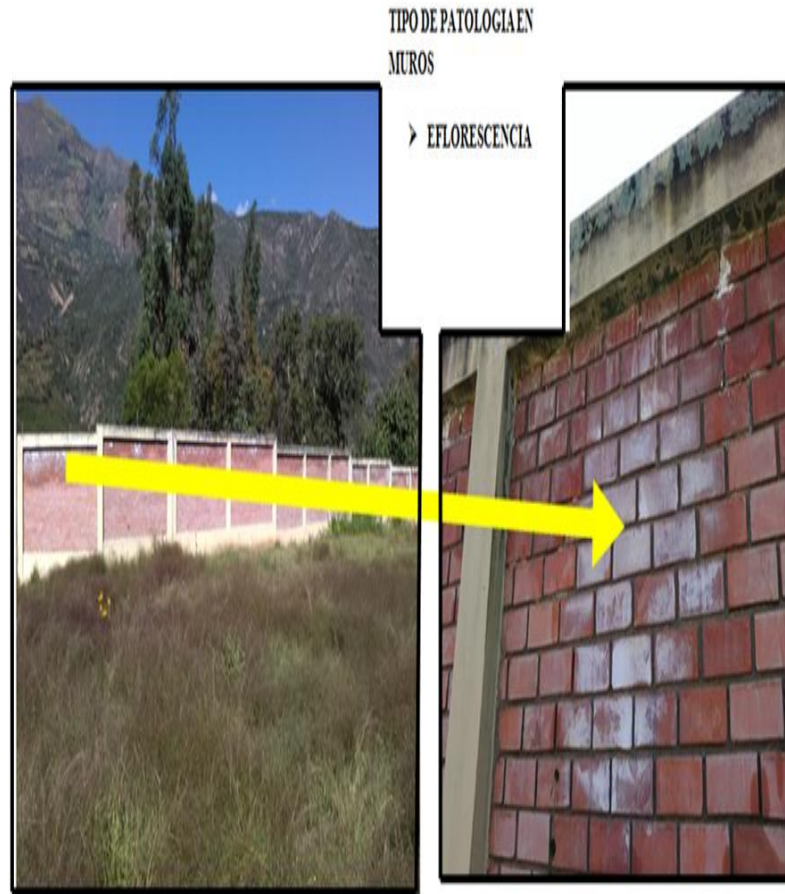
Fotografía 07: Albañilería afectado por eflorescencia en Unidad Muestral 13.
