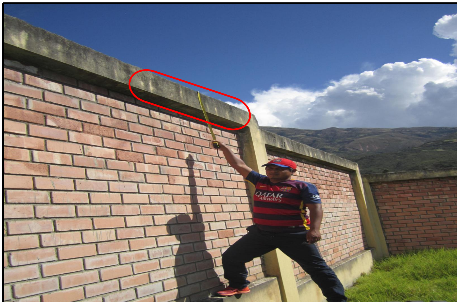
Fotografía 8: viga afectado por eflorescencia y desprendimiento.
