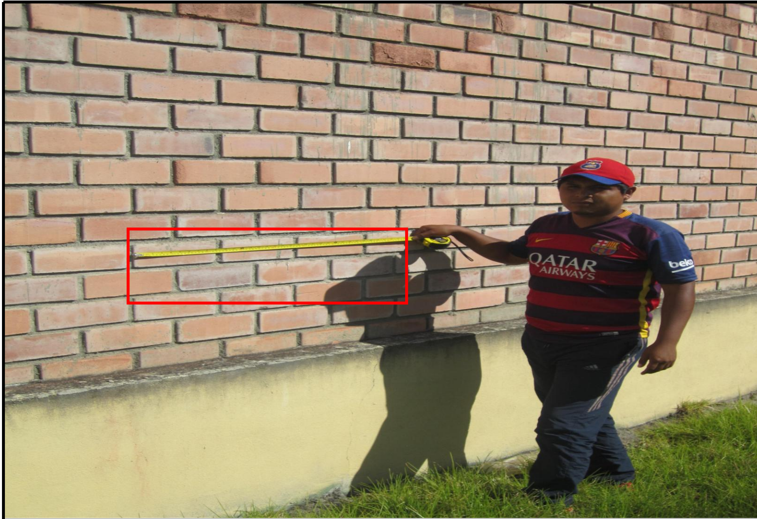
Fotografía 5: Albañilería afectado por eflorescencia en Unidad Muestral 14.
