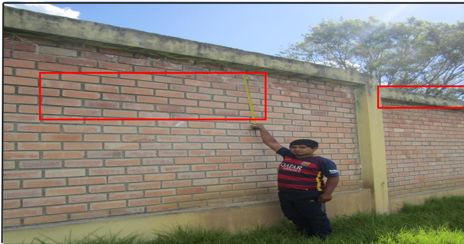
Fotografía 6: Albañilería afectado por eflorescencia.
