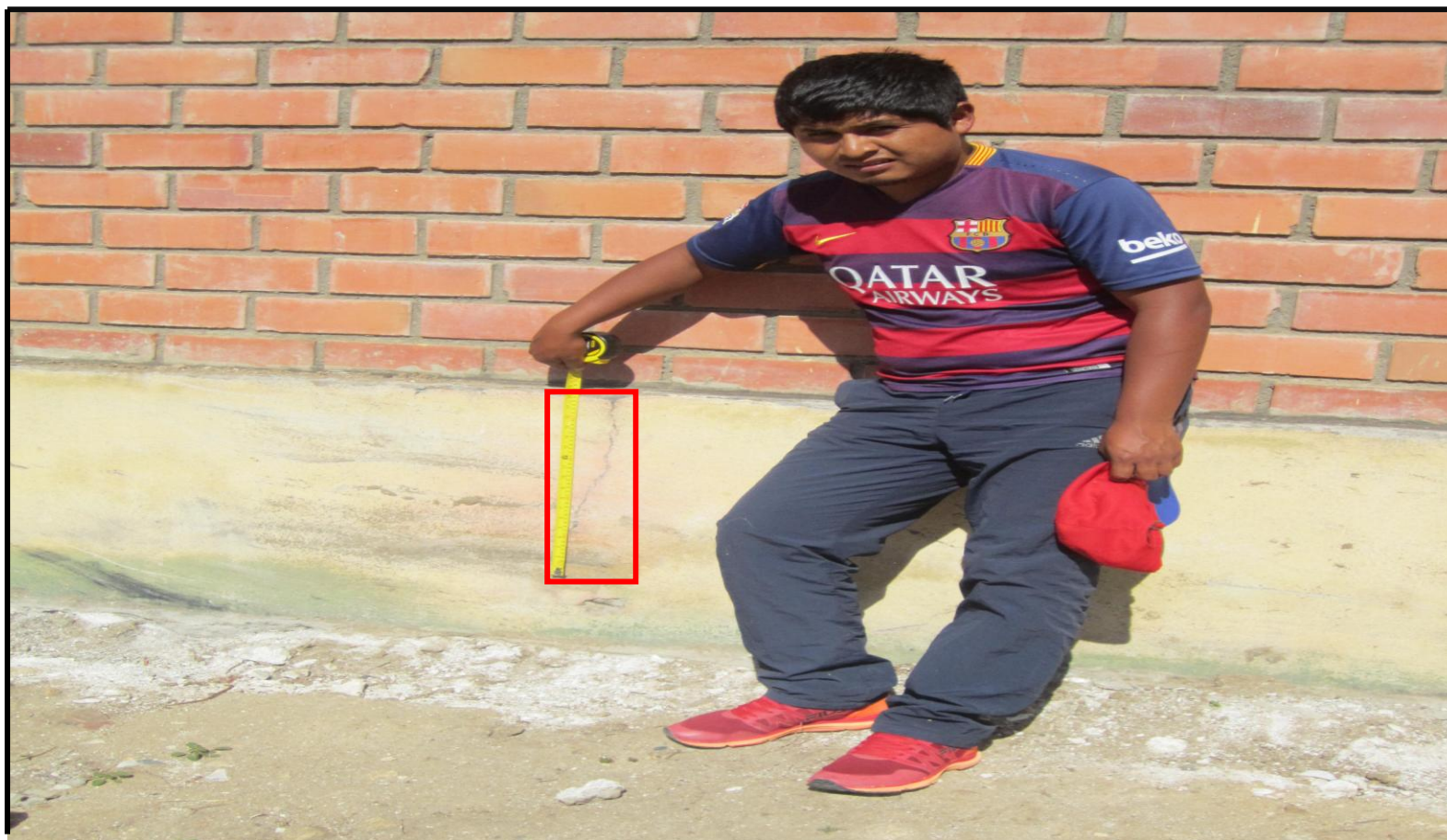
Fotografía 7: Sobrescimiento afectado por fisura.
