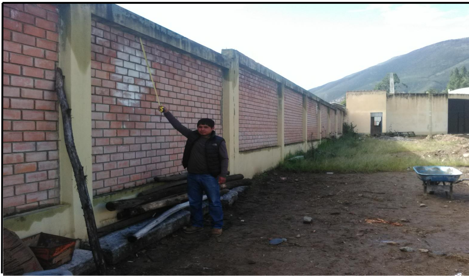
Fotografía 4: Albañilería afectado por eflorescencia en Unidad Muestral 20.
