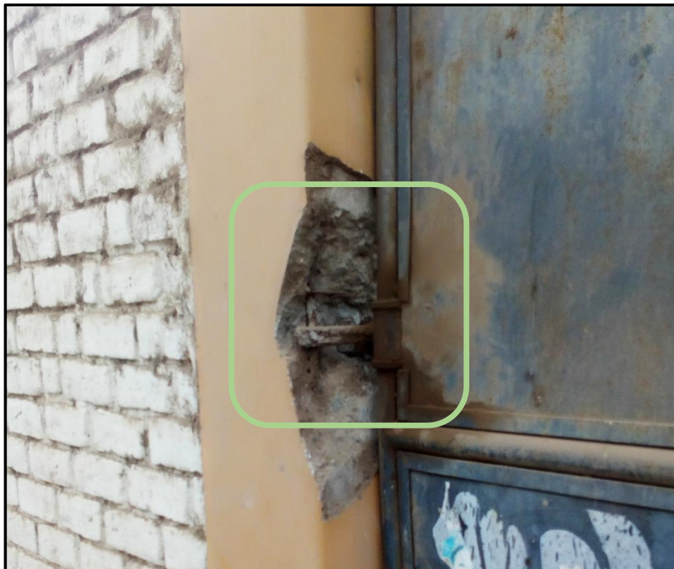
Fotografía 9. Columna afectada por la corrosión en la unidad de muestra 15.
