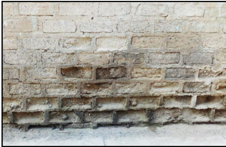
Figura 14. Erosión en muro de albañilería debido a la humedad. Fuente: Investigación Propia (2018)
