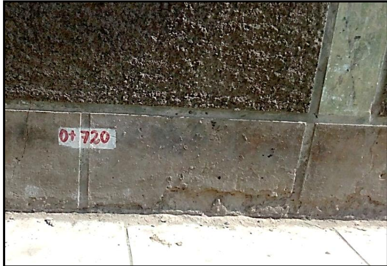
Figura 17. Desprendimiento del tarrajeo en el sobrecimiento de una vivienda. Fuente: Investigación Propia (2018).
