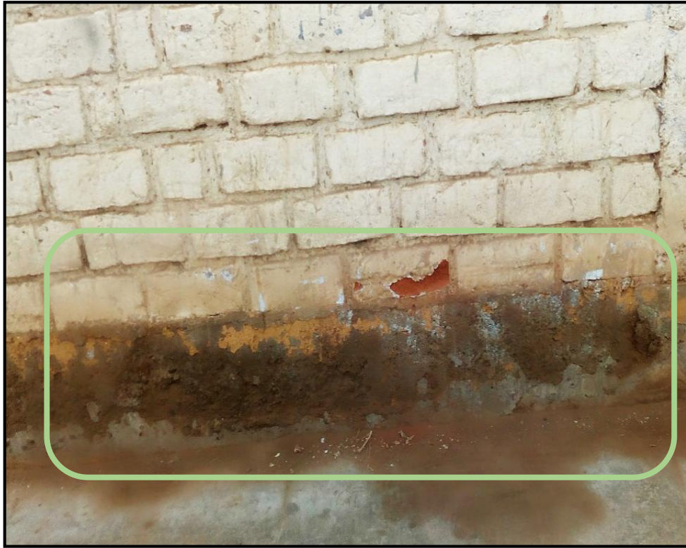
Fotografía 6. Sobrecimiento afectado por la erosión en la unidad de muestra 12.
