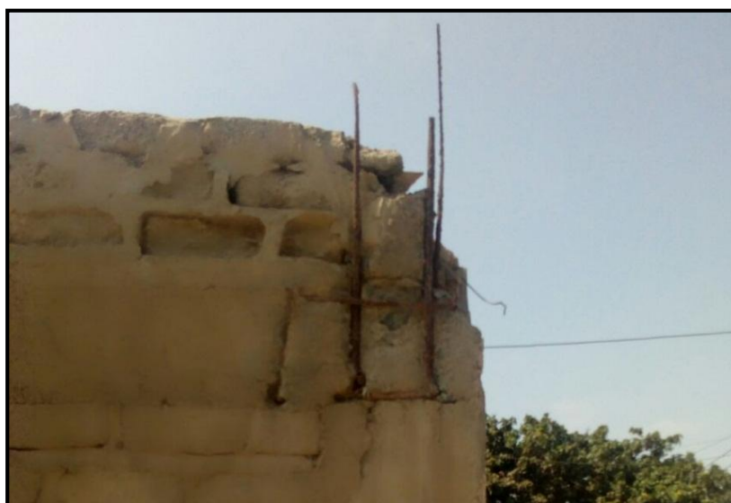
Figura 20. Corrosión en el acero de una columna debido a la falta de recubrimiento. Fuente: Investigación Propia (2018)
