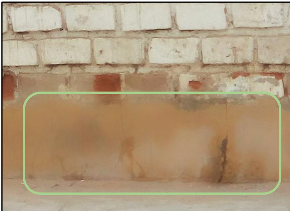
Fotografía 7. Sobrecimiento afectada por la fisura en la unidad de muestra 4.
