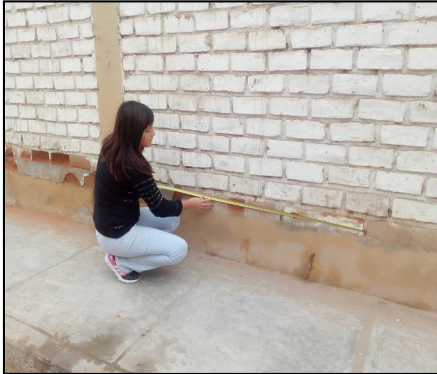
Fotografía 10. Midiendo la erosión que afecta el muro de albañilería en la unidad de muestra 4.
