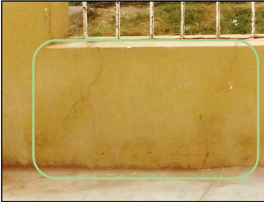
Fotografía 8. Sobrecimiento afectado por la fisura en la unidad de muestra 9.
