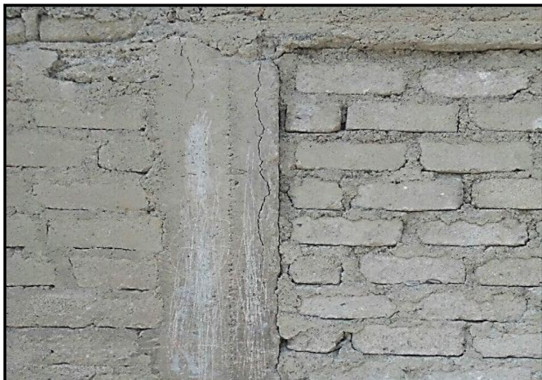
Figura 16. Presencia de la grieta en la columna debido a la corrosión del acero. Fuente: Investigación Propia (2018)
