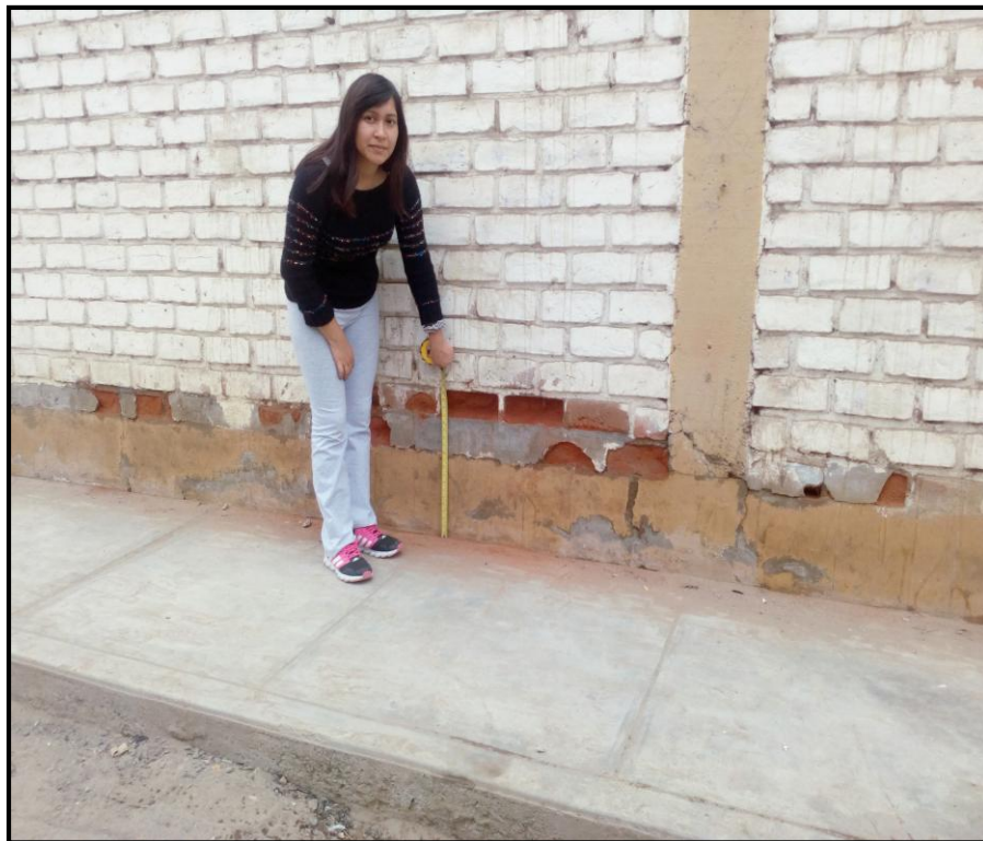
Fotografía 11. Midiendo la fisura que afecta sobrecimiento en la unidad de muestra 6.
