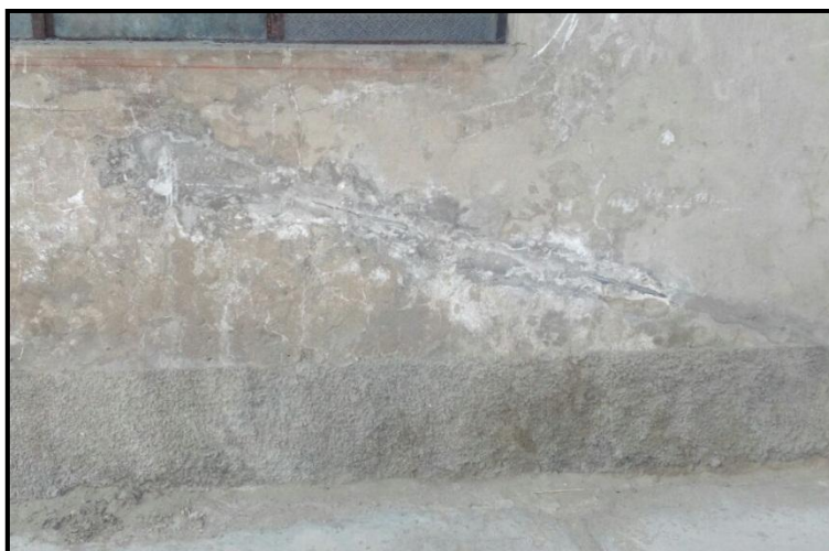
Figura 18. Presencia de la eflorescencia en muro de albañilería debido a daños de la tubería. Fuente: Investigación Propia (2018).
