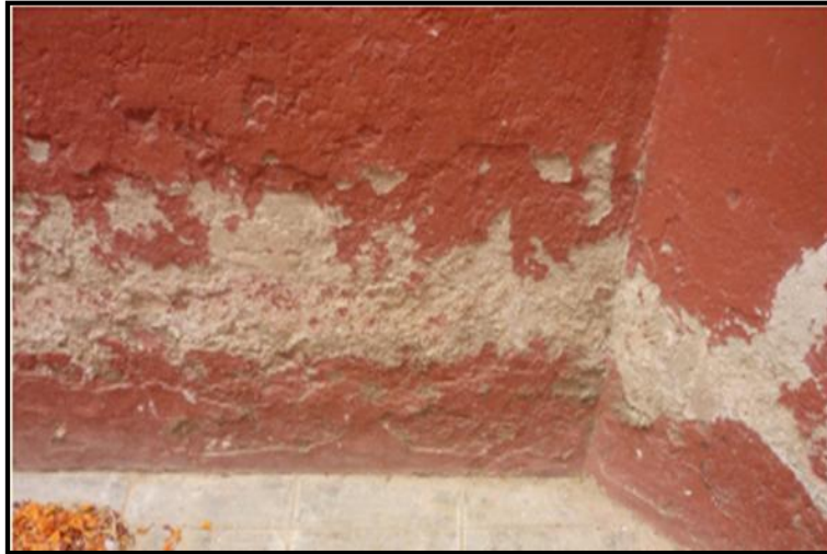
Figura 1. Presencia de eflorescencia en el sobrecimiento de la unidad de muestra 11 de la I.E. La Alborada. Nota: Alvarado (2011).
