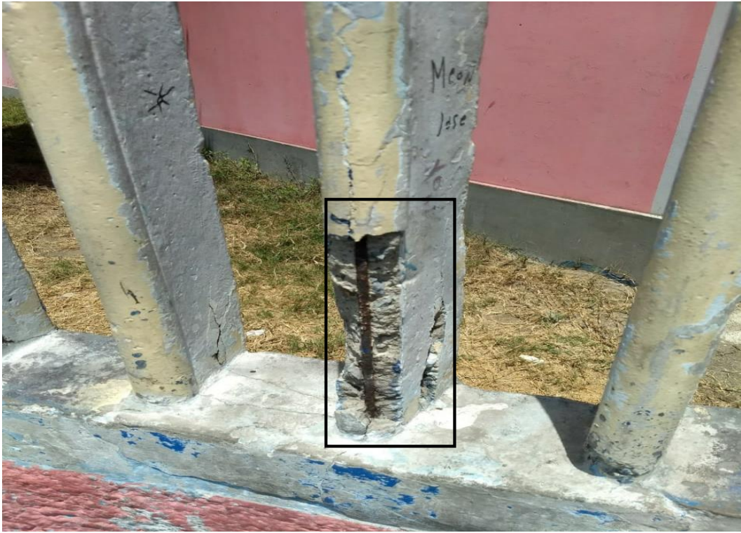
Fotografía N°10: Muros afectado por la Corrosión en la unidad muestral N°02.
