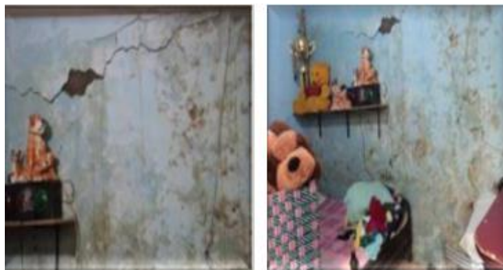
Figura 1: Patología por humedad o eflorescencia. Nota: Fuente: Guarnizo R. (2015).
