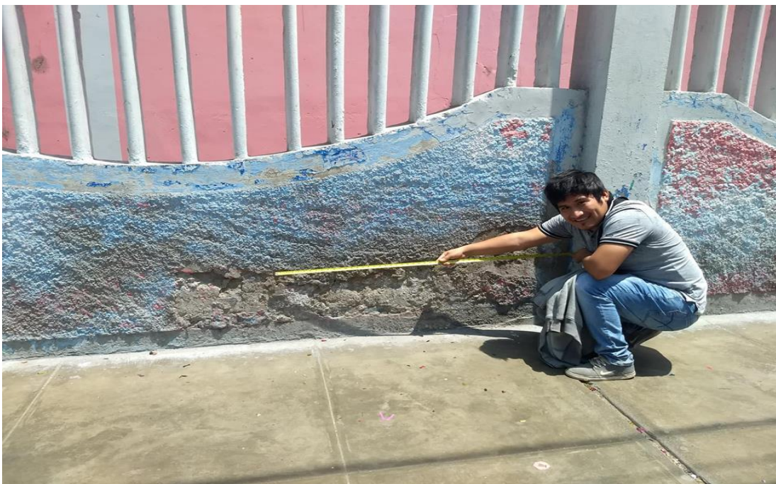
Fotografía N°15: Midiendo la Erosión que afecta el muro en la unidad de muestral N° 05.
