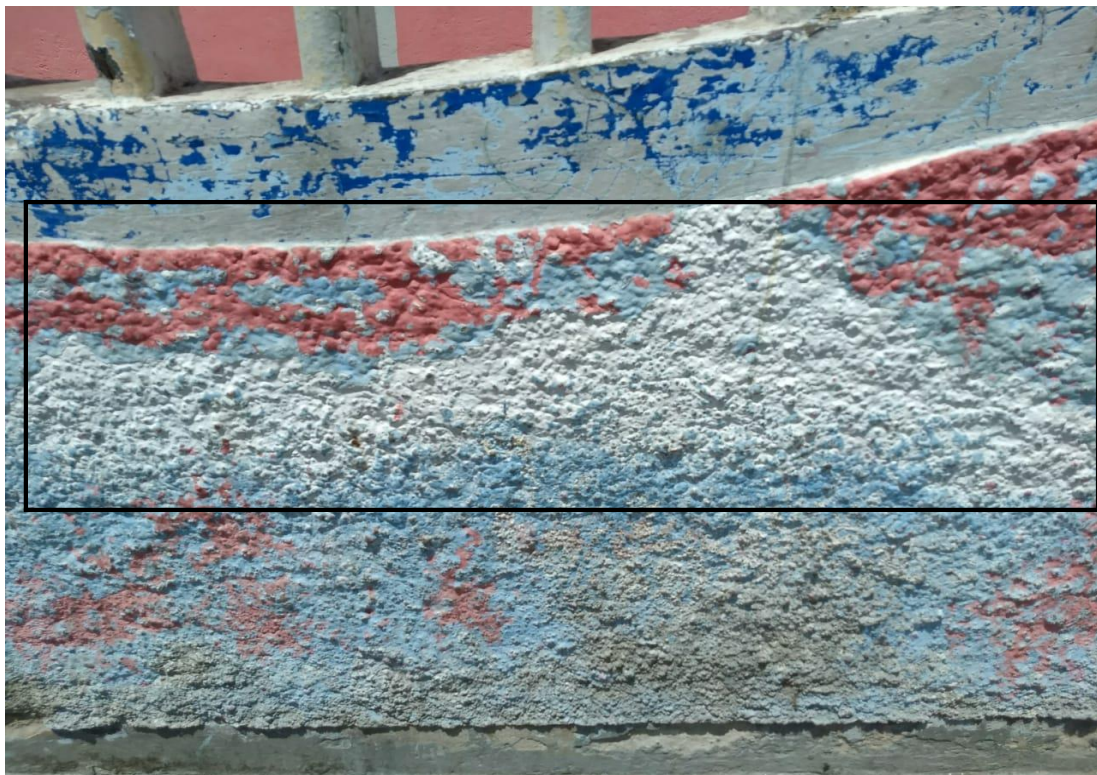
Fotografía N°05: Muros afectados por la Eflorescencia en la unidad muestral N°07.
