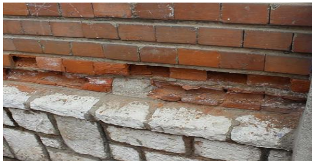
Figura 18: Erosión en muro de albañilería debido a la humedad. Nota: Fuente: Peña C. (2017)
