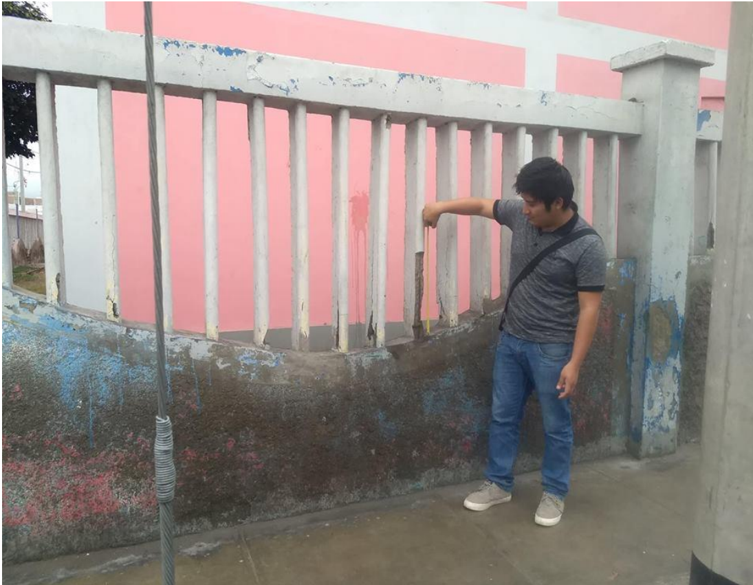
Fotografía N°14: Midiendo la Corrosión que afecta el muro en la unidad de muestral N° 06.
