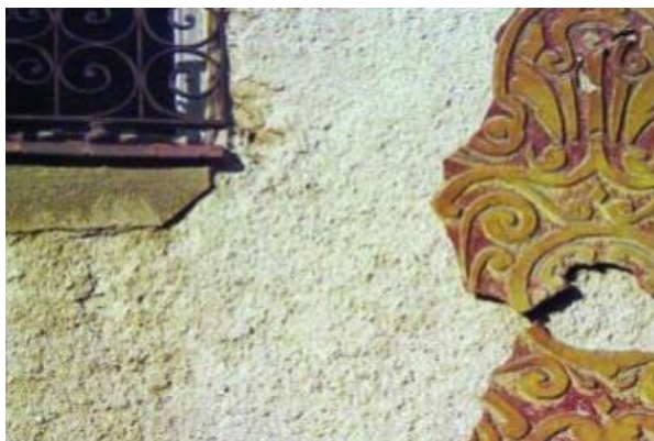
Figura 20: Perdida de la capa exterior del revoco de fachada Nota. Fuente: Broto, C. (2006).
