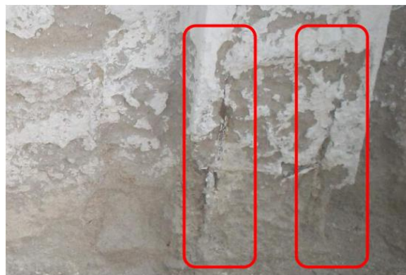
Figura 6: Oxidación en columna de cerco perimétrico de la Pesquera Bethel S.A. Nota: Fuente: León Q. (2016).
