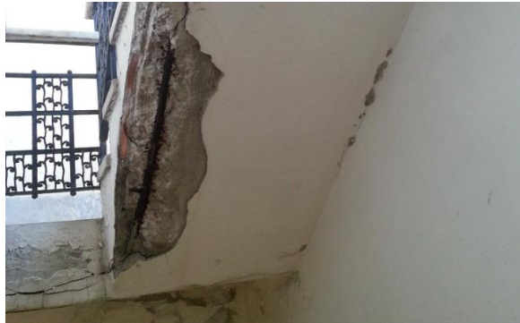
Figura 17: Daños en la Estructura de Concreto Nota: Fuente: Struc (2017).
