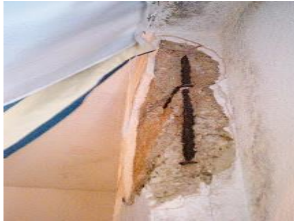
Figura 22: Efectos de la corrosión en el concreto armado Nota. Fuente: Moreno J. (2013).
