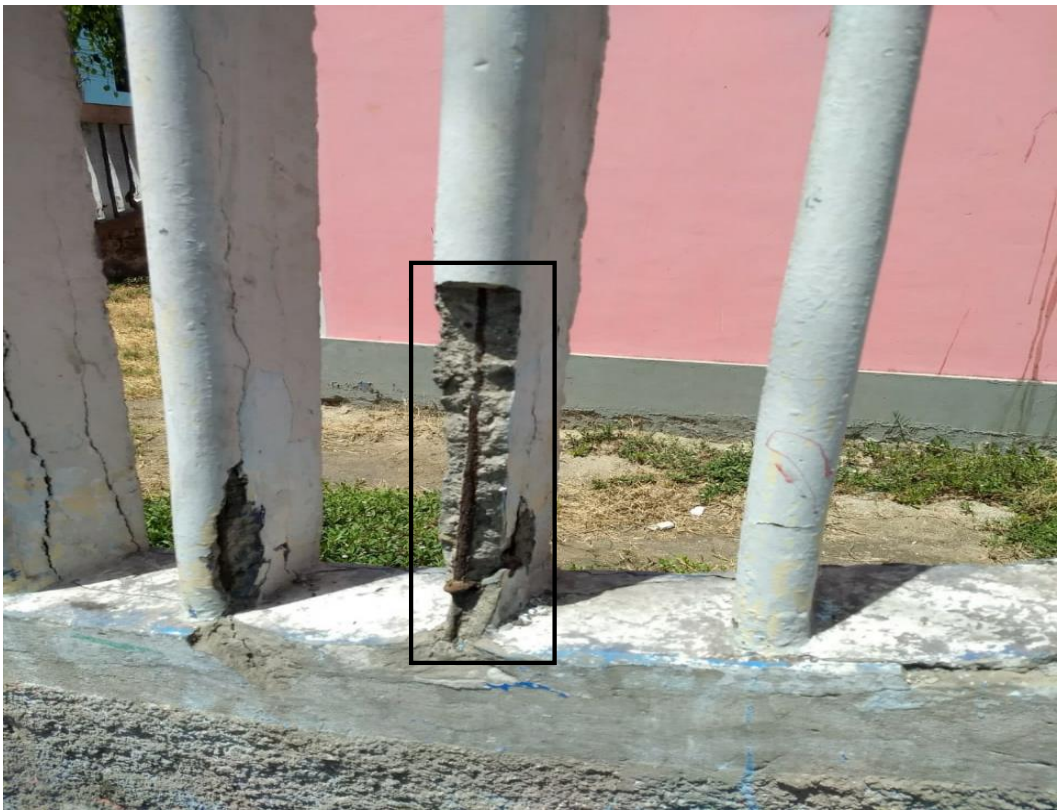
Fotografía N°11: Muros afectado por la Corrosión en la unidad muestral N°06.
