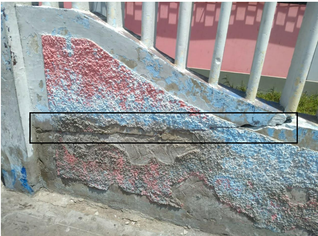
Fotografía N°13: Muros afectado por la Grieta en la unidad muestral N°12.
