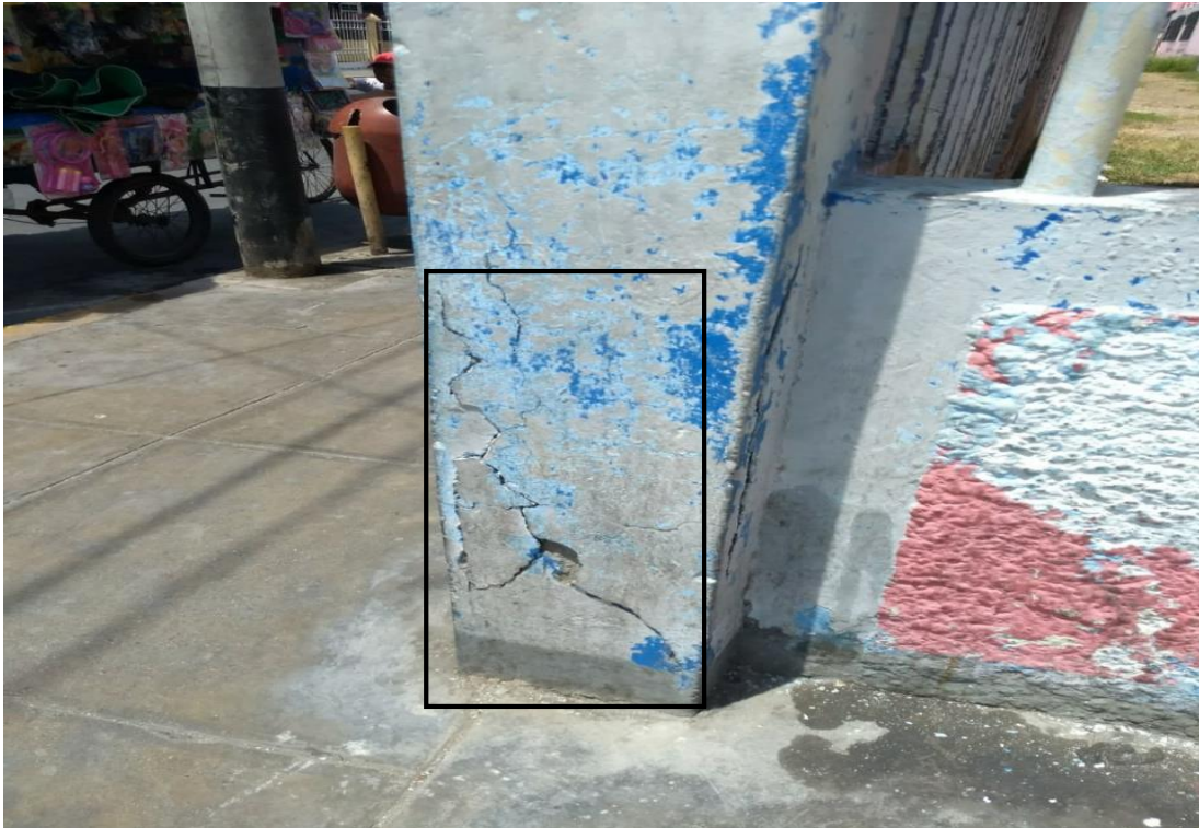
Fotografía N°12: Muros afectado por la Grieta en la unidad muestral N°07.
