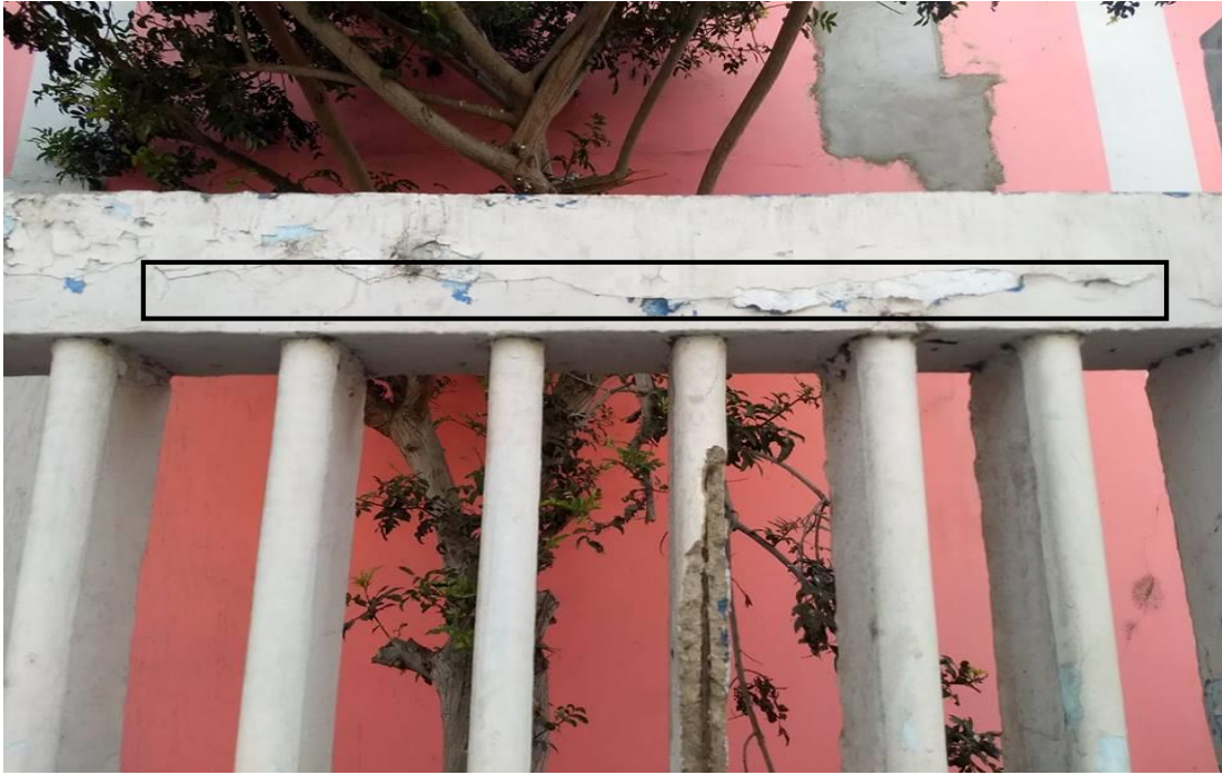
Fotografía N°06: Viga afectado por la Fisura en la unidad muestral N°06.
