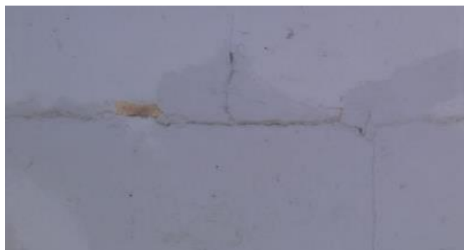
Fisura 19: Aparición de fisuras sobre el acabado producto de esfuerzos mecánicos. Nota. Fuente: Ibáñez, R. (2016).
