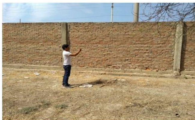
Figura 5: Presencia de erosión en el muro del tramo lateral izquierdo del cerco perimétrico de la Universidad de Piura. Nota: Fuente: Valdiviezo G. (2017).
