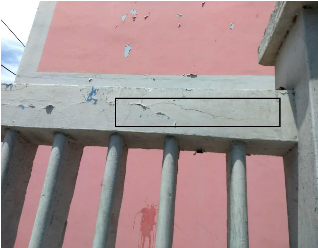
Fotografía N°07: Viga afectado por la Fisura en la unidad muestral N°06.
