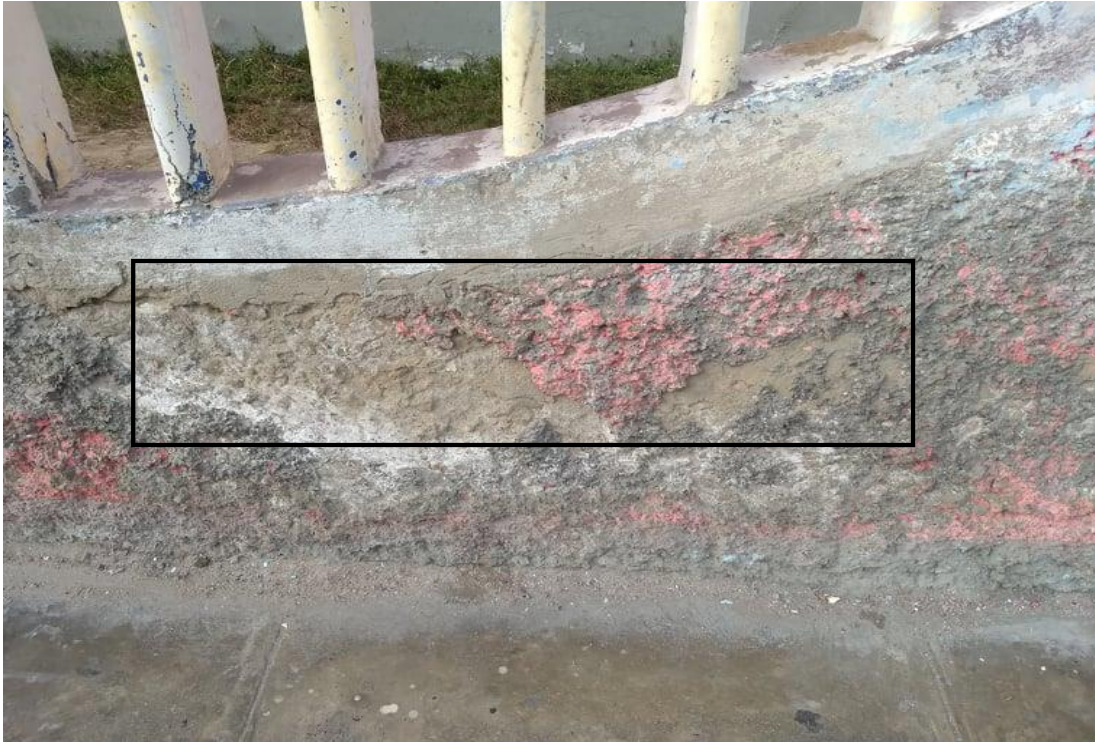
Fotografía N°08: Muros afectado por la Erosión en la unidad muestral N°09.
