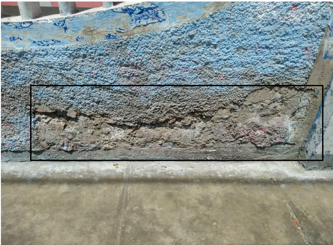
Fotografía N°09: Muros afectado por la Erosión en la unidad muestral N°05.
