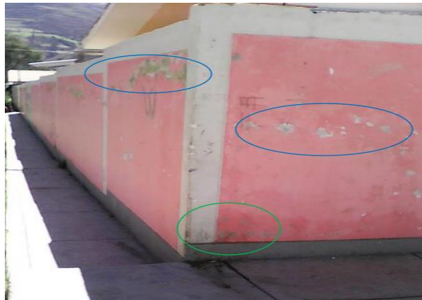
Figura 4: Se muestra las siguientes patologías: descascaramiento, suciedad. Nota: Fuente: Paucar A. (2017).
